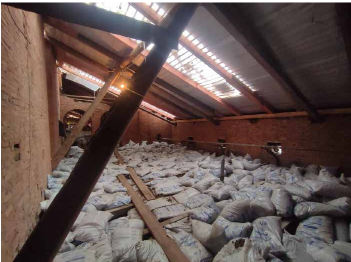
43. Объект культурного наследия регионального значения «Главный корпус Волковской богадельни», расположенный по адресу: г. Санкт-Петербург, набережная реки Волковки, дом 3, литера А. Фрагмент стропильной системы крыши в восточной части здания.
