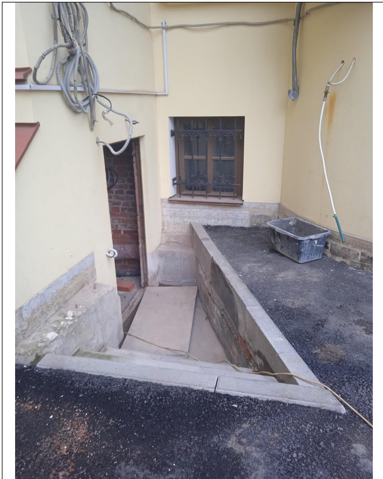
6. Дом Боткина М.П. Вид приямка по дворовому фасаду, через который осуществляется вход в цокольный этаж.
