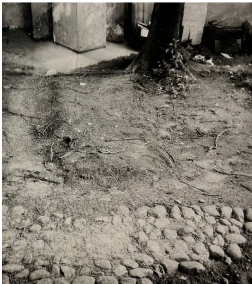
Илл. 59. Клен разрушает цоколь ограды. 1979 г.
