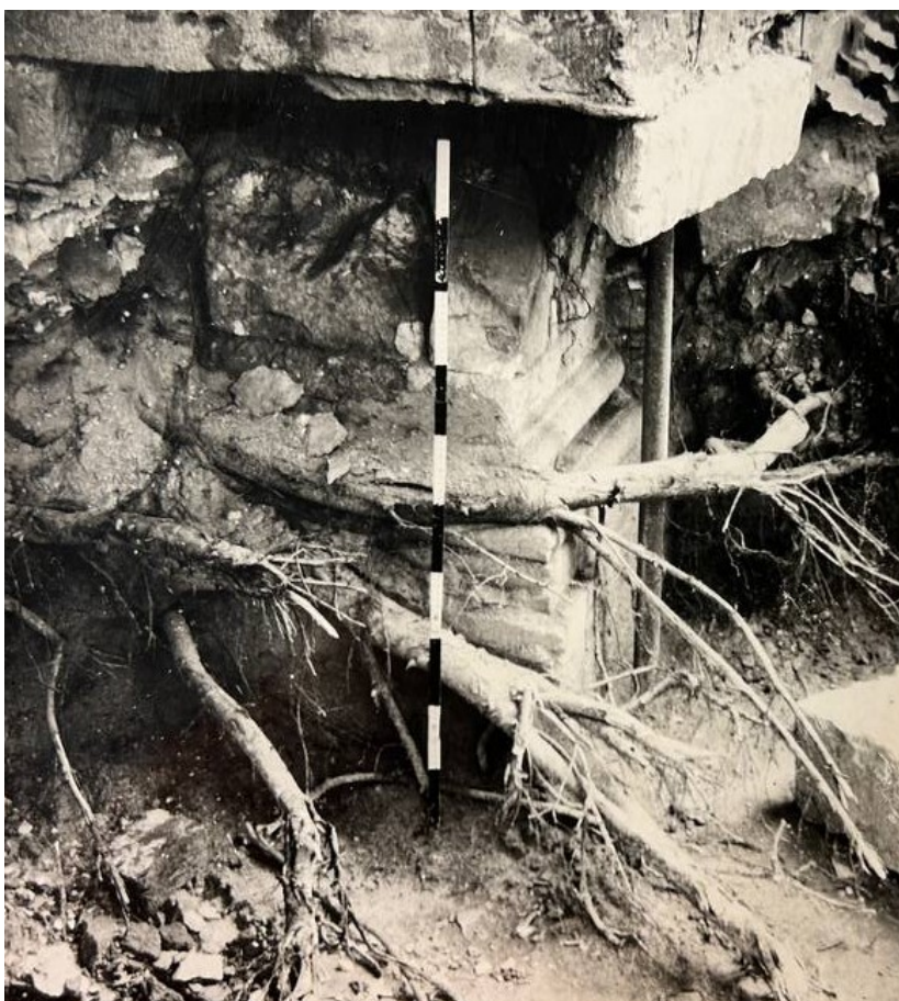
Илл. 60. Клен разрушает цоколь ограды и фундамент собора. 1979 г.
