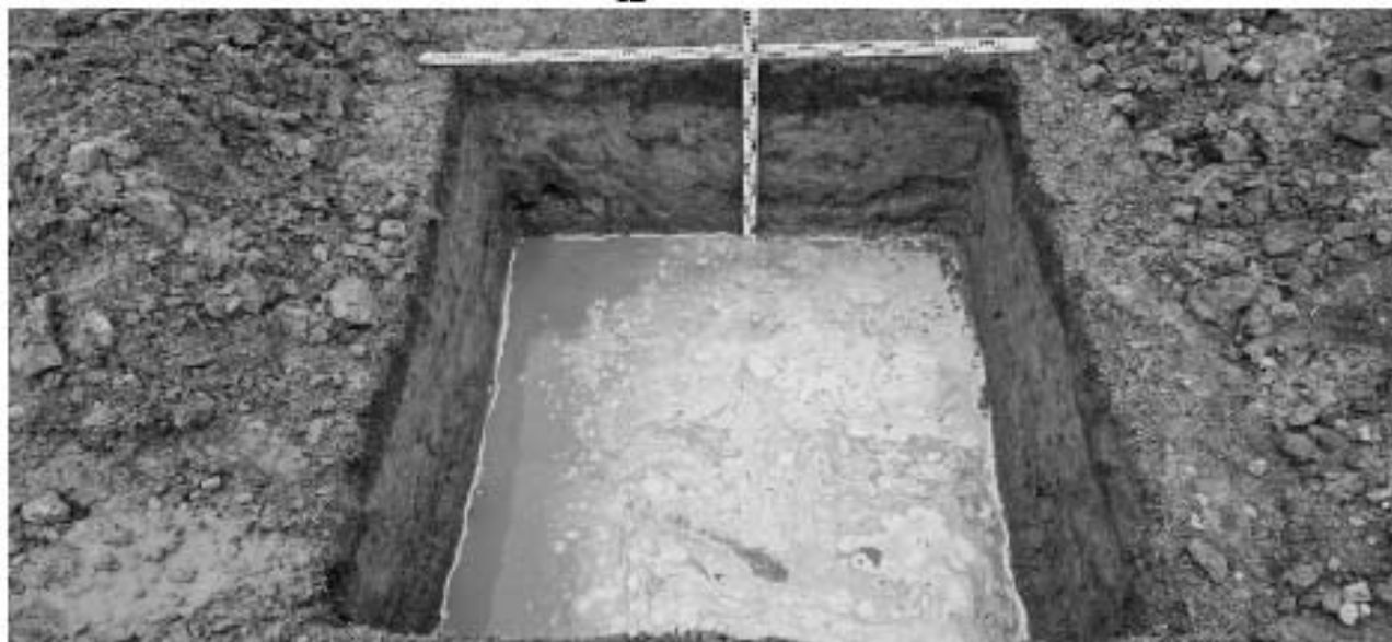
Рис.24. Санкт-Петербург, Красносельский р-н. ул. Десантников. Шурф №1. Фиксация по уровню грунтовых вод. Вид с запада.
