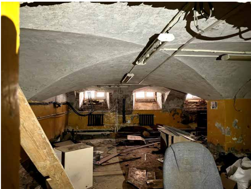
14. Объект культурного наследия регионального значения «Здание Коммерческого училища (с оградой)». Подвальное помещение. Вид в сторону оконных проёмов.
