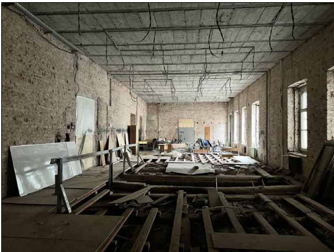
33. Объект культурного наследия регионального значения «Здание Коммерческого училища (с оградой)». 2-й этаж. Помещение 2-го этажа центральной части здания.
