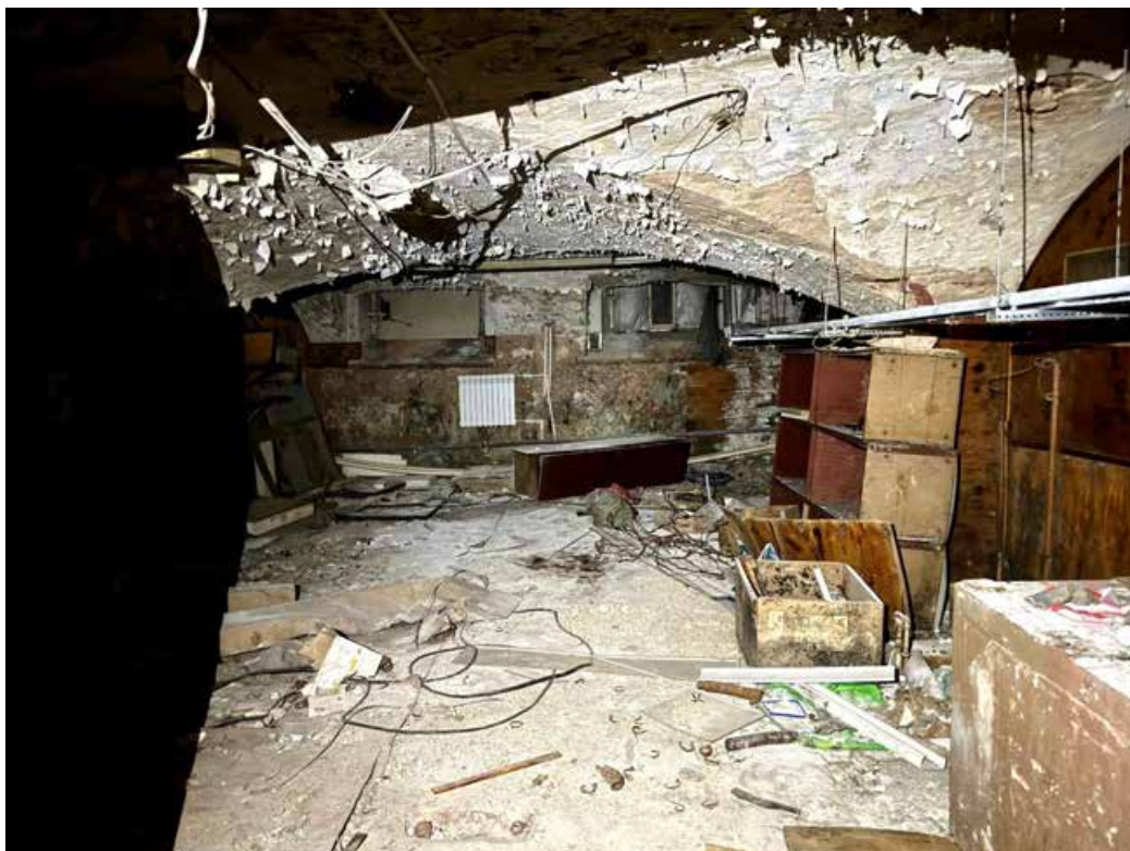
11. Объект культурного наследия регионального значения «Здание Коммерческого училища (с оградой)». Подвальное помещение. Вид в сторону оконных проёмов.
