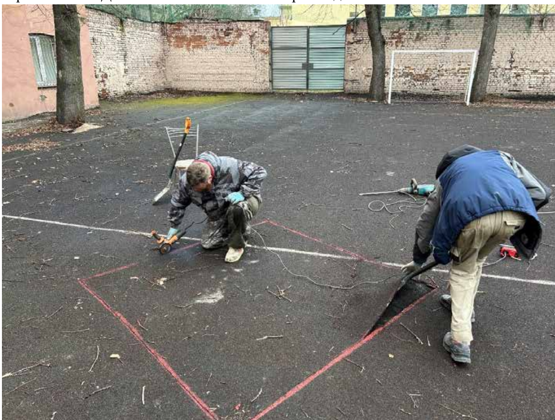
Ил. 29. Санкт-Петербург, Петроградский р-н ул. Мира, д. 18, литера А. Шурф 1. Рабочий момент. Снятие резинового покрытия. Вид с юго-востока.
