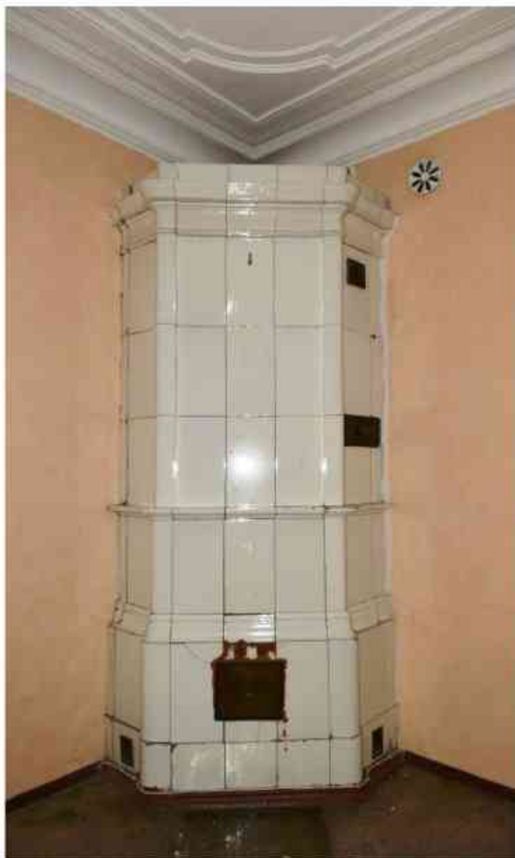
9. Вид на угловую печь в пом. 5
