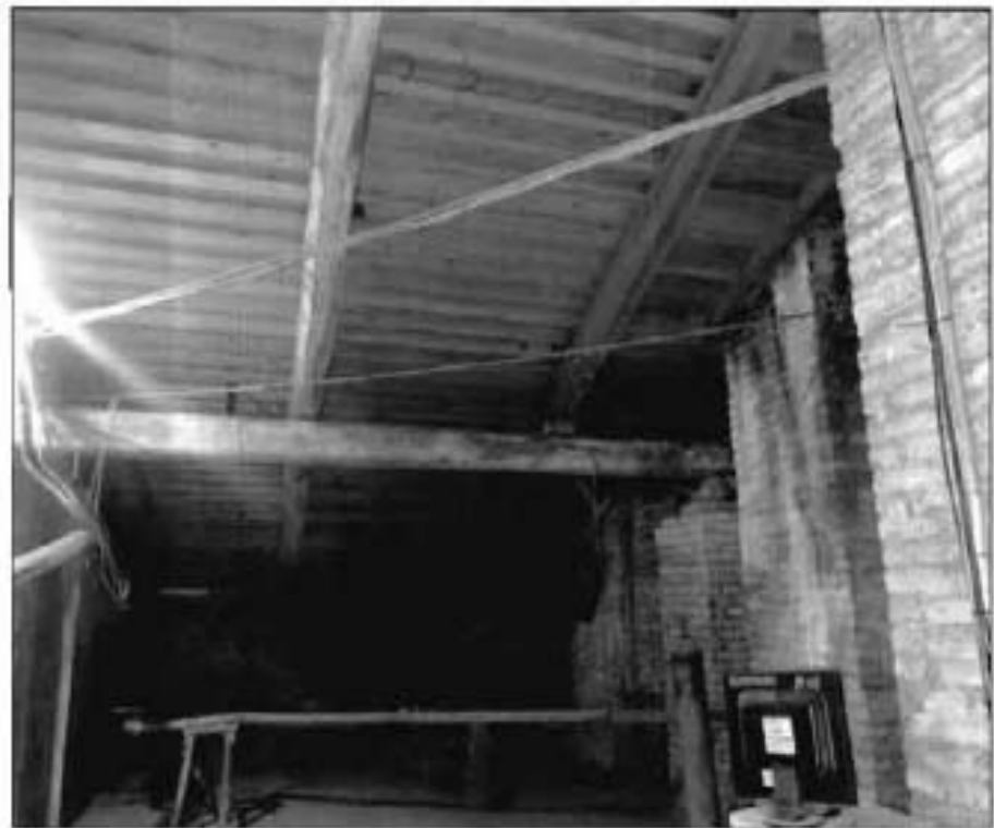
22. Стропильная система лицевого корпуса (со стороны пл. Ломоносова и ул. Зодчего Росси). Фото от 16.11.2021 г.
