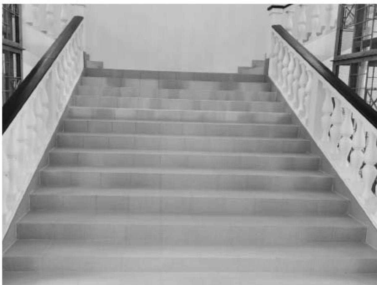
38. ОКНРЗ «Дворец пушкинъ». Интерьеры 5-го этажа. Фрагмент параллельной лестницы. Деревянные профилированные перила балюстрады. Историческое местоположение шахт лифта. Ограждение лифтовых шахт в виде металлических каркасов геометрического рисунка. 15.01.2024г.
