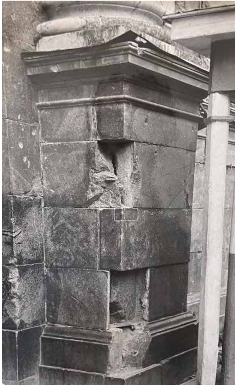
Илл. 21. Орловские ворота. Угол цоколя с южной стороны. Фото 1952 г. Архив КГИОП 226-37. Н-688.
