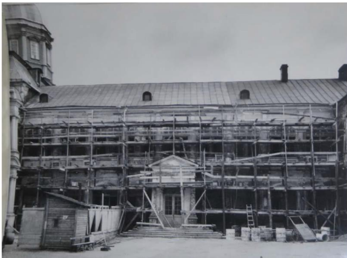
Илл. 53. Б. Духовская церковь в процессе фасадно-реставрационных работ 1950 года. Фотография. 1950 г. Неизвестный автор. // Архив КГИОП. П-155. (Фотоальбом А 847. Фото № 32578а).
