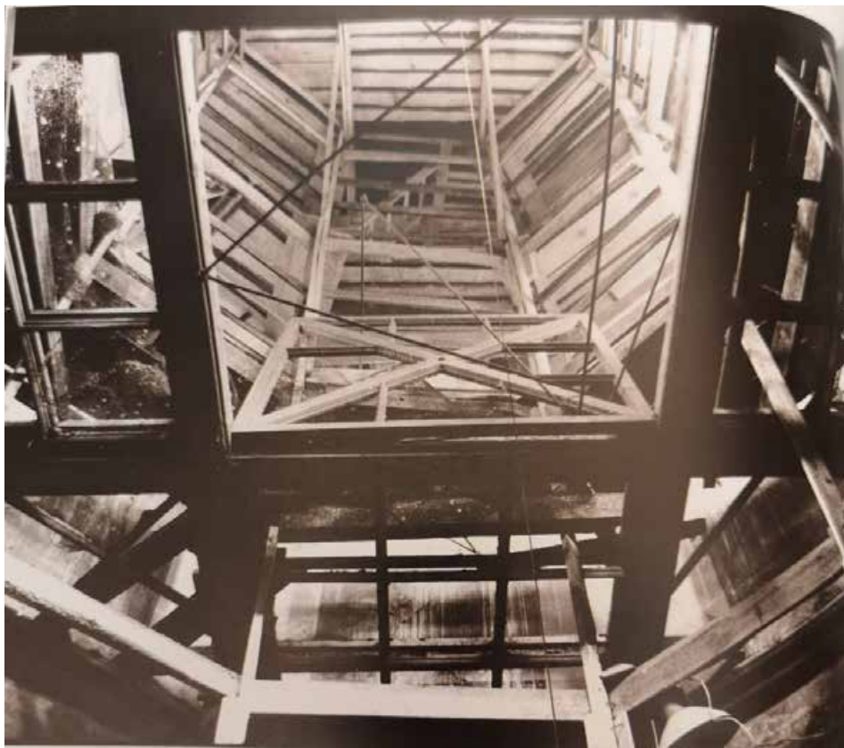
Илл. 115. Реставрационные работы в Благовещенские усыпальницы. Фото 1989 г. // Пирютко Ю. М., Алексеев А. А., Рытикова В. В. Благовещенская усыпальница: национальный пантеон России, памятник истории и культуры: к 300-летию основания Свято-Троицкой Александро-Невской лавры – СПб., Государственный музей городской скульптуры, 2013. (в работе использованы материалы фотоархива ГМГС.)
