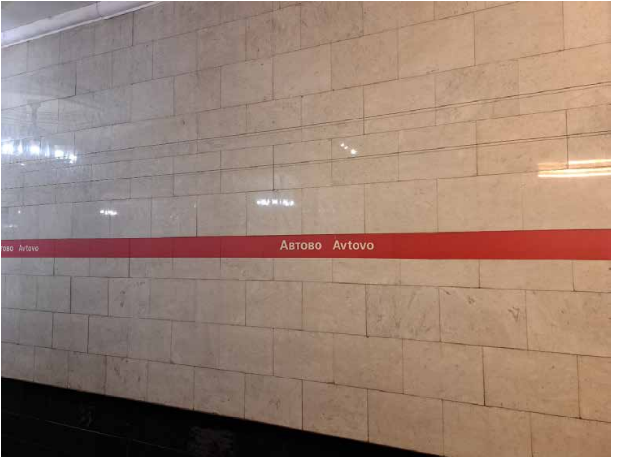
Фото №38. Путевая стена.
