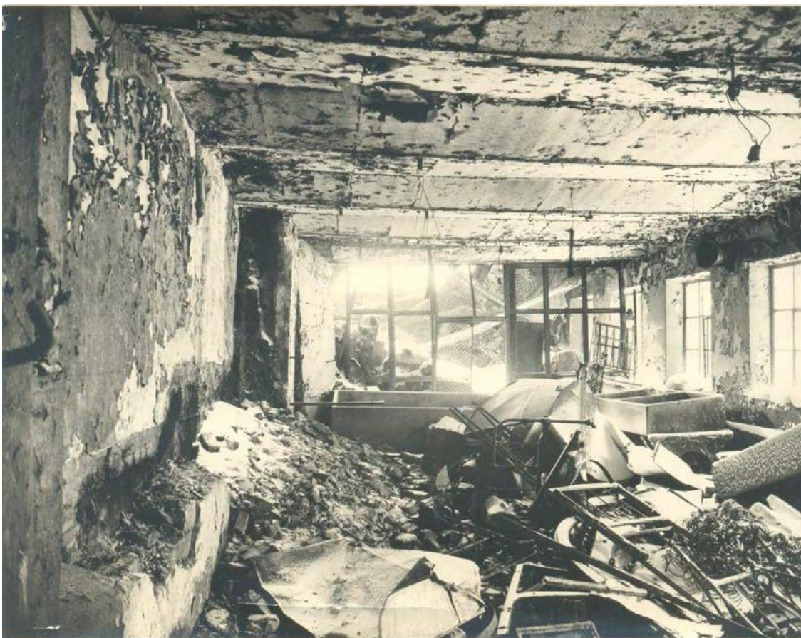
24. Разрушенное здание ЛФЭИ. Лестница №8. 1941 г. Электронный портал museum.finec.ru .
