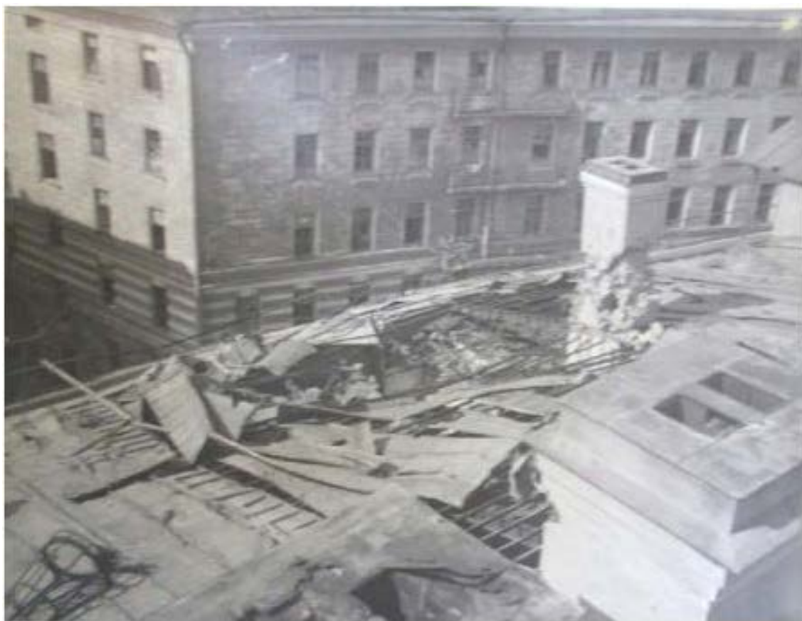
25. Разрушение крыши полуциркульной части памятника. Октябрь 1943 г. Следы разрушений. Акт обследования здания б. Госбанка. Ленинград. Архив КГИОП.
