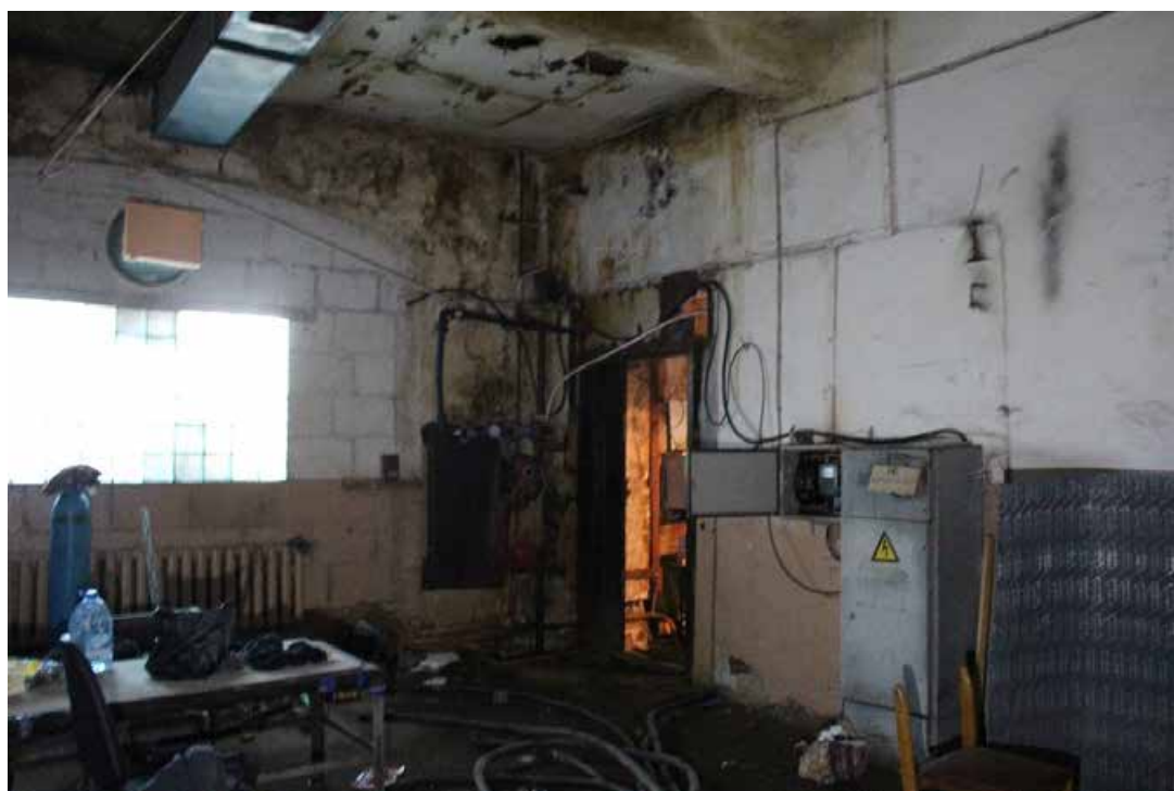
Фото 16. Здание по адресу: Санкт-Петербург, 17-я линия В.О., дом 54, корпус 5, литера Б объекта культурного наследия регионального значения «Блок цехов (с двумя трубами) и котельная с дымовой трубой». Внутренние помещения 1-го этажа.
