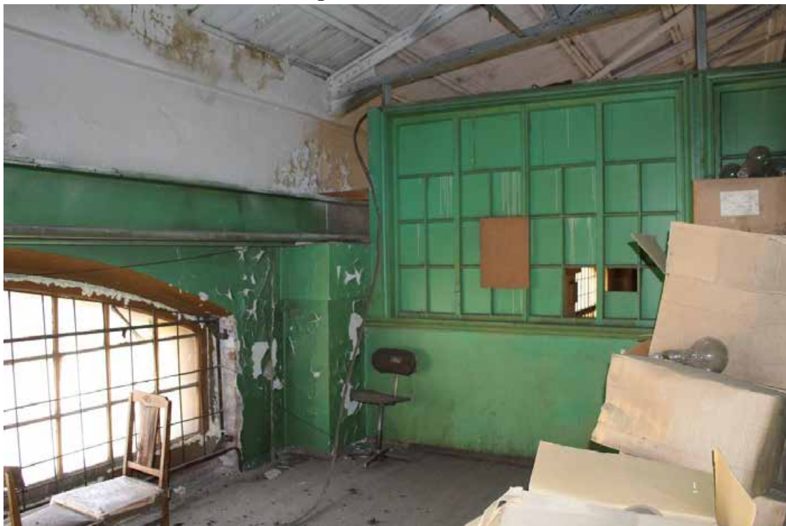
Фото 85. Здание по адресу: Санкт-Петербург, 17-я линия В.О., дом 54, корпус 5, литера Б объекта культурного наследия регионального значения «Блок цехов (с двумя трубами) и котельная с дымовой трубой». Внутренние помещения антресольного этажа.
