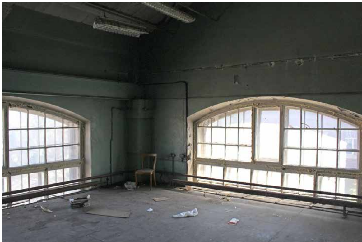
Фото 64. Здание по адресу: Санкт-Петербург, 17-я линия В.О., дом 54, корпус 5, литера Б объекта культурного наследия регионального значения «Блок цехов (с двумя трубами) и котельная с дымовой трубой». Внутренние помещения антресольного этажа.
