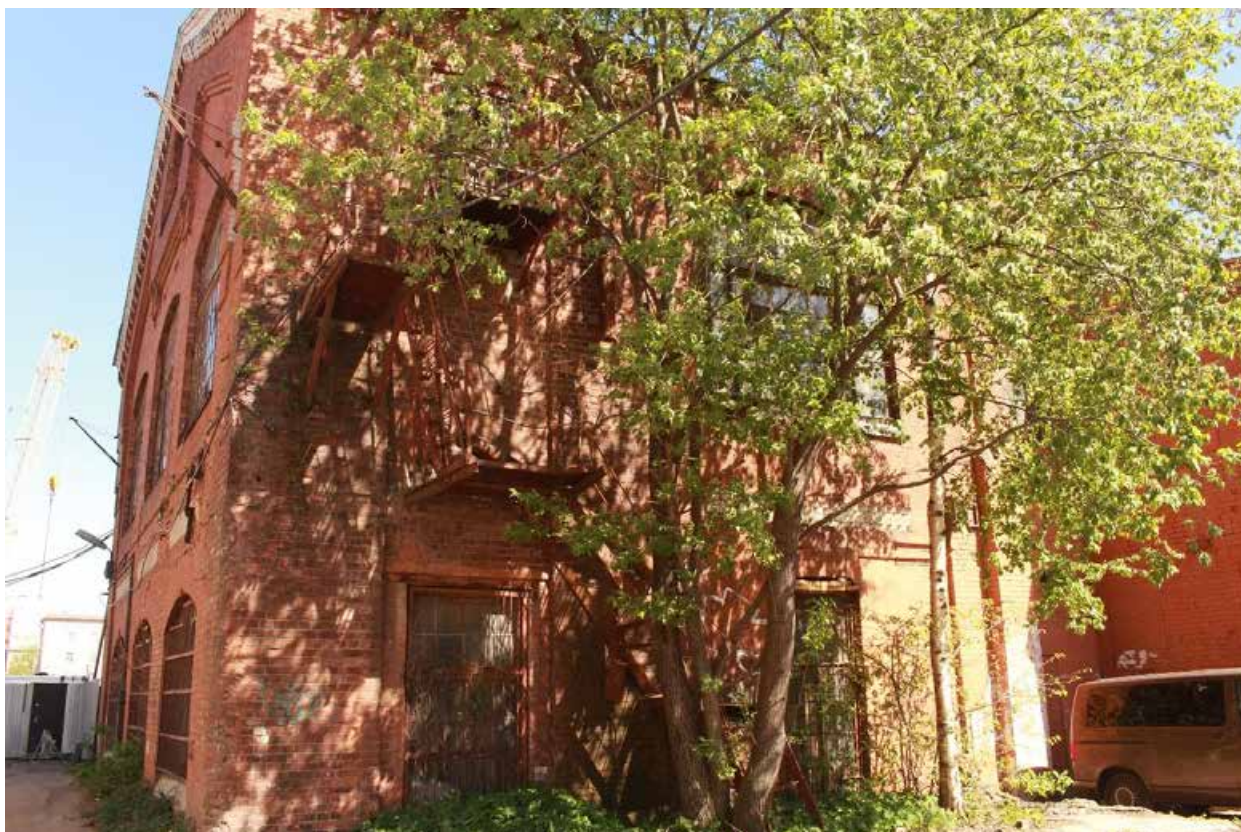
Фото 5. Фрагмент юго-западного фасада здания по адресу: Санкт-Петербург, 17-я линия В.О., дом 54, корпус 5, литера Б объекта культурного наследия регионального значения «Блок цехов (с двумя трубами) и котельная с дымовой трубой».
