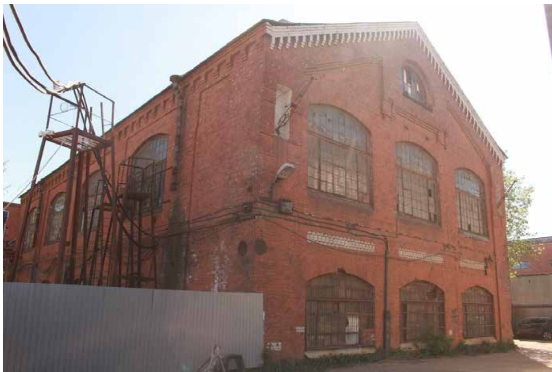
Фото 7. Вид на северо-западный фасад здания по адресу: Санкт-Петербург, 17-я линия В.О., дом 54, корпус 5, литера Б объекта культурного наследия регионального значения «Блок цехов (с двумя трубами) и котельная с дымовой трубой».
