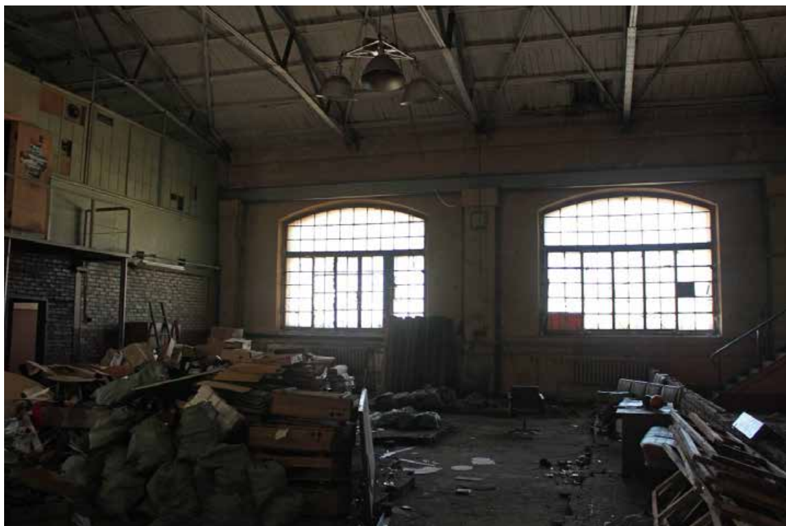
Фото 51. Здание по адресу: Санкт-Петербург, 17-я линия В.О., дом 54, корпус 5, литера Б объекта культурного наследия регионального значения «Блок цехов (с двумя трубами) и котельная с дымовой трубой». Внутренние помещения 2-го этажа.
