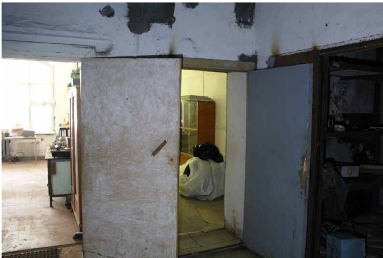
Фото 19. Здание по адресу: Санкт-Петербург, 17-я линия В.О., дом 54, корпус 5, литера Б объекта культурного наследия регионального значения «Блок цехов (с двумя трубами) и котельная с дымовой трубой». Внутренние помещения 1-го этажа.
