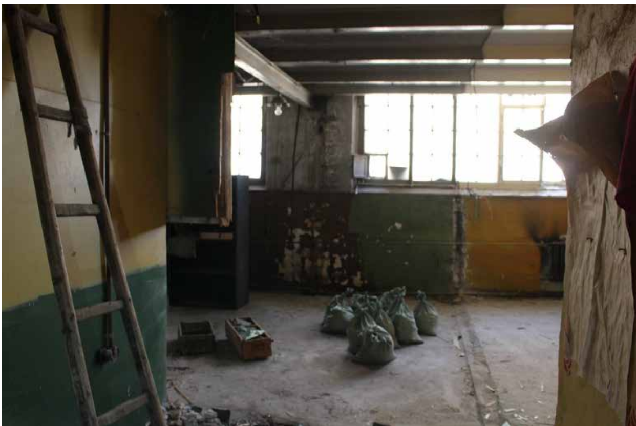
Фото 74. Здание по адресу: Санкт-Петербург, 17-я линия В.О., дом 54, корпус 5, литера Б объекта культурного наследия регионального значения «Блок цехов (с двумя трубами) и котельная с дымовой трубой». Внутренние помещения 2-го этажа.
