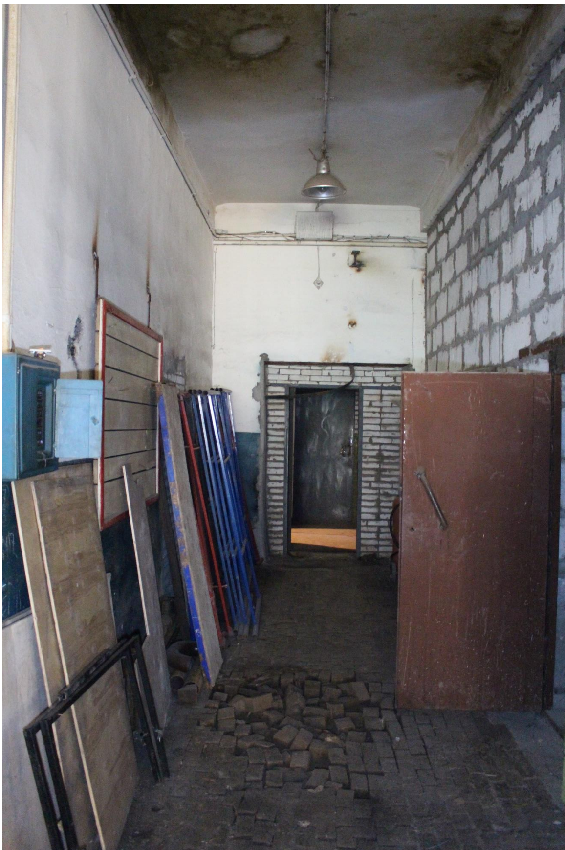
Фото 40. Здание по адресу: Санкт-Петербург, 17-я линия В.О., дом 54, корпус 5, литера Б объекта культурного наследия регионального значения «Блок цехов (с двумя трубами) и котельная с дымовой трубой». Внутренние помещения 1-го этажа.
