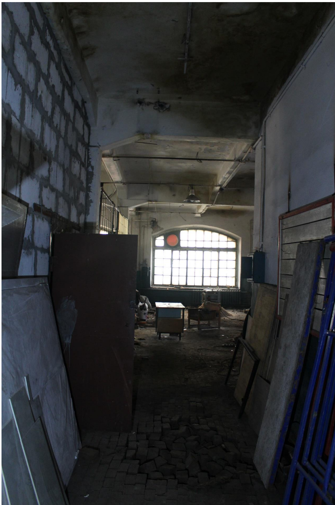
Фото 31. Здание по адресу: Санкт-Петербург, 17-я линия В.О., дом 54, корпус 5, литера Б объекта культурного наследия регионального значения «Блок цехов (с двумя трубами) и котельная с дымовой трубой». Внутренние помещения 1-го этажа.
