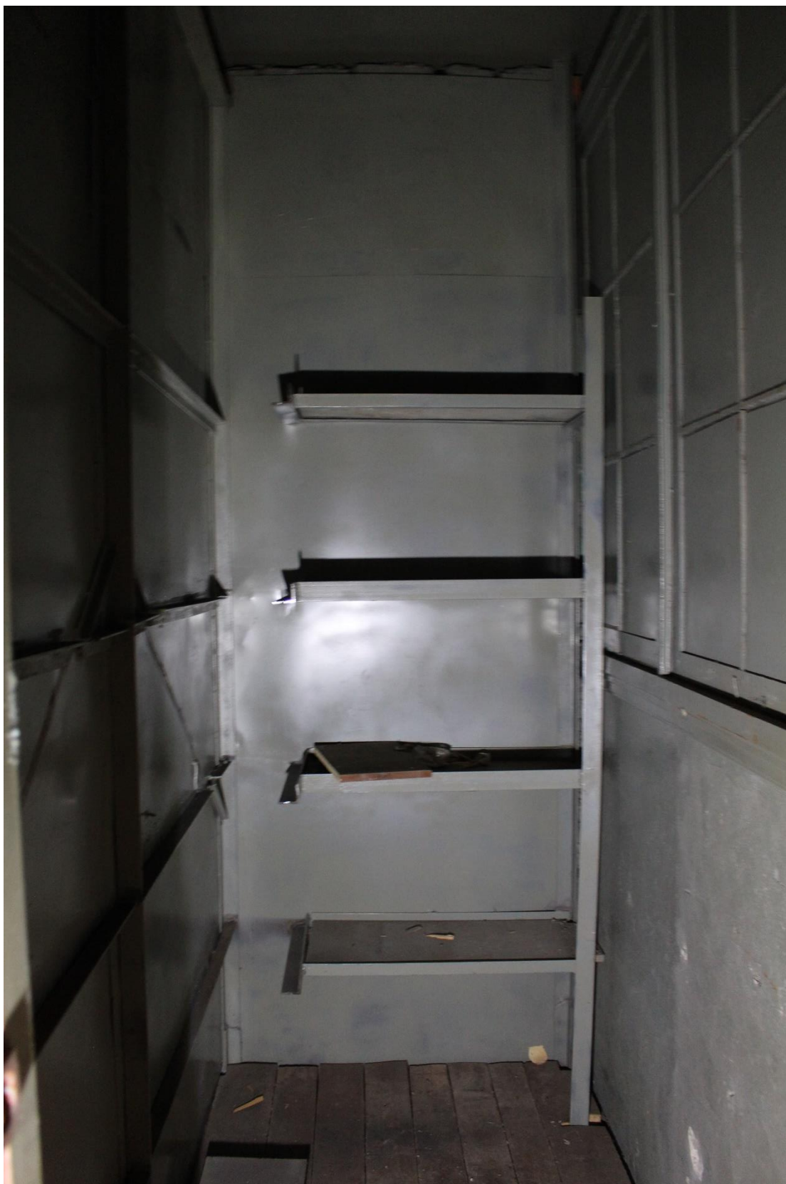
Фото 55. Здание по адресу: Санкт-Петербург, 17-я линия В.О., дом 54, корпус 5, литера Б объекта культурного наследия регионального значения «Блок цехов (с двумя трубами) и котельная с дымовой трубой». Внутренние помещения 2-го этажа.
