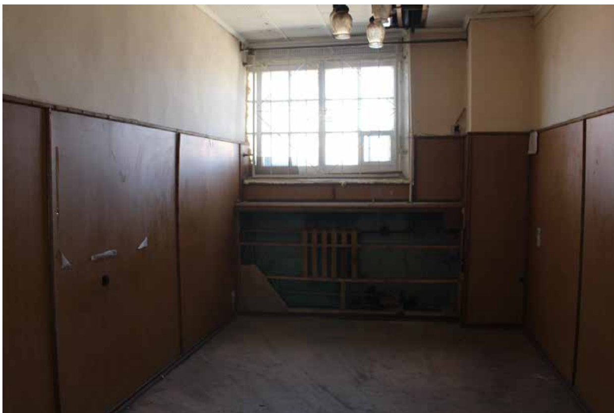
Фото 69. Здание по адресу: Санкт-Петербург, 17-я линия В.О., дом 54, корпус 5, литера Б объекта культурного наследия регионального значения «Блок цехов (с двумя трубами) и котельная с дымовой трубой». Внутренние помещения 2-го этажа.
