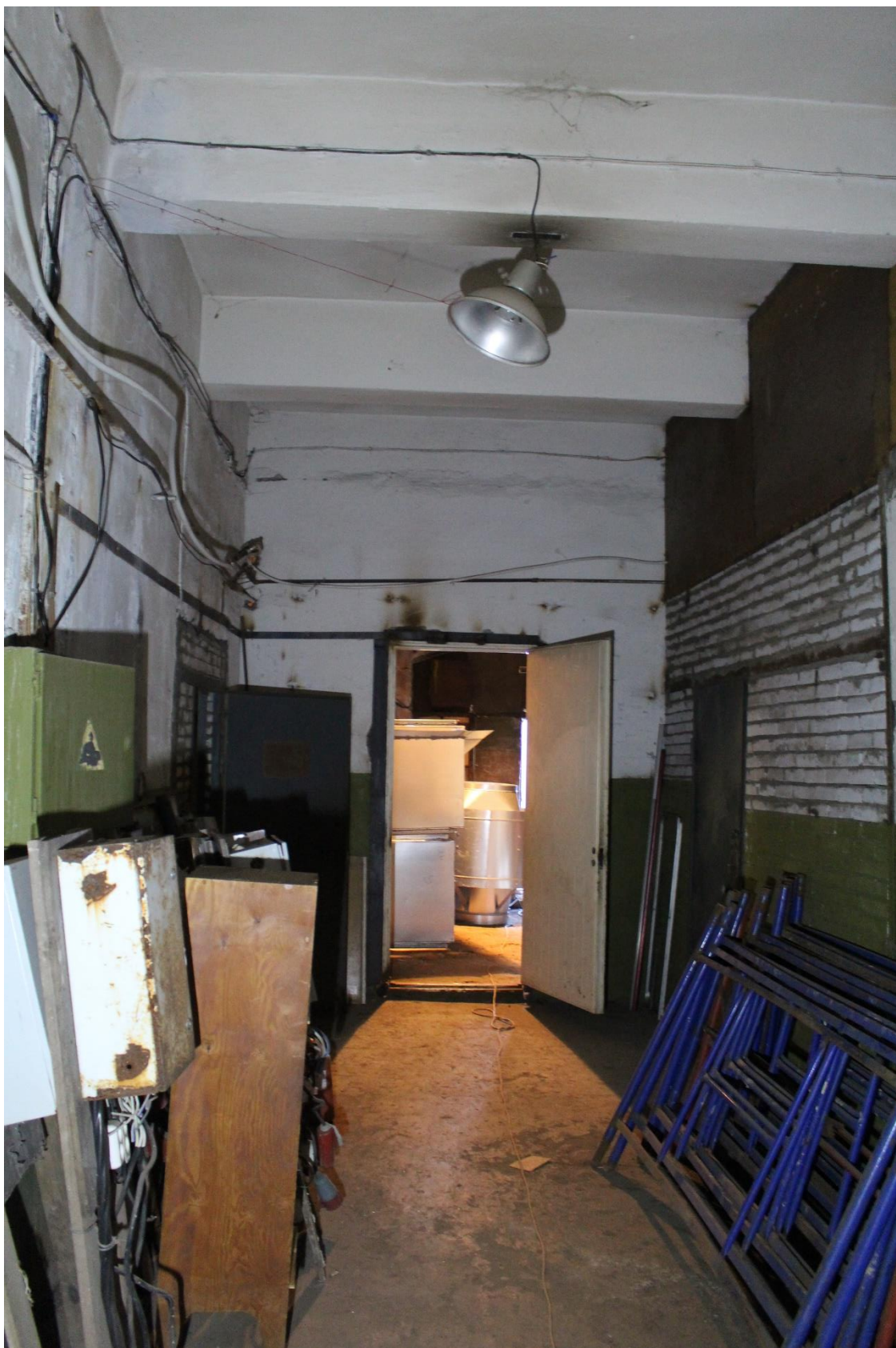
Фото 18. Здание по адресу: Санкт-Петербург, 17-я линия В.О., дом 54, корпус 5, литера Б объекта культурного наследия регионального значения «Блок цехов (с двумя трубами) и котельная с дымовой трубой». Внутренние помещения 1-го этажа.
