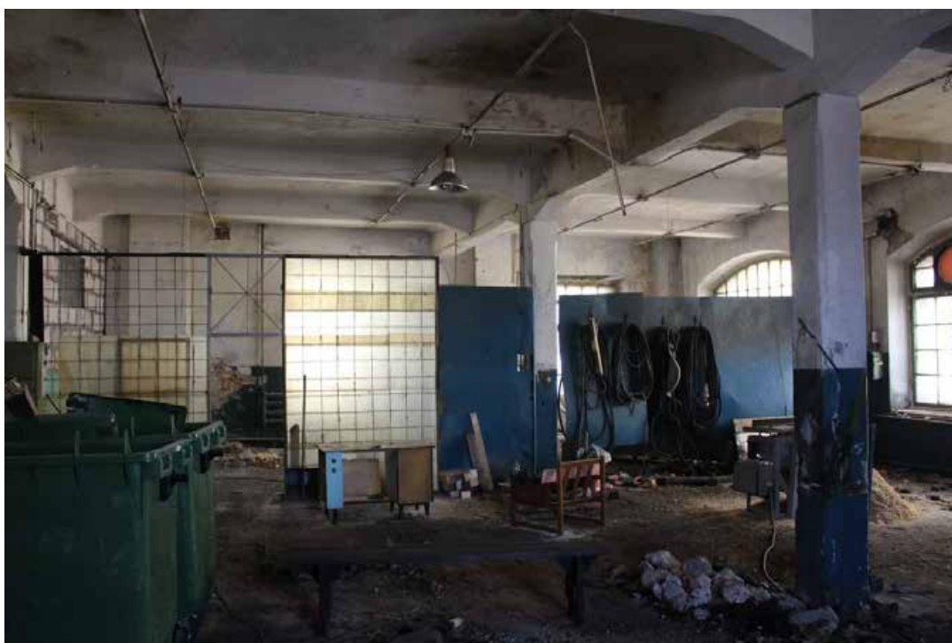
Фото 35. Здание по адресу: Санкт-Петербург, 17-я линия В.О., дом 54, корпус 5, литера Б объекта культурного наследия регионального значения «Блок цехов (с двумя трубами) и котельная с дымовой трубой». Внутренние помещения 1-го этажа.
