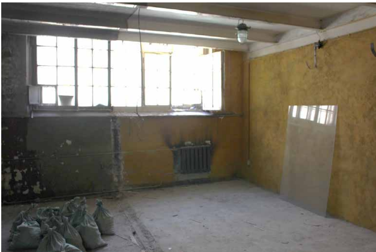
Фото 76. Здание по адресу: Санкт-Петербург, 17-я линия В.О., дом 54, корпус 5, литера Б объекта культурного наследия регионального значения «Блок цехов (с двумя трубами) и котельная с дымовой трубой». Внутренние помещения 2-го этажа.
