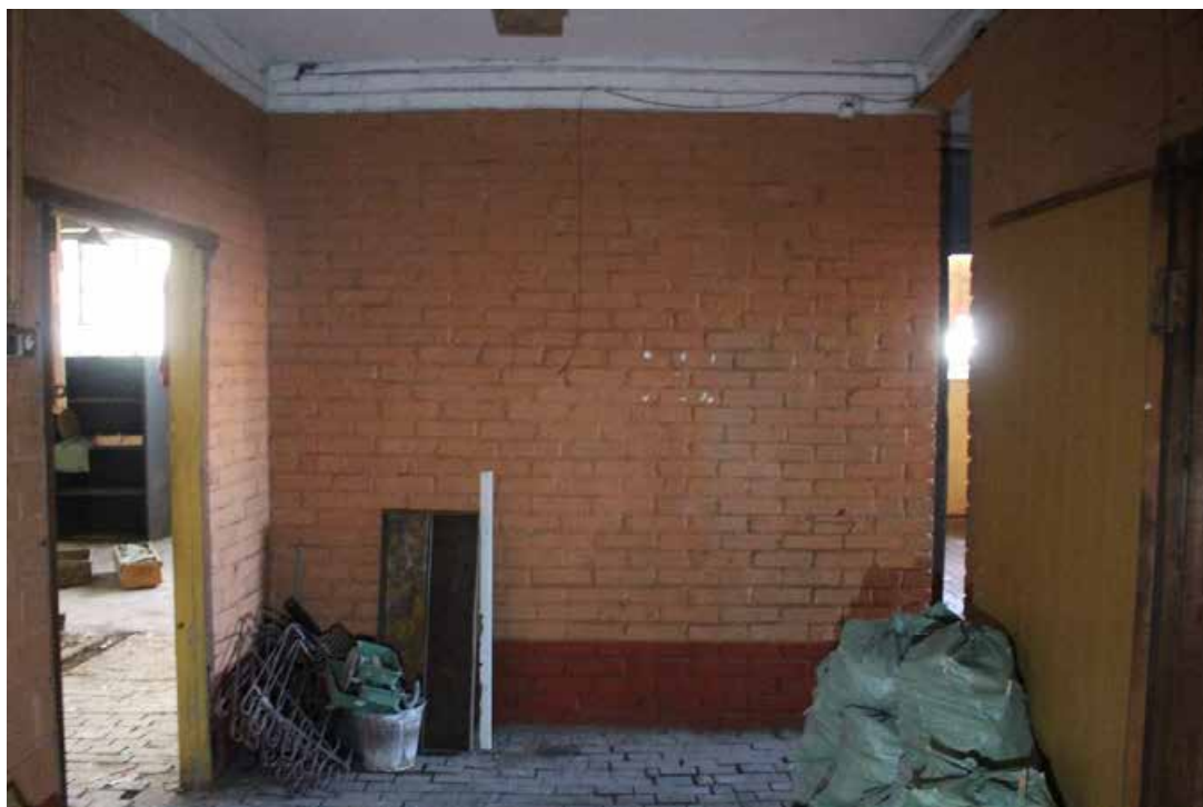
Фото 68. Здание по адресу: Санкт-Петербург, 17-я линия В.О., дом 54, корпус 5, литера Б объекта культурного наследия регионального значения «Блок цехов (с двумя трубами) и котельная с дымовой трубой». Внутренние помещения 2-го этажа.
