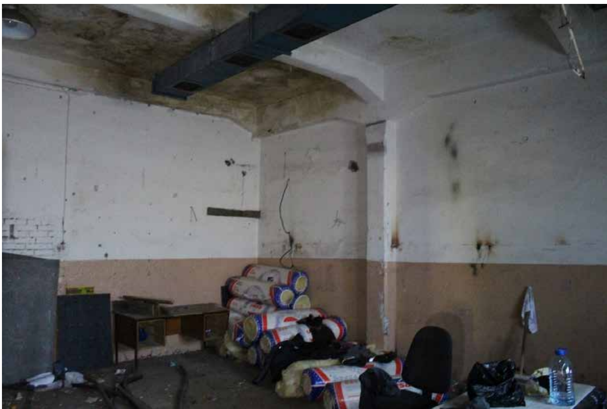
Фото 15. Здание по адресу: Санкт-Петербург, 17-я линия В.О., дом 54, корпус 5, литера Б объекта культурного наследия регионального значения «Блок цехов (с двумя трубами) и котельная с дымовой трубой». Внутренние помещения 1-го этажа.
