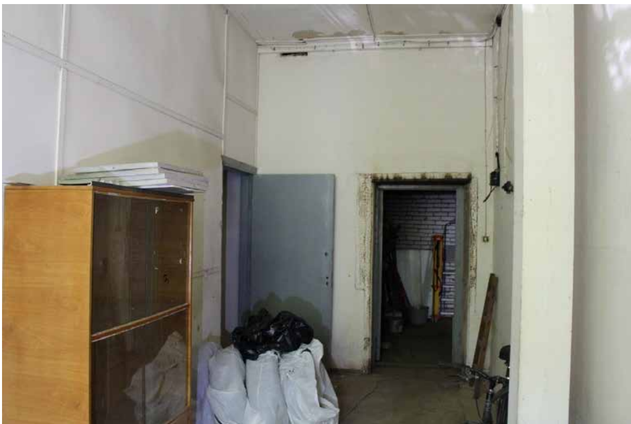
Фото 23. Здание по адресу: Санкт-Петербург, 17-я линия В.О., дом 54, корпус 5, литера Б объекта культурного наследия регионального значения «Блок цехов (с двумя трубами) и котельная с дымовой трубой». Внутренние помещения 1-го этажа.
