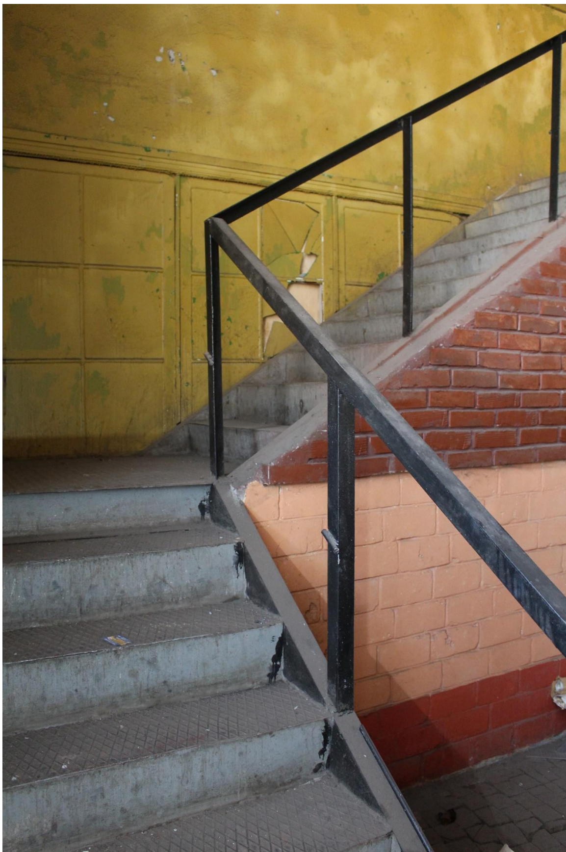
Фото 63. Здание по адресу: Санкт-Петербург, 17-я линия В.О., дом 54, корпус 5, литера Б объекта культурного наследия регионального значения «Блок цехов (с двумя трубами) и котельная с дымовой трубой». Вид на лестницу на антресольный этаж.
