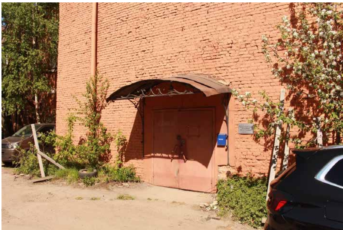
Фото 3. Фрагмент фасада пристройки к юго-западному фасаду здания по адресу: Санкт-Петербург, 17-я линия В.О., дом 54, корпус 5, литера Б объекта культурного наследия регионального значения «Блок цехов (с двумя трубами) и котельная с дымовой трубой».
