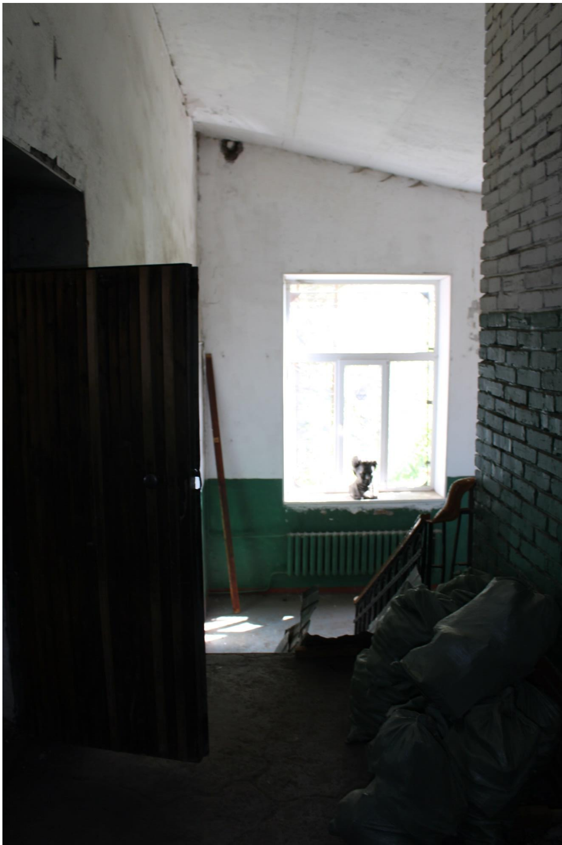
Фото 48. Здание по адресу: Санкт-Петербург, 17-я линия В.О., дом 54, корпус 5, литера Б объекта культурного наследия регионального значения «Блок цехов (с двумя трубами) и котельная с дымовой трубой». Вид на лестничную клетку в уровне 2-го этажа.
