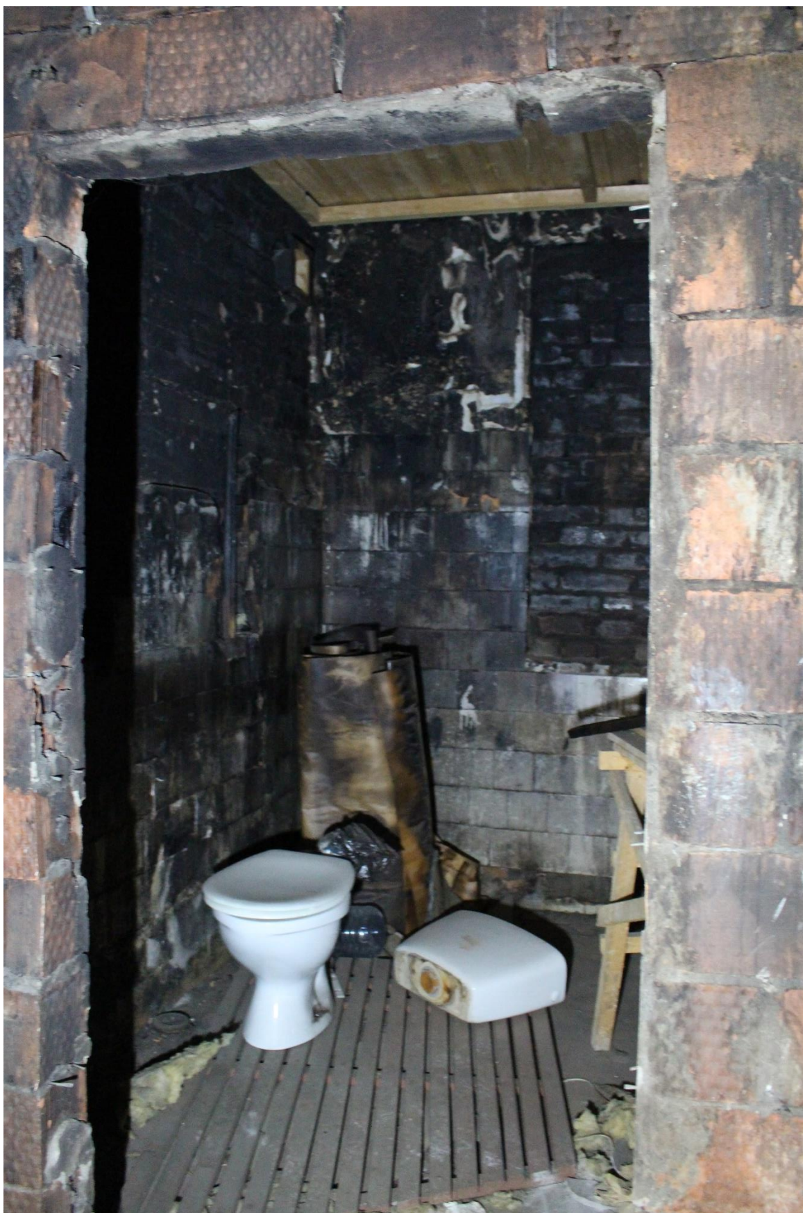
Фото 49. Здание по адресу: Санкт-Петербург, 17-я линия В.О., дом 54, корпус 5, литера Б объекта культурного наследия регионального значения «Блок цехов (с двумя трубами) и котельная с дымовой трубой». Внутренние помещения 2-го этажа.
