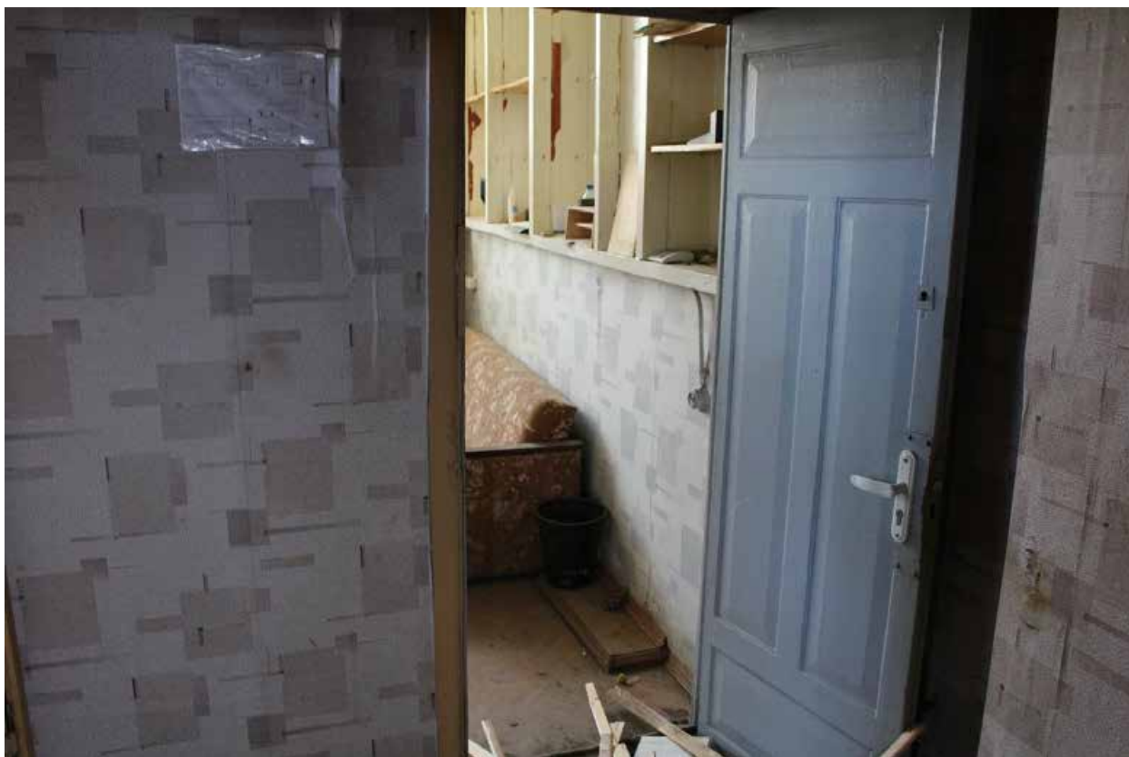
Фото 59. Здание по адресу: Санкт-Петербург, 17-я линия В.О., дом 54, корпус 5, литера Б объекта культурного наследия регионального значения «Блок цехов (с двумя трубами) и котельная с дымовой трубой». Внутренние помещения 2-го этажа.
