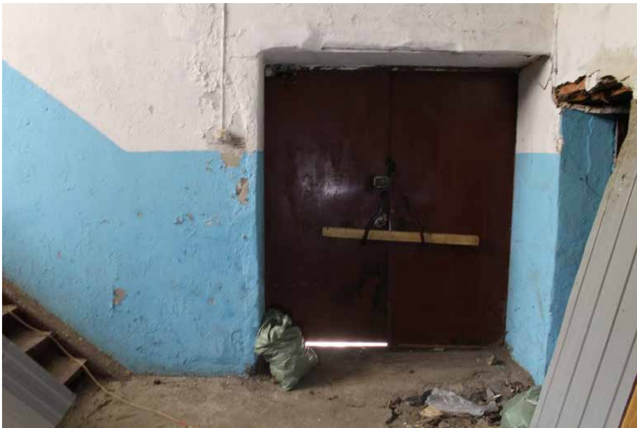
Фото 41. Здание по адресу: Санкт-Петербург, 17-я линия В.О., дом 54, корпус 5, литера Б объекта культурного наследия регионального значения «Блок цехов (с двумя трубами) и котельная с дымовой трубой». Внутренние помещения 1-го этажа.
