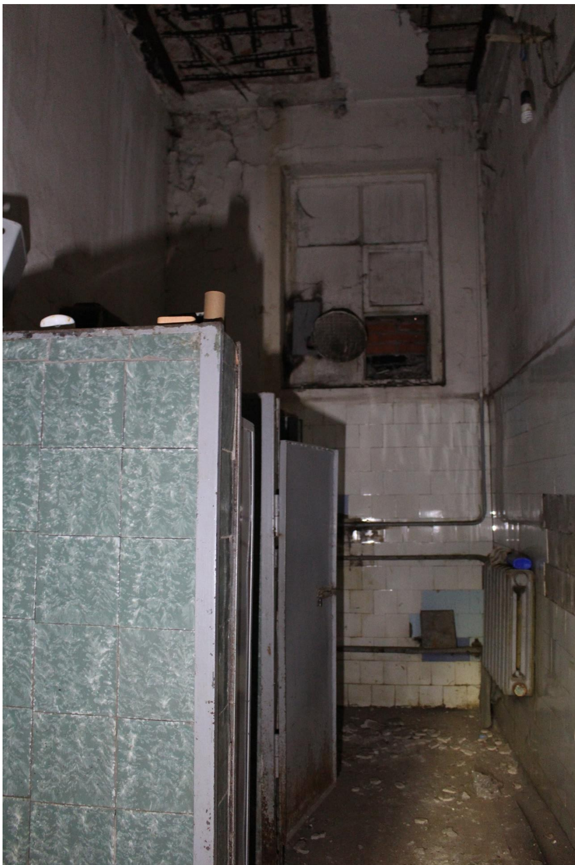
Фото 42. Здание по адресу: Санкт-Петербург, 17-я линия В.О., дом 54, корпус 5, литера Б объекта культурного наследия регионального значения «Блок цехов (с двумя трубами) и котельная с дымовой трубой». Внутренние помещения 1-го этажа.
