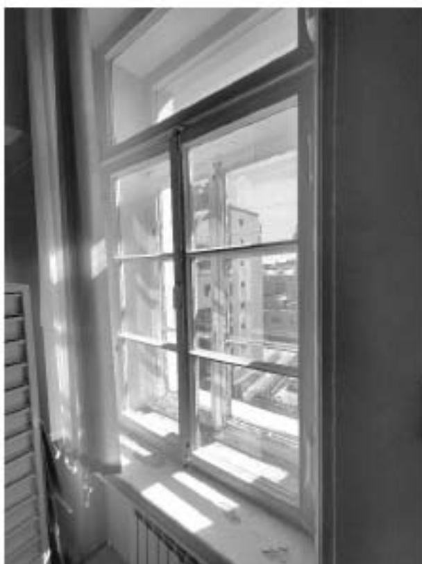
85. «Дом, где жили: в 1912-1936 гг. – путешественник Грум-Гржимайло Г.Е, в 1914-1922 гг. – певец Шаляпин Ф.И.», ул. Графтио, д. 26, лит. А. Пятый этаж. Помещение №108. Фрагмент. Фото 08.05.2024г.
