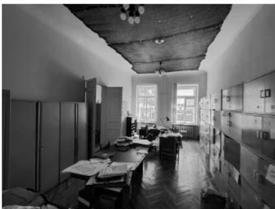
96. «Дом, где жили: в 1912-1936 гг. – путешественник Грум-Гржимайло Г.Е, в 1914-1922 гг. – певец Шаляпин Ф.И.», ул. Графтио, д. 26, лит. А. Пятый этаж. Помещение №106. Общий вид. Фото 08.05.2024г.
