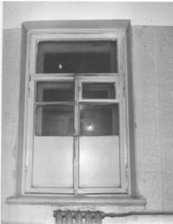
15. Пермская ул., 26, 3-й этаж. Северо-восточное окно светового колодца, освещающее Г-образный коридор. Вид с северо-востока. Ныне заложено. Фотофиксация. 1987 г. ЛФ Гипротейтр. Материал предоставлен заказчиком.
