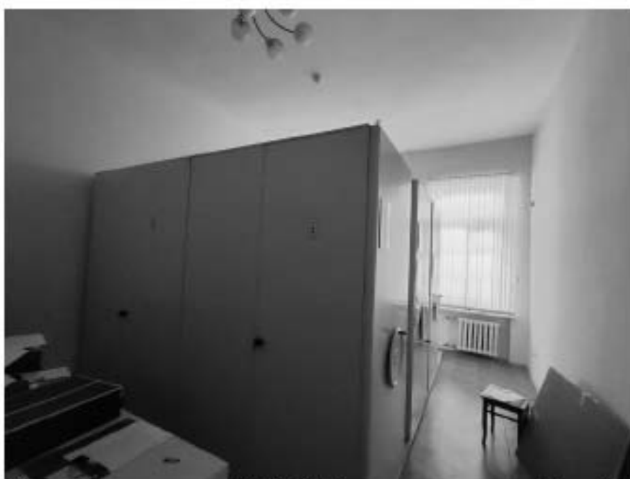
90. «Дом, где жили: в 1912-1936 гг. – путешественник Грум-Гржимайло Г.Е, в 1914-1922 гг. – певец Шаляпин Ф.И.», ул. Графтио, д. 26, лит. А. Пятый этаж. Помещение №97. Общий вид. Фото 08.05.2024г.
