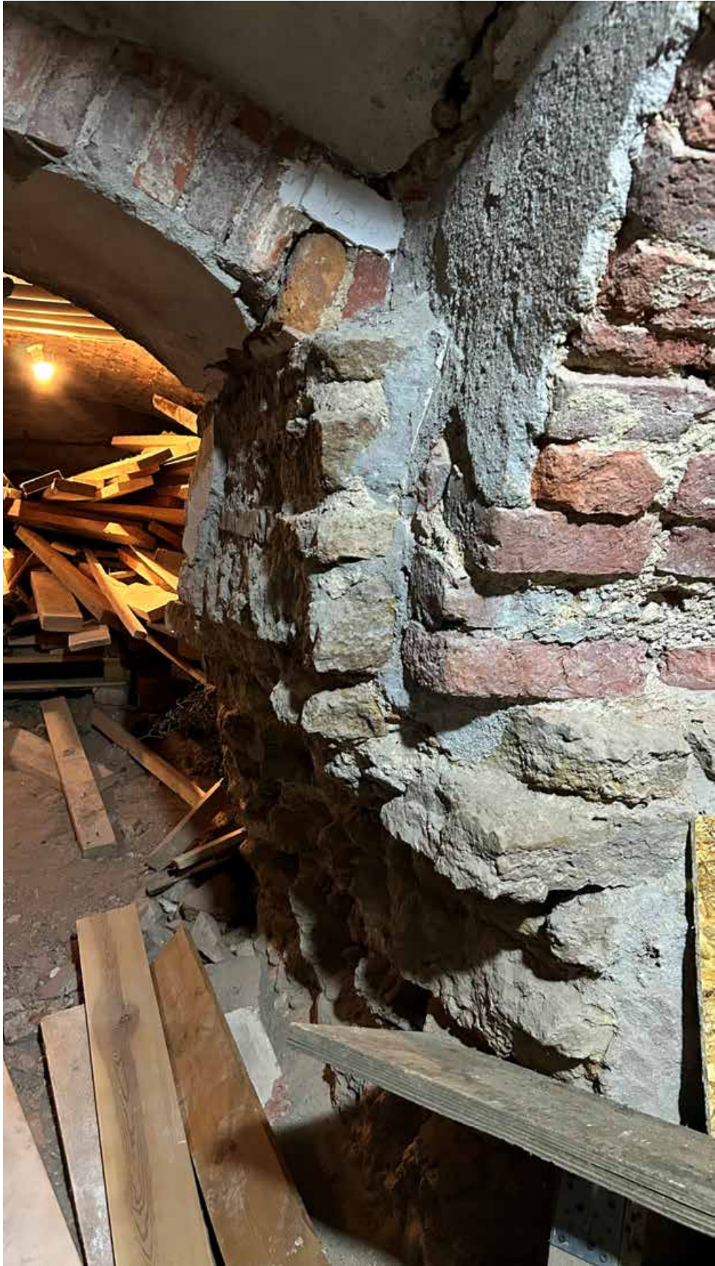
Фото 10. Подвал. Вид на разрушенный проем (дверь).
