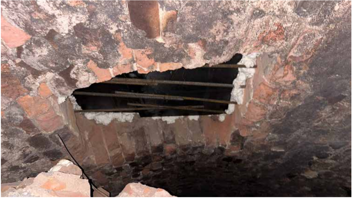
Фото 17. Подвал. Разрушение части свода в помещении западной части собора.
