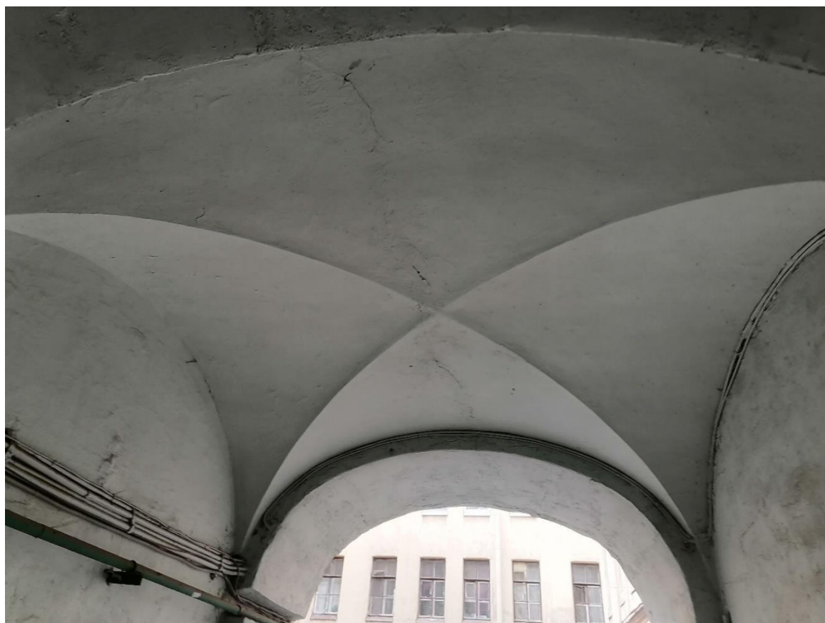
Фото 22. Трещины в сводах воротного проезда. «Дом А.Р. Гешвенда» по адресу: г. Санкт-Петербург, 9-я линия В.О., д.32, лит. А. 07.05.2024г.
