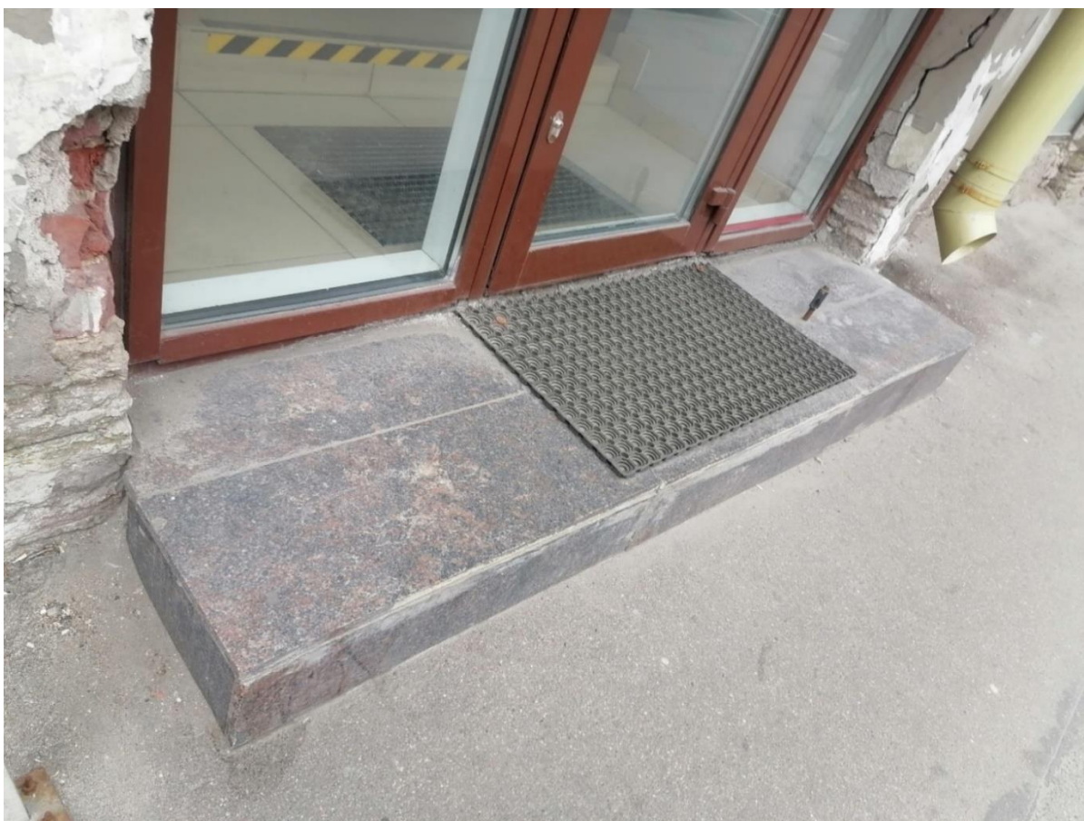
Фото 8. Крыльцо у входа со стороны лицевого фасада в помещении 1-Н. «Дом А.Р. Гешвенда» по адресу: г. Санкт-Петербург, 9-я линия В.О., д.32, лит. А. 07.05.2024г.
