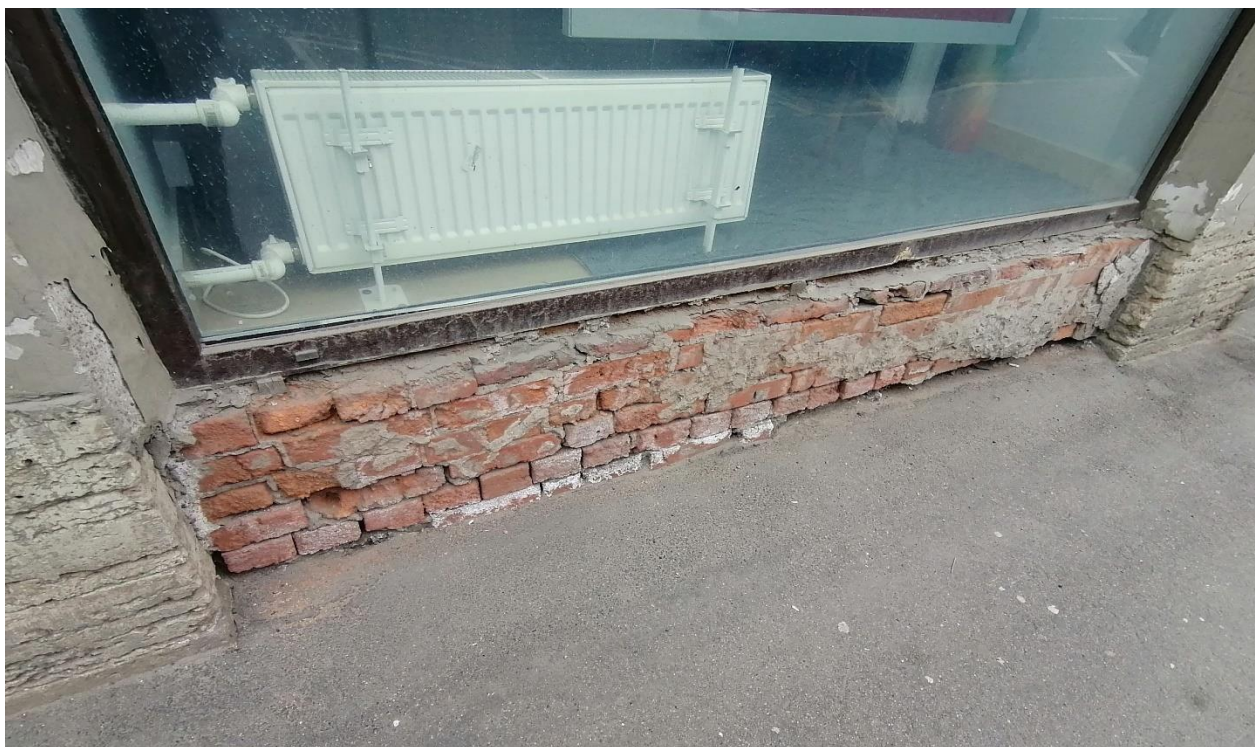
Фото 14. Нижняя часть витринного проема у воротного проезда лицевого фасада помещения 1-Н. «Дом А.Р. Гешвенда» по адресу: г. Санкт-Петербург, 9-я линия В.О., д.32, лит. А. 07.05.2024г.
