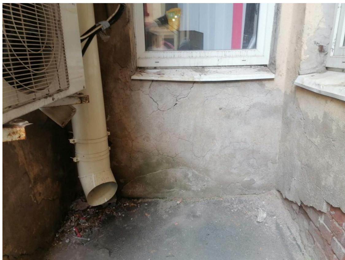
Фото 34. Фрагменты 1-го этажа дворового фасада в цокольной части главного корпуса в границах помещения 1-Н. «Дом А.Р. Гешвенда», по адресу: г. Санкт-Петербург, 9-я линия В.О., д.32, лит. А. 07.05.2024г.
