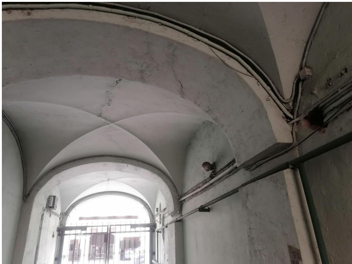
Фото 21. Трещины в сводах воротного проезда. «Дом А.Р. Гешвенда» по адресу: г. Санкт-Петербург, 9-я линия В.О., д.32, лит. А. 07.05.2024г.
