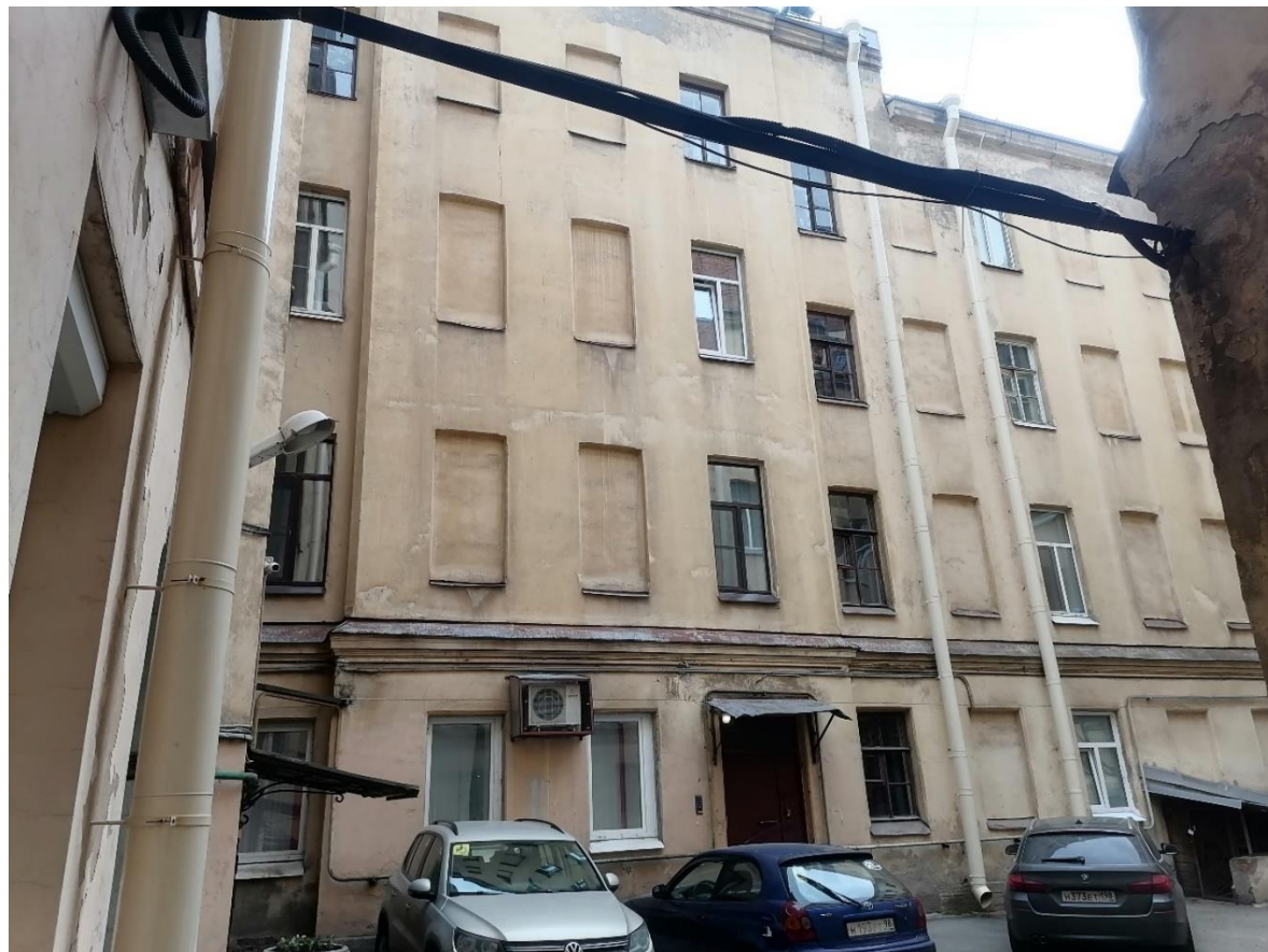
Фото 27. Общий вид дворового фасада южного флигеля. «Дом А.Р. Гешвенда» по адресу: г. Санкт-Петербург, 9-я линия В.О., д.32, лит. А. 07.05.2024г.
