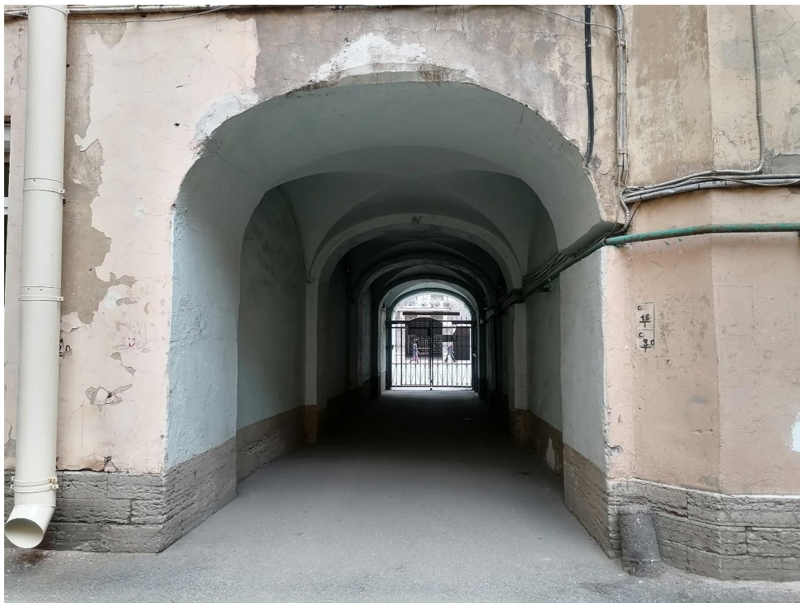
Фото 18. Воротный проезд со стороны дворового фасада. «Дом А.Р. Гешвенда» по адресу: г. Санкт-Петербург, 9-я линия В.О., д.32, лит. А. 07.05.2024г.
