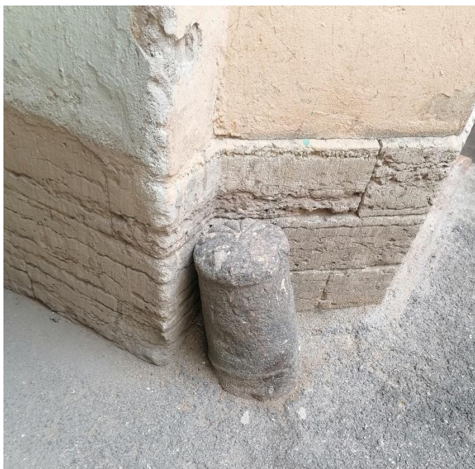
Фото 24. Отбойный гранитный столб воротного проезда со стороны двора. «Дом А.Р. Гешвенда» по адресу: г. Санкт-Петербург, 9-я линия В.О., д.32, лит. А. 07.05.2024г.
