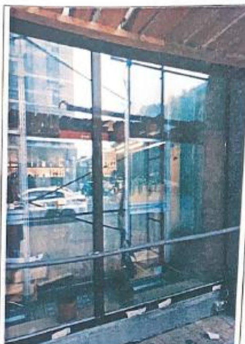
9. Фрагмент. Западный фасад здания по адресу: ул. Некрасова, дом 60, литера А. Окно Помещения.
