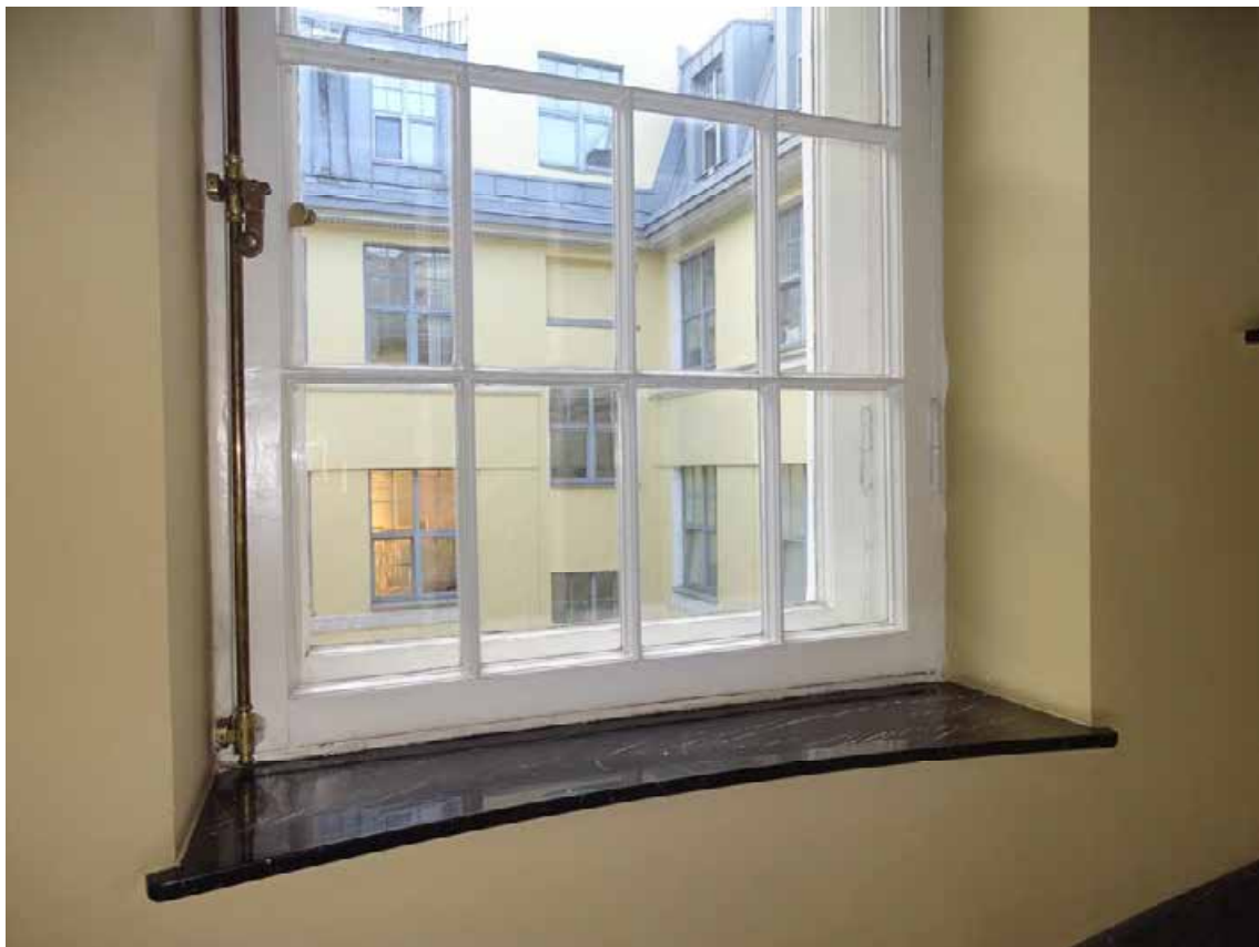
Фото 7. Объект культурного наследия регионального значения «Бывший дом Мертенса (фасады)». Парадная лестница Л-1. 5-й этаж. Фрагмент оконного заполнения. Съемка 24.04.2024 г. Трушковский В. Э.
