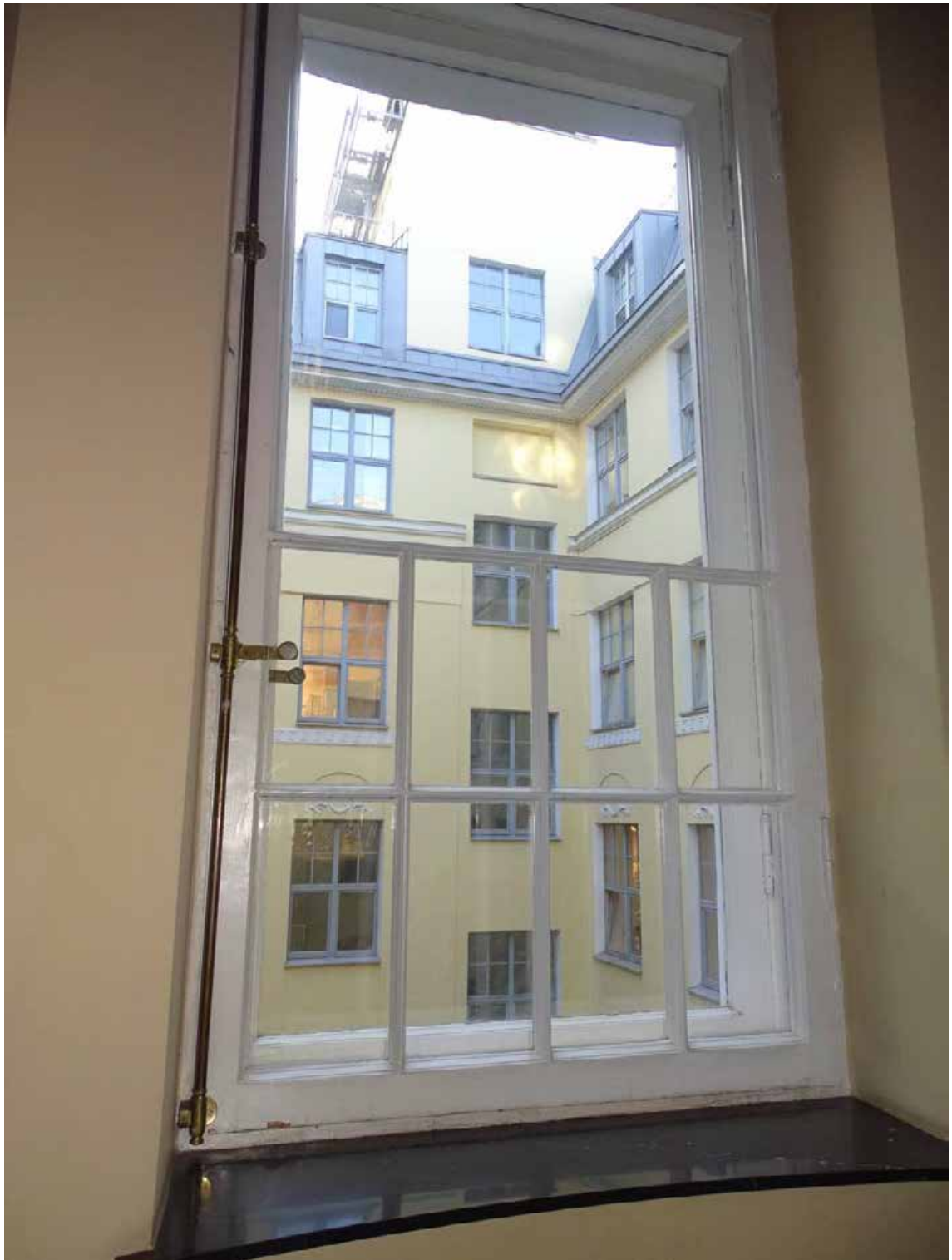
Фото 10. Объект культурного наследия регионального значения «Бывший дом Мертенса (фасады)». Парадная лестница Л-1. 4-й этаж. Оконное заполнение. Съемка 24.04.2024 г. Трушковский В. Э.
