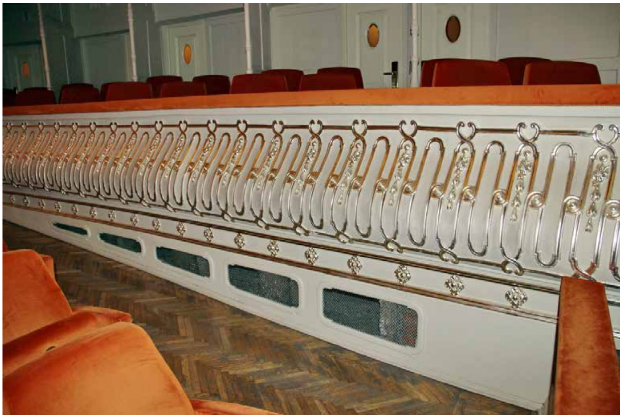
17 Помещение № 2 Партер зрительного зала. Фрагмент ограждения в уровне партера и бенуара Дата съемки: 01.04.2024
