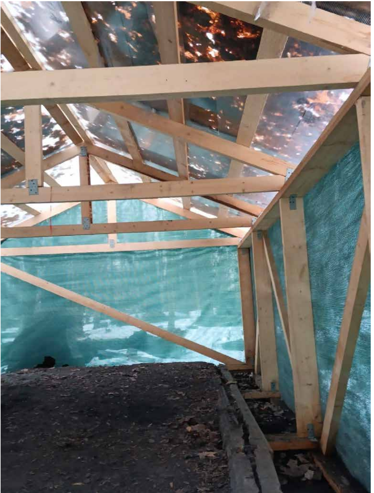
Фото 5. Объект культурного наследия регионального значения «Смоленское лютеранское кладбище». Могила генерал-майора А. фон Бекмана (1807-1833), предмет охраны объекта культурного наследия. Фрагмент временного защитного ограждения в виде деревянного каркаса, обшитого защитными материалами. Конструкции беседки, крыши, мощения демонтированы, находятся в мастерской для проведения реставрационных работ.
