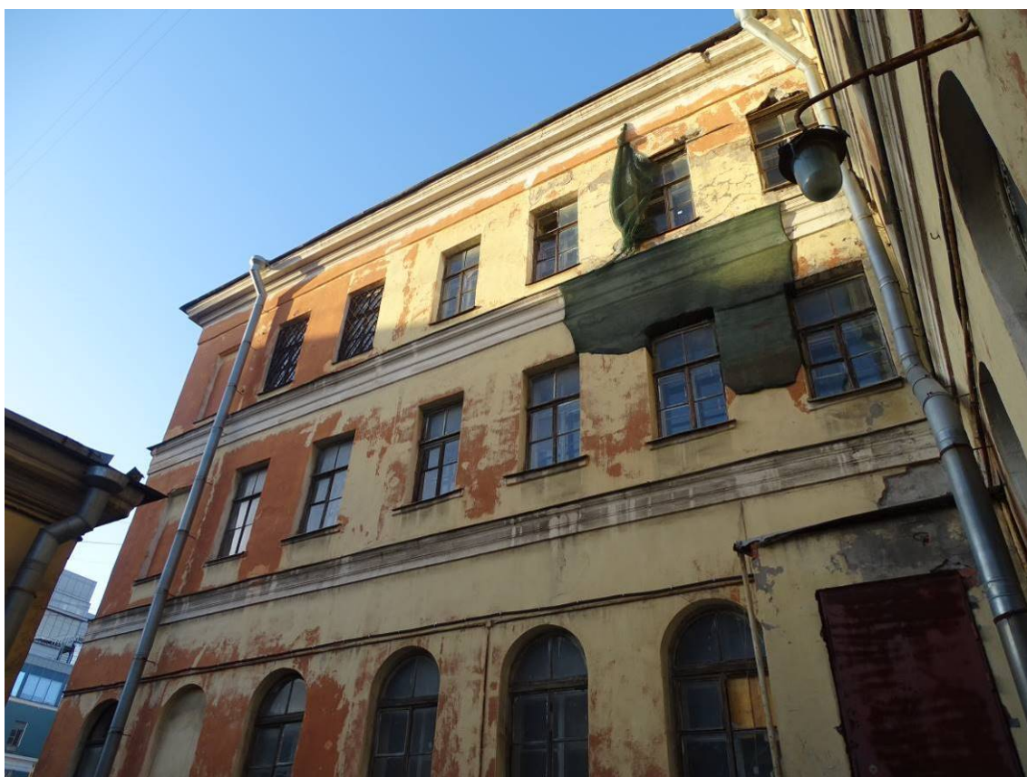
Илл. 19. Выявленный объект культурного наследия «Здание детского приюта вел. кн. Александры Николаевны (со служебными постройками)». Фрагмент дворового фасада. Съемка 06.03.2024 г. Трушковский В.Э.
