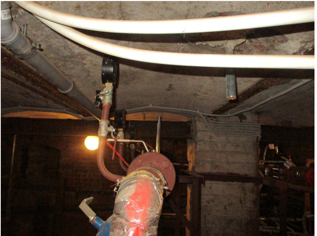
14. Объект культурного наследия регионального значения «Дом В.П. Осетрова» по адресу: г. Санкт-Петербург, ул. Вакуленчука, дом 4, литера А. Проход теплосети в подвале.
