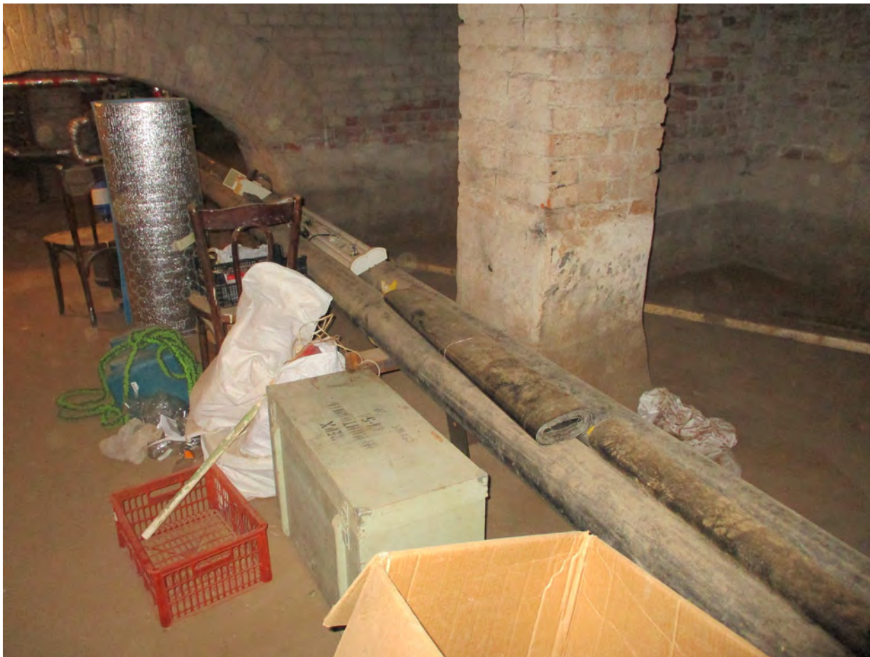
20. Объект культурного наследия регионального значения «Дом В.П. Осетрова» по адресу: г. Санкт-Петербург, ул. Вакуленчука, дом 4, литера А. Проход теплосети в подвале.
