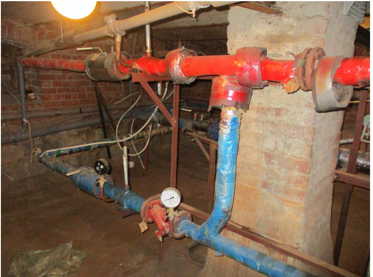
13. Объект культурного наследия регионального значения «Дом В.П. Осетрова» по адресу: г. Санкт-Петербург, ул. Вакуленчука, дом 4, литера А. Проход теплосети в подвале.
