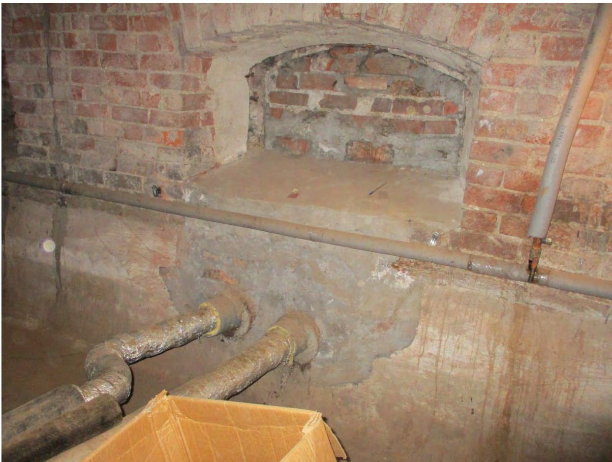
12. Объект культурного наследия регионального значения «Дом В.П. Осетрова» по адресу: г. Санкт-Петербург, ул. Вакулчука, дом 4, литера А. Ввод теплосети в здание.
