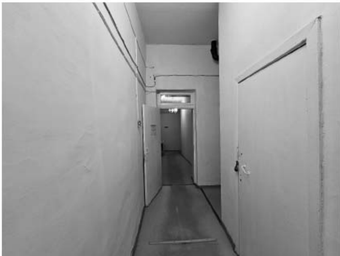
68. Выявленный объект культурного наследия «Особняк Е.А. Брюн», по адресу: г. Санкт-Петербург, Почтамтская ул., д. 19-21, лит. А. Фрагмент пом. 8-Н (1) в уровне 1-го этажа.
