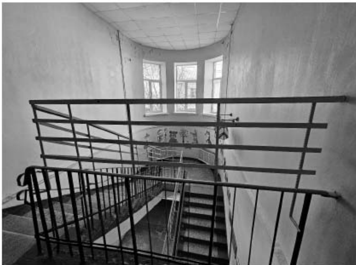
101. Выявленный объект культурного наследия «Особняк Е.А. Брюн», по адресу: г. Санкт-Петербург, Почтамтская ул., д. 19-21, лит. А. Общий вид парадной лестницы в уровне 2-го этажа.
