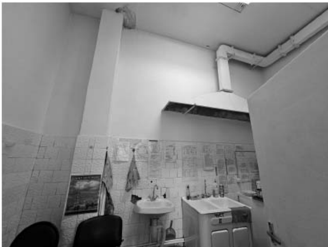
96. Выявленный объект культурного наследия «Особняк Е.А. Брюн», по адресу: г. Санкт-Петербург, Почтамтская ул., д. 19-21, лит. А. Общий вид пом. 12-Н (10) в уровне 2-го этажа.
