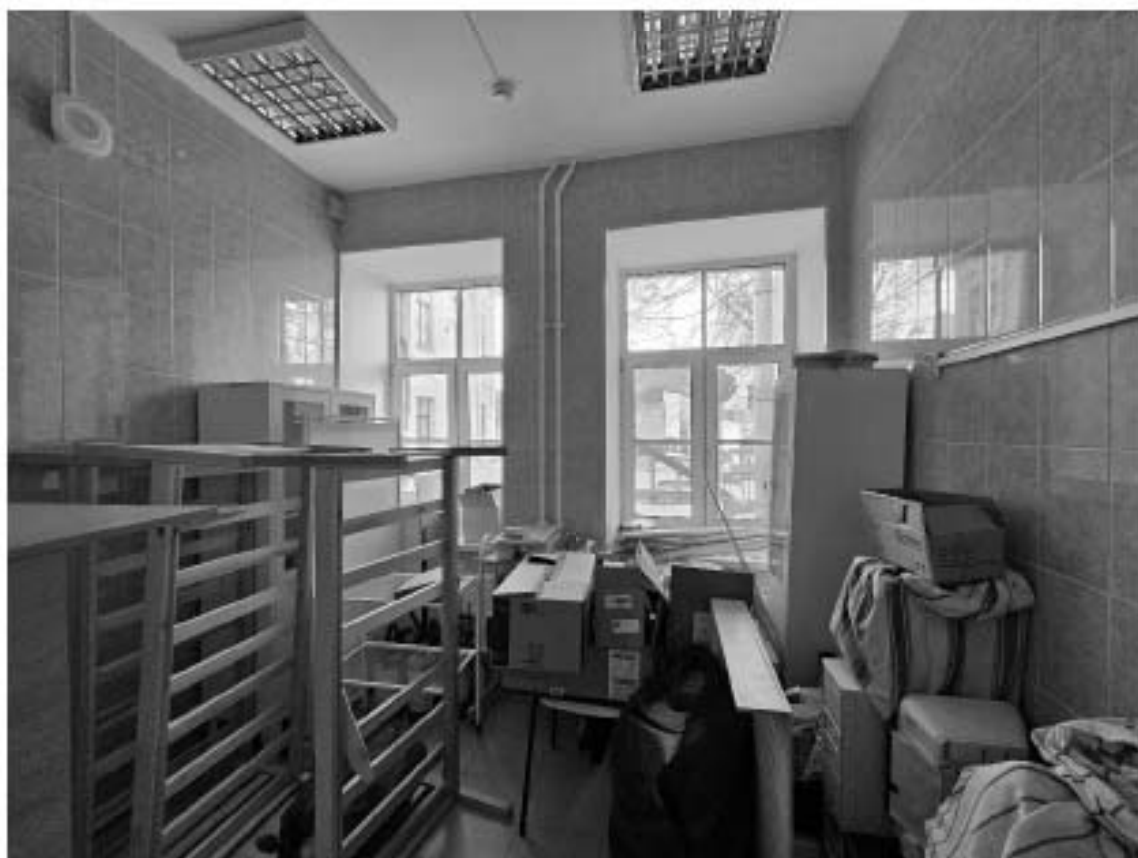
49. Выявленный объект культурного наследия «Особняк Корсаковой», по адресу: г. Санкт-Петербург, Почтамтская ул., д. 19-21, лит. А. Фрагмент пом. 4-Н (11) в уровне 1-го этажа.
