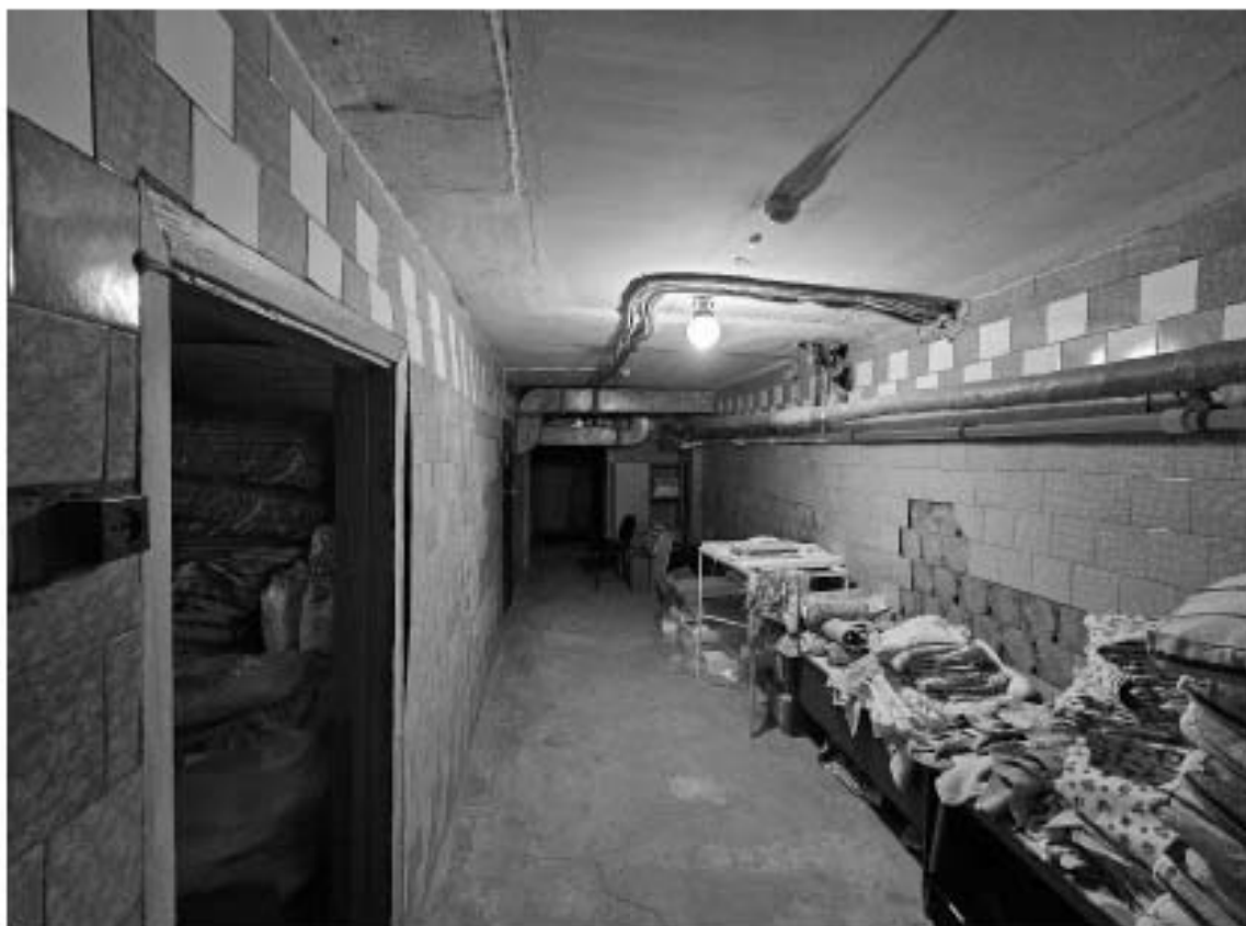
28. Выявленный объект культурного наследия «Особняк Е.А. Брюн», по адресу: г. Санкт-Петербург, Почтамтская ул., д. 19-21, лит. А. Фрагмент пом. 1-Н (1) в уровне цокольного этажа.
