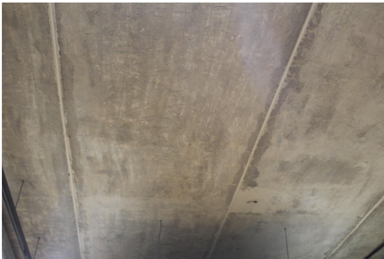
Фото 26. Квартира № 41, вид на потолок в помещении № 8.
