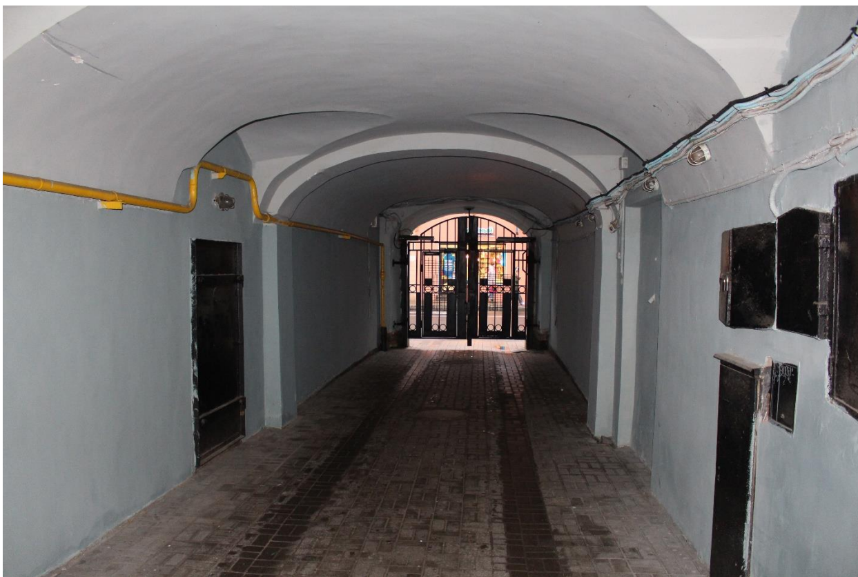
Фото 5. Вид на арку воротного проезда объекта культурного наследия регионального значения «Дом Васильевых».
