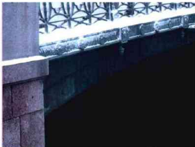
5. Коррозия металла, утрата расшивки швом гранитной облицовки
