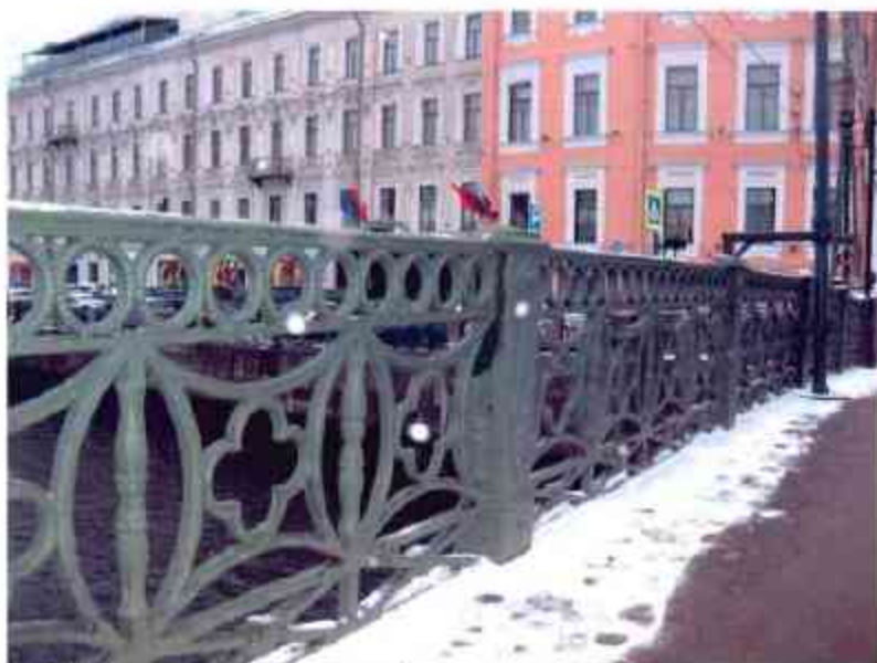
3. Перильное ограждение, тротуар. Повреждение столбика чугунного ограждения
