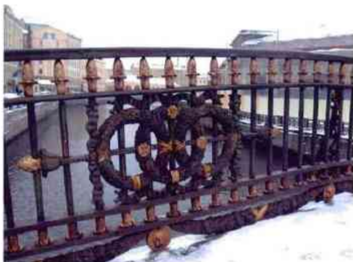
5. Репи́вска перильного ограждения (утрата красочного слоя в погоды, коррозия)
