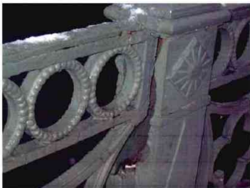
4. Решётка перильного ограждения (сколы, коррозия)
