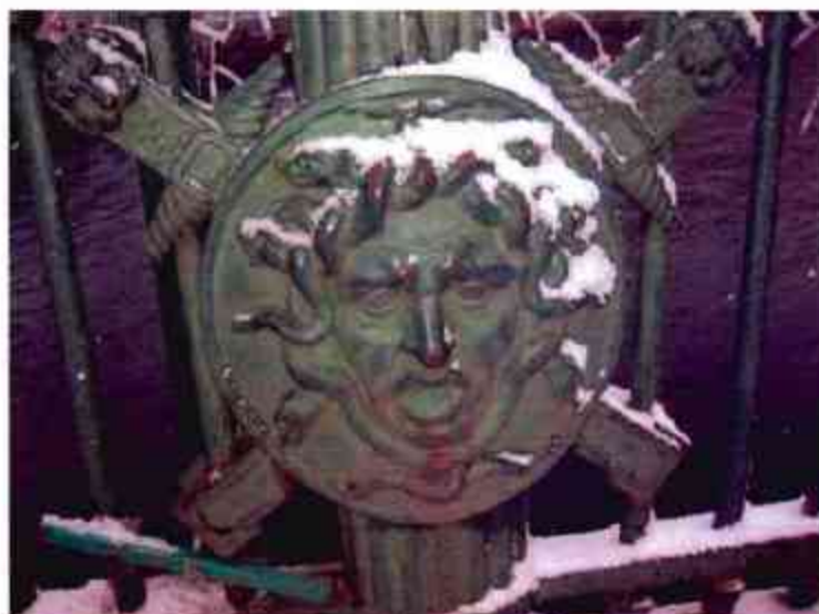
4. Фрагмент перильного ограждения (частичная утрата красочного слоя, коррозия)
