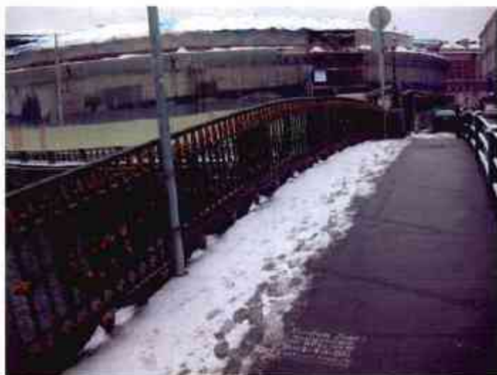
4. Решётка перильного ограждения (утрата красочного слоя и позолоты, коррозии), тротуар со стороны верхового фасада
