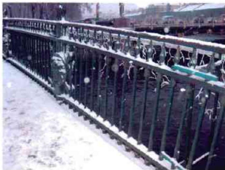
3. Перильное ограждение. Частичная утрата красочного слоя, коррозия
