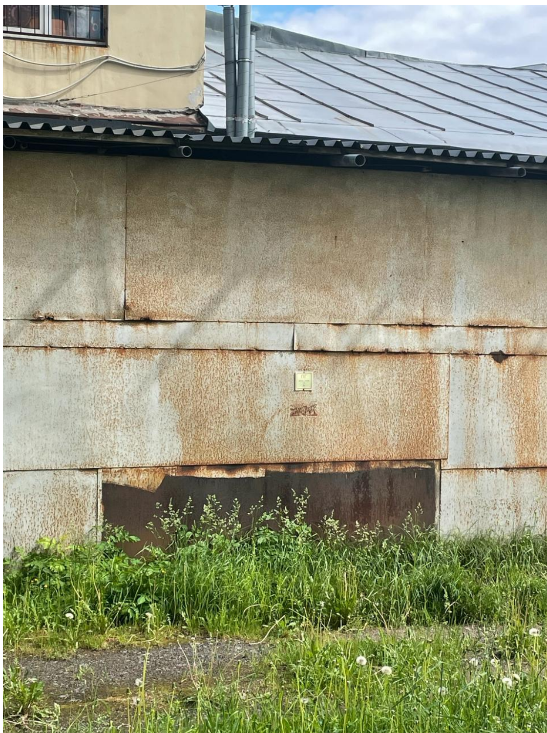
23. Выявленный объект культурного наследия «Дом культуры им. В. И. Ленина завода «Большевик», 1927–1929 гг., г. Санкт-Петербург, проспект Обуховской Обороны, 223, литера А. Место ввода тепловой сети в здание.
