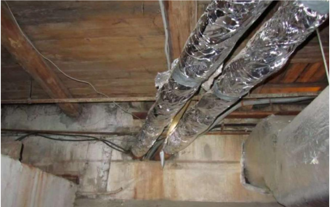
29. Выявленный объект культурного наследия «Дом культуры им. В. И. Ленина завода «Большевик», 1927–1929 гг., г. Санкт-Петербург, проспект Обуховской Обороны, 223, литера А. Места примыкания труб теплосети.
