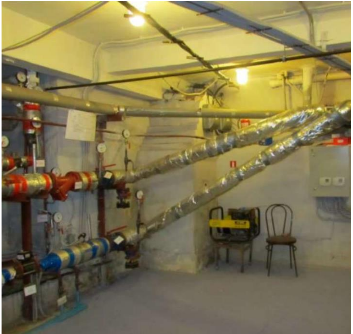
30. Выявленный объект культурного наследия «Дом культуры им. В. И. Ленина завода «Большевик», 1927–1929 гг., г. Санкт-Петербург, проспект Обуховской Обороны, 223, литера А. Соединение труб теплосети с узлами учета.
