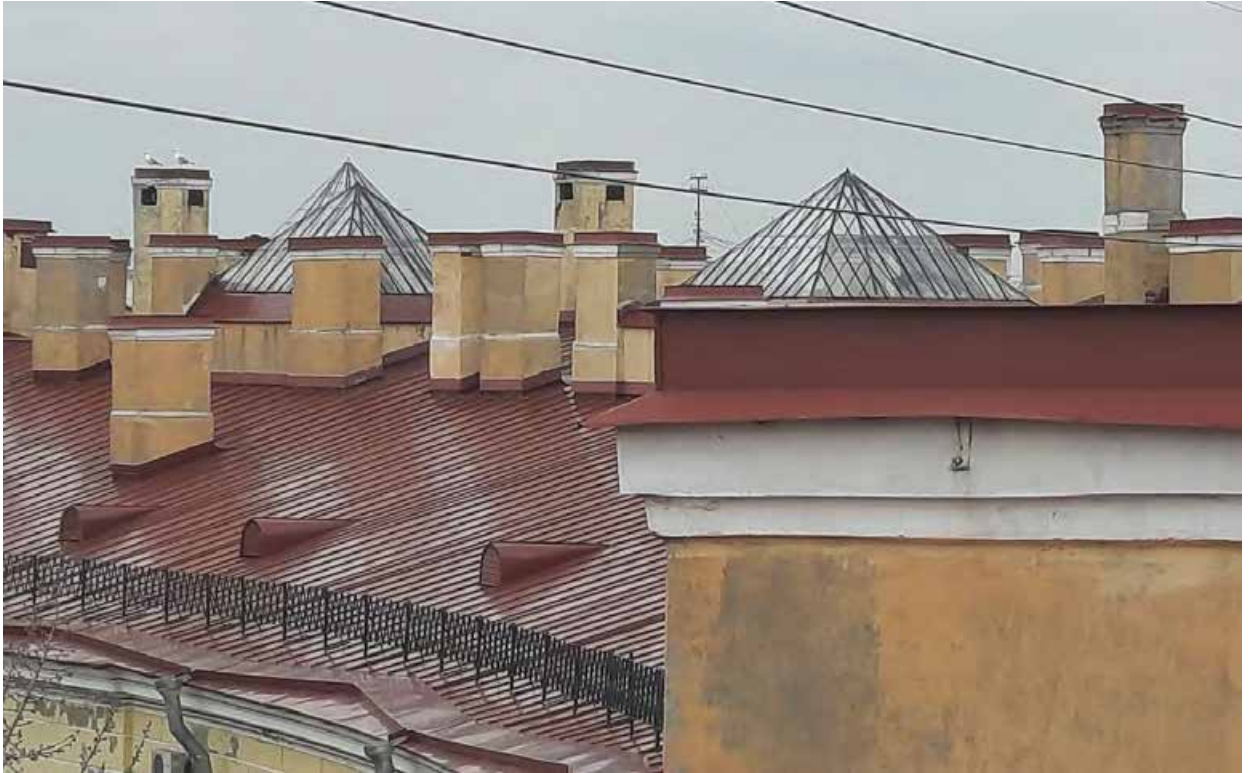
19. Объект культурного наследия федерального значения «Банк», расположенный по адресу: г. Санкт-Петербург, наб. кан. Грибоедова, д. 30-32, лит. А, входящий в состав объекта культурного наследия федерального значения «Банк Ассигнационный». Кровля. Вид на световые фонари. Фото от 20 марта 2024 г.
