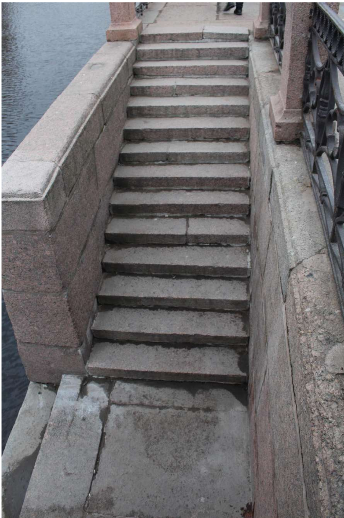
Фото 9. Вид на лестницу спуска № 1 объекта культурного наследия федерального значения «Набережные со спусками» на уч. наб. р. Мойки «Мало-Конюшенный-Большой Конюшенный мост», литера А.
