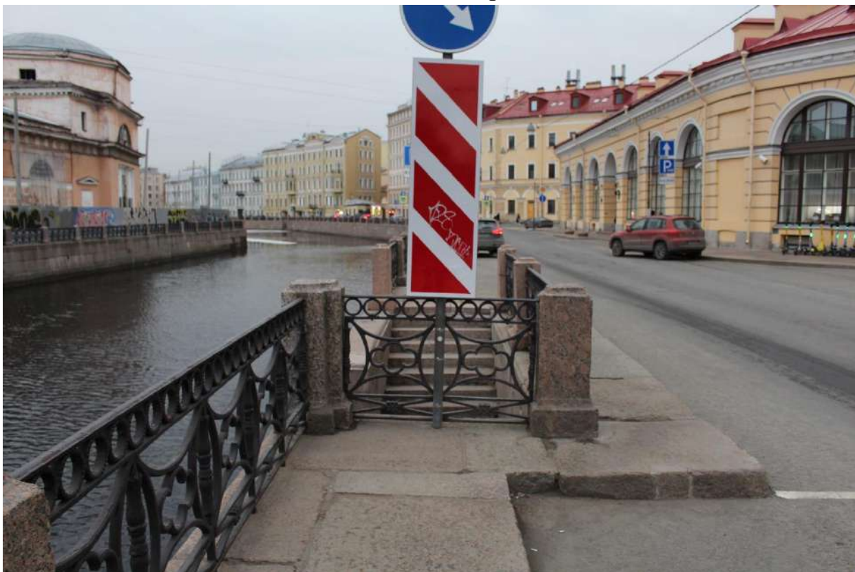
Фото 4. Вид на спуск № 1 объекта культурного наследия федерального значения «Набережные со спусками» на уч. наб. р. Мойки «Мало-Конюшенный-Большой Конюшенный мост», литера А с востока.
