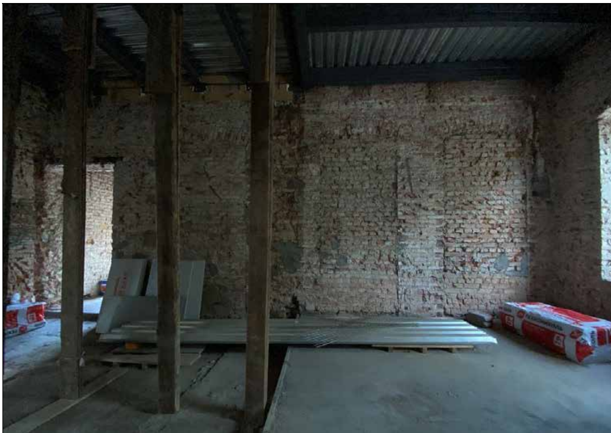
83. Центральный корпус. 2-й этаж. Помещение с северо-западной стороны от центрального помещения. Северо-западная часть помещения. 30.03.2024 г.
