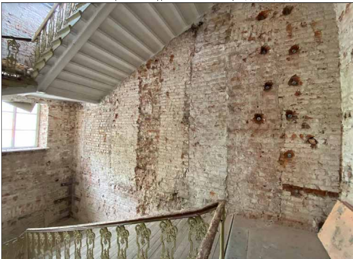
88. Центральный корпус. 2-й этаж. Лестница с северо-восточной стороны от центрального помещения. Восточная часть лестницы. 30.03.2024 г.
