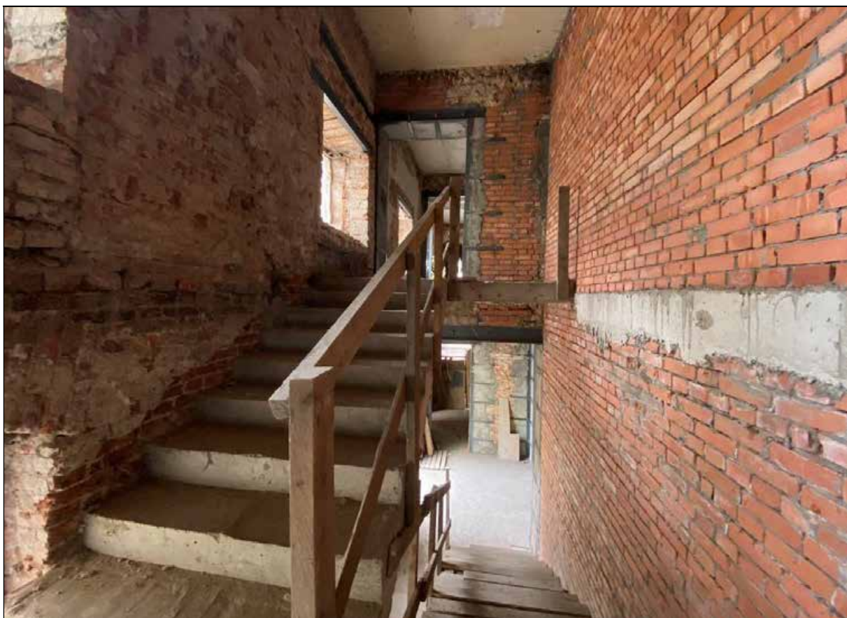
101. Западный флигель. 2-й этаж. Лестница с северо-западной стороны от центрального помещения. Восточная часть лестницы. 30.03.2024 г.
