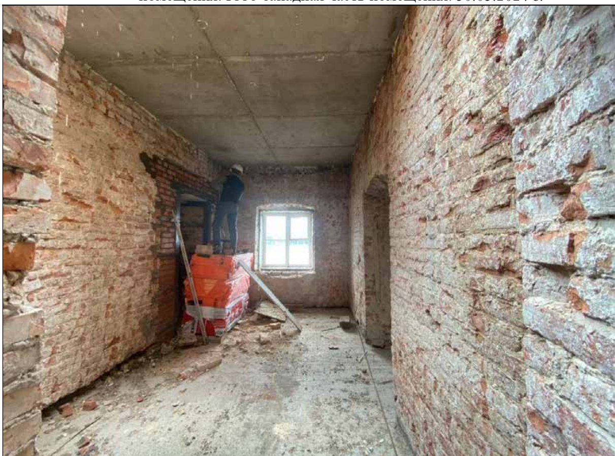
142. Центральный корпус. 3-й этаж. Помещение с юго-западной стороны от центрального помещения. Южная часть помещения. 30.03.2024 г.
