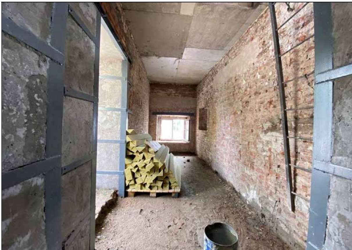
115. Западный флигель, 2-й этаж. Помещение с северо-восточной стороны от центрального помещения. Восточная часть помещения. 30.03.2024 г.
