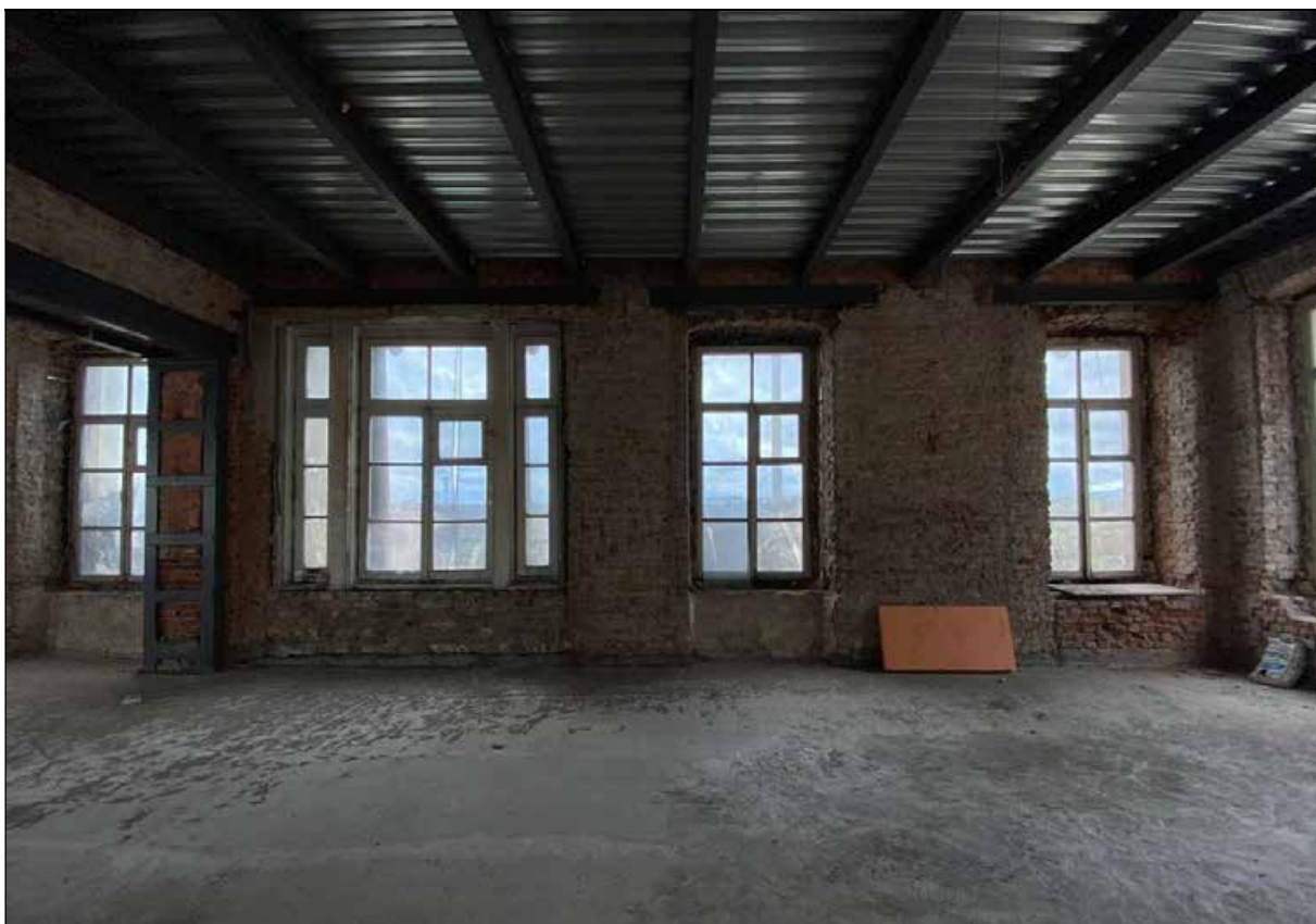
52. Восточный флигель. 1-й этаж. Юго-западное помещение. Оконные проемы в южной стене. 30.03.2024 г.
