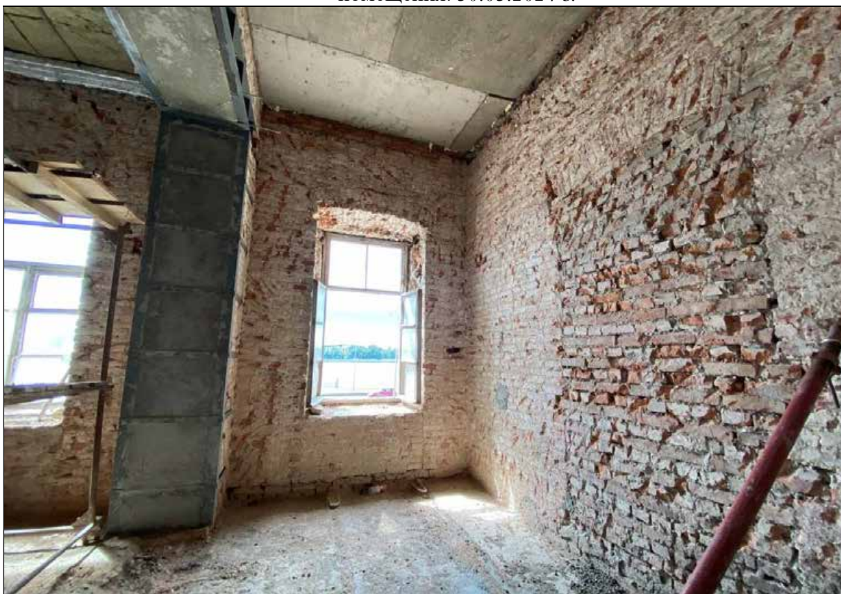
76. Центральный корпус. 2-й этаж. Помещение с юго-западной стороны от центрального помещения. Южная часть помещения. 30.03.2024 г.
