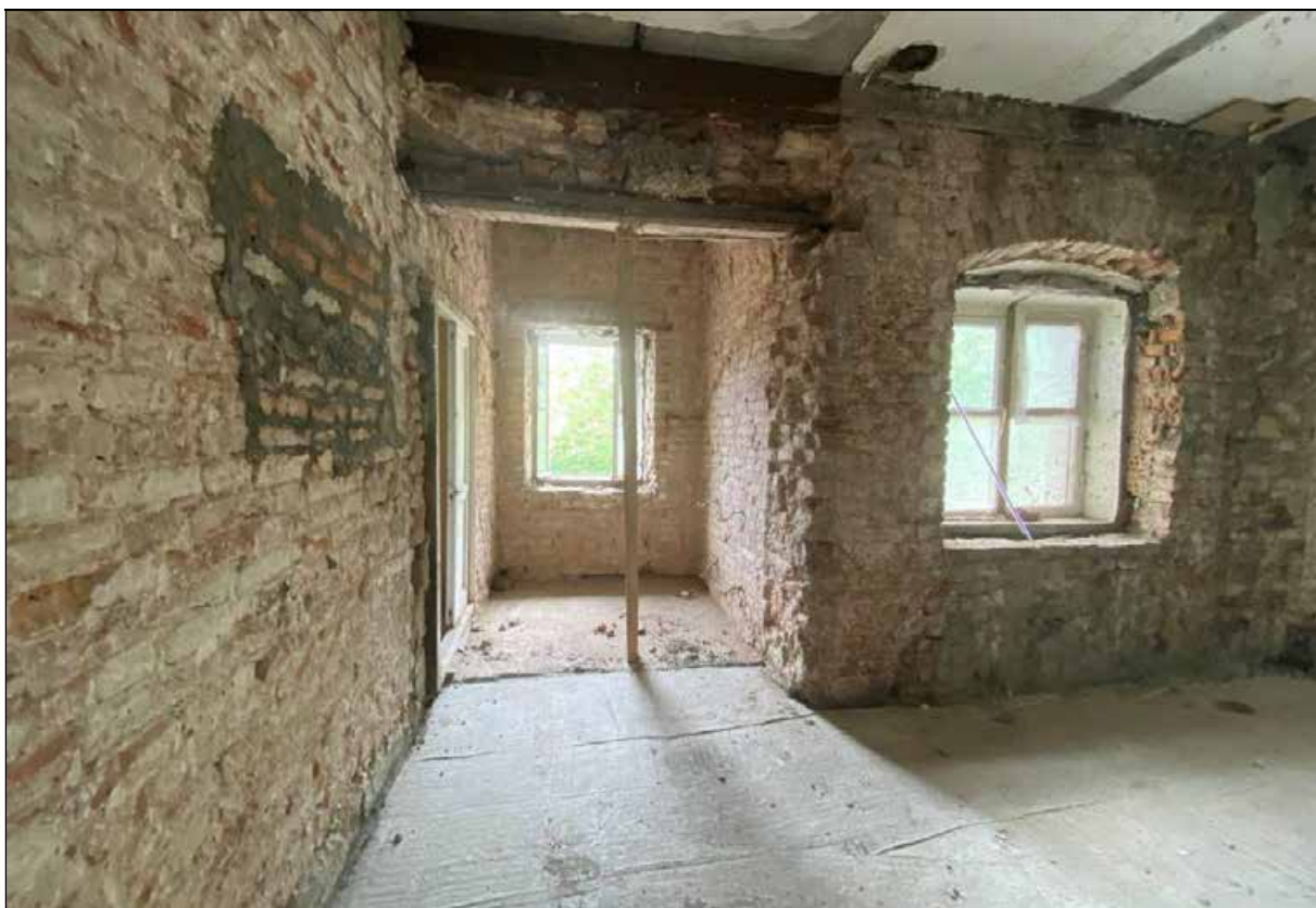
141. Центральный корпус. 3-й этаж. Помещение с северо-западной стороны от центрального помещения. Юго-западная часть помещения. 30.03.2024 г.
