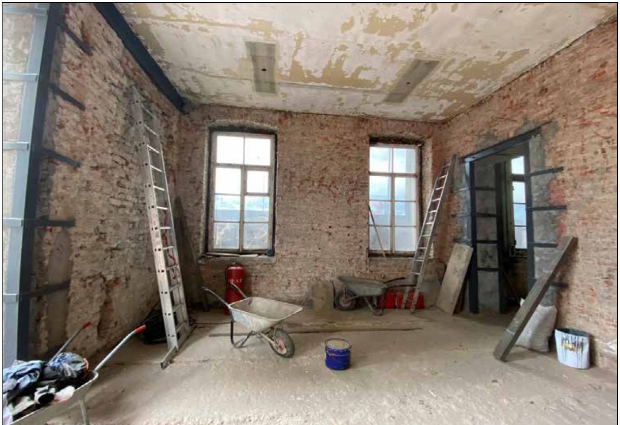
45. Западный флигель. 1-й этаж. Юго-восточное помещение. Оконные проемы в южной стене. 30.03.2024 г.
