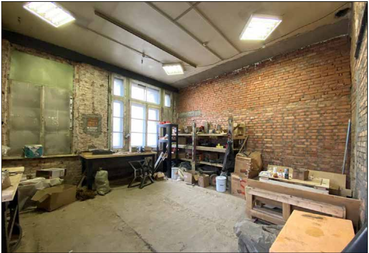
41. Западный флигель. 1-й этаж. Юго-западное помещение. Оконные проемы в западной стене. 30.03.2024 г.
