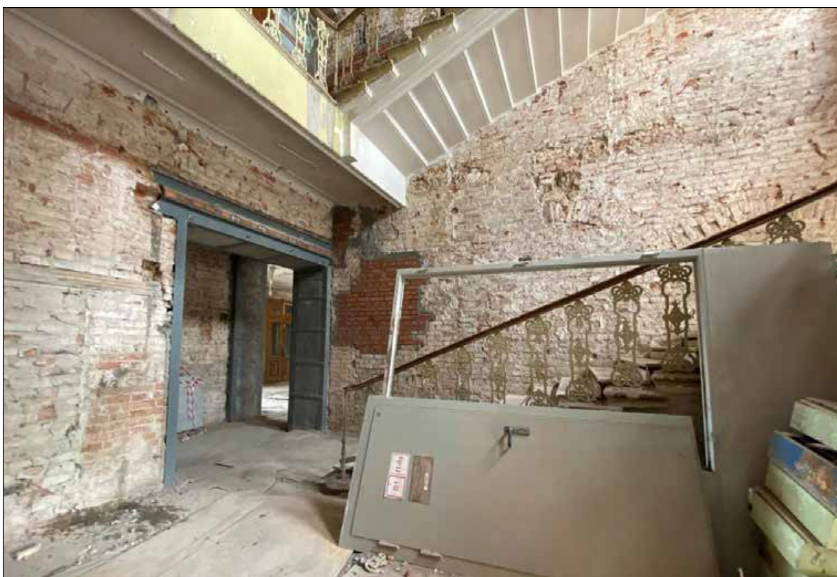
18. Центральный корпус. 1-й этаж. Лестница с северо-восточной стороны от центрального помещения. Проем в южной части лестницы. 30.03.2024 г.
