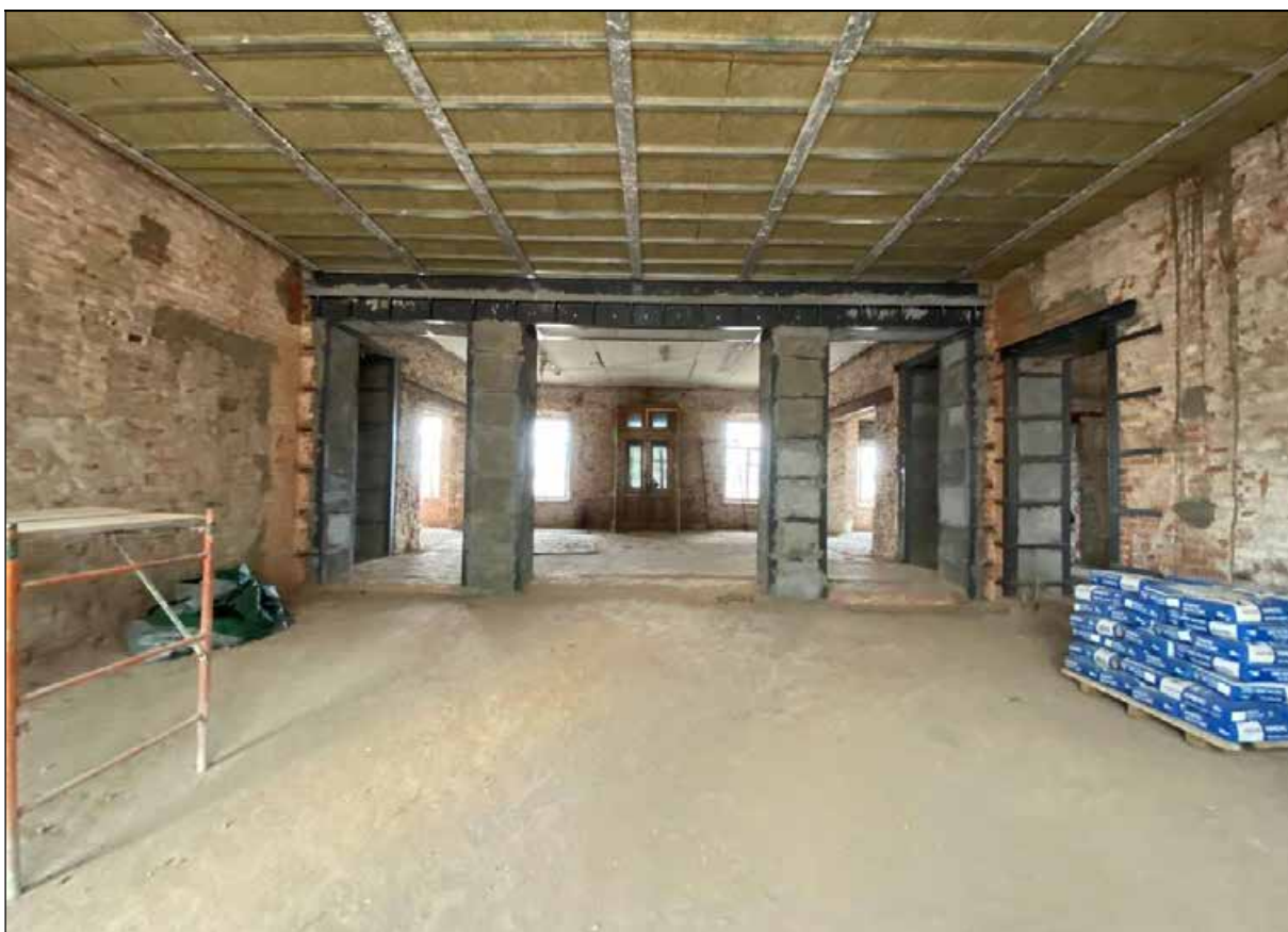
10. Центральный корпус. 1-й этаж. Северная часть центрального помещения. Вид в сторону выхода в парадный двор. 30.03.2024 г.
