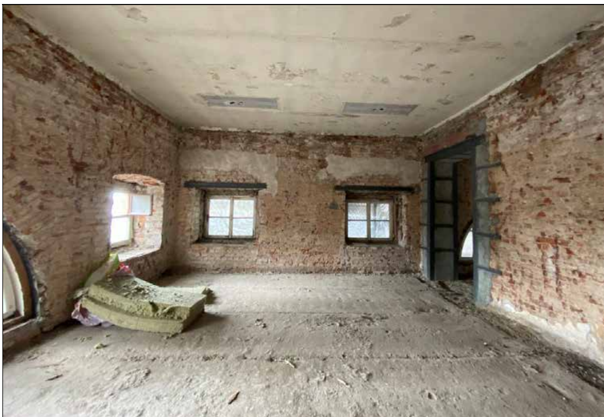
111. Западный флигель. 2-й этаж. Помещение с юго-восточной стороны от центрального помещения. Оконные проемы в южной части помещения. 30.03.2024 г.
