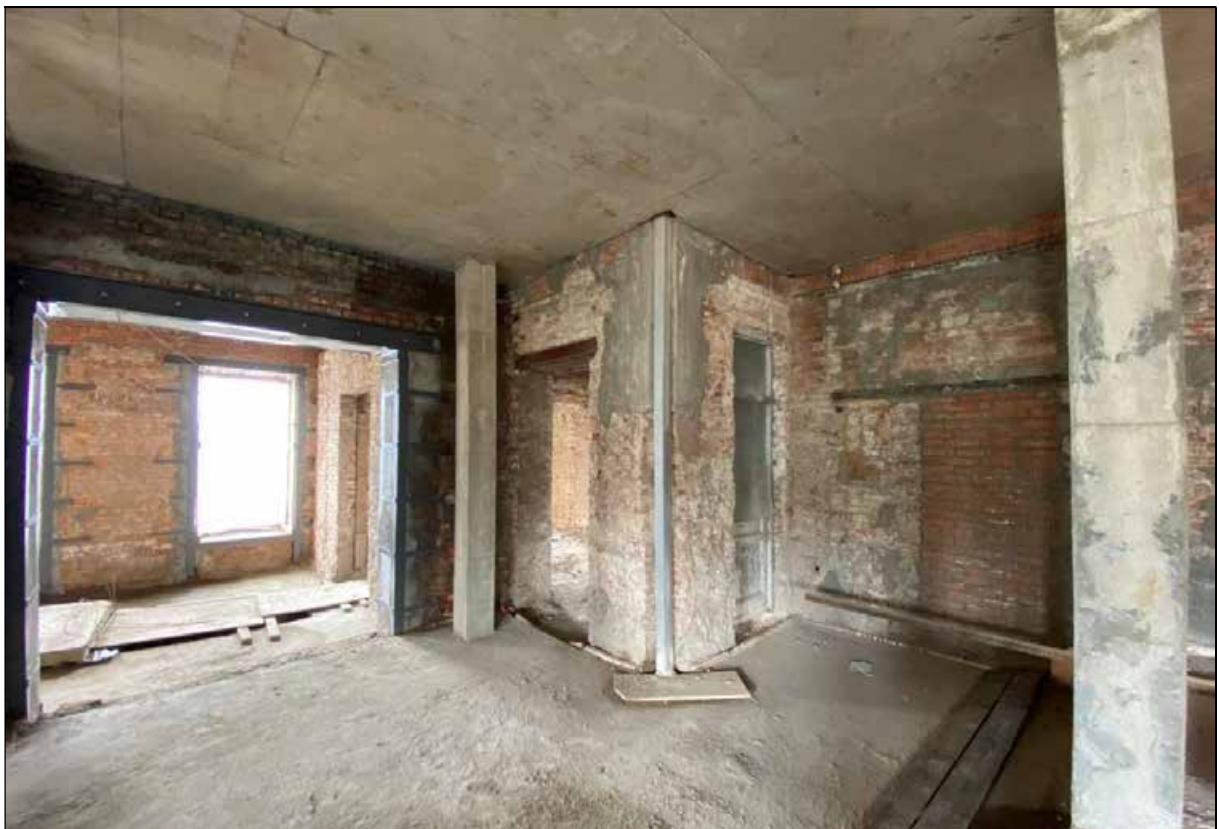
64. Восточное помещение. 1-й этаж. Юго-западная часть помещения. Проход в восточную галерею. 30.03.2024 г.
