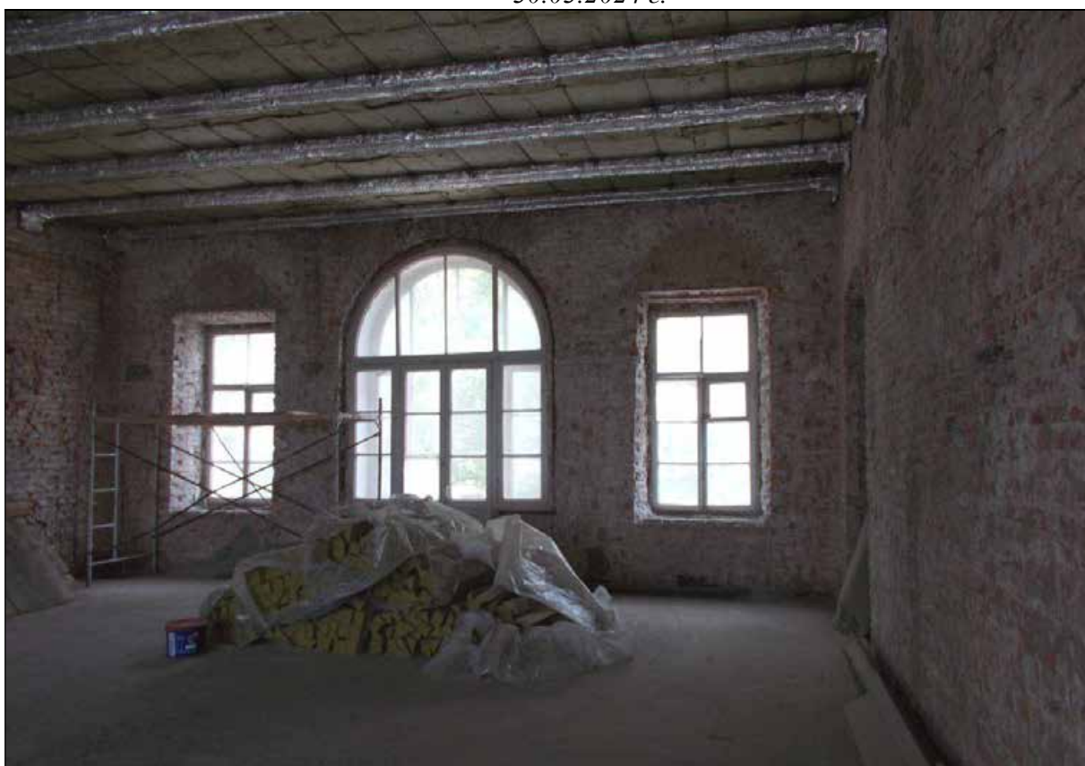
68. Центральный корпус. 2-й этаж. Оконные проемы в северной части центрального помещения. 30.03.2024 г.
