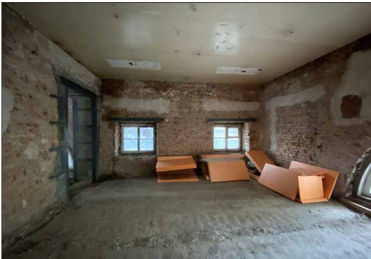
114. Западный флигель. 2-й этаж. Помещение с юго-западной стороны от центрального помещения. Южная часть помещения. 30.03.2024 г.
