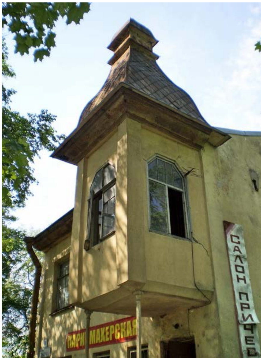
17. Выявленный объект культурного наследия «Жилой дом», по адресу: Санкт-Петербург, город Красное Село, проспект Ленина, д. 93 литера А (г. Красное Село, Ленина пр., 93). 2010г. Источник: www.citywalls.ru
