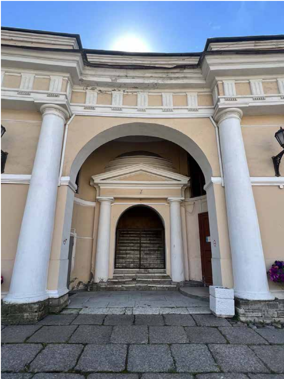
Фото 28. «Дворец Юсуповых», входящий в состав объекта культурного наследия федерального значения «Дворец с флигелями», Московский пр., д. 9, литера В. Фрагмент дворового фасада юго-западного крыла. Дата съемки: 26.07.2022 г. Автор съемки: Куваева Ю.П.
