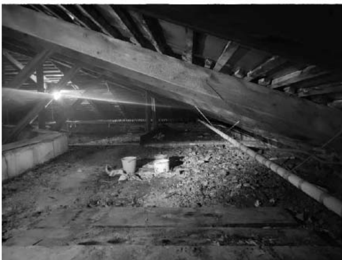
Фото 3. Объект культурного наследия регионального значения «Солдатская казарма» (г. Санкт-Петербург, Загородный пр., д. 48 лит. А), входящий в состав объекта культурного наследия регионального значения «Комплекс казарм Семеновского и Егерского полков». Чердак.
