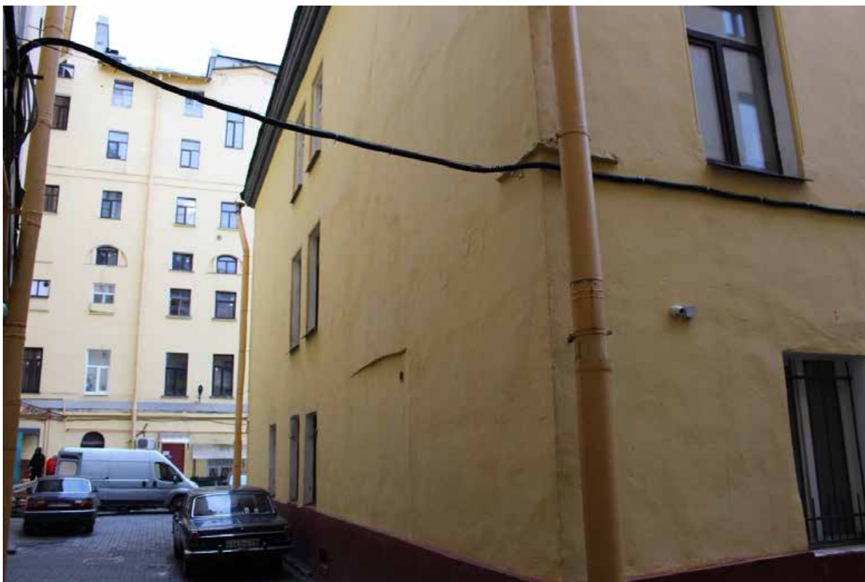
Фото 17. Вид на южный фасад дворового флигеля выявленного объекта культурного наследия «Дом Зверкова (И.С. Никитина)».
