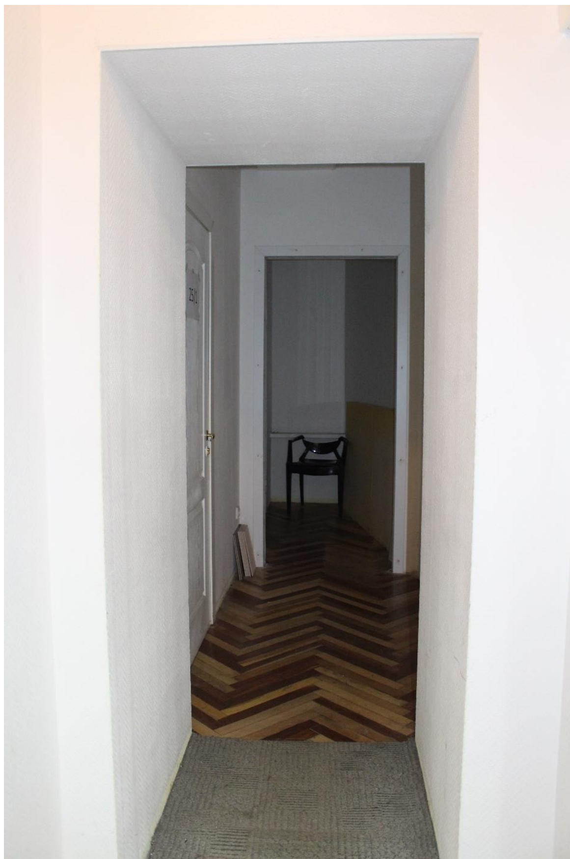
Фото 69. Внутренние помещения дворового флигеля выявленного объекта культурного наследия «Дом Зверкова (И.С. Никитина)». Нежилое помещение 34-Н. Помещения 38, 34.
