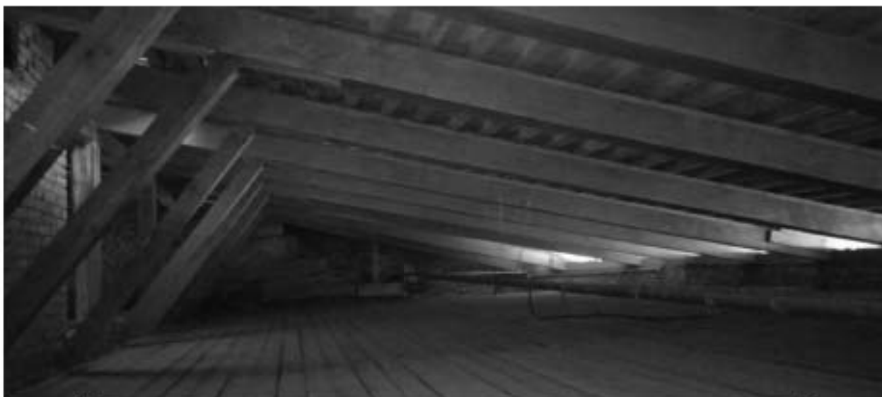
Фото 55. Интерьер чердака объекта культурного наследия регионального значения «Здание приюта для детей-сирот и эпилептиков Братства во имя Царицы Небесной с примыкающей часовней при домово́й церкви Божьей Матери Скорбящих Радости»
