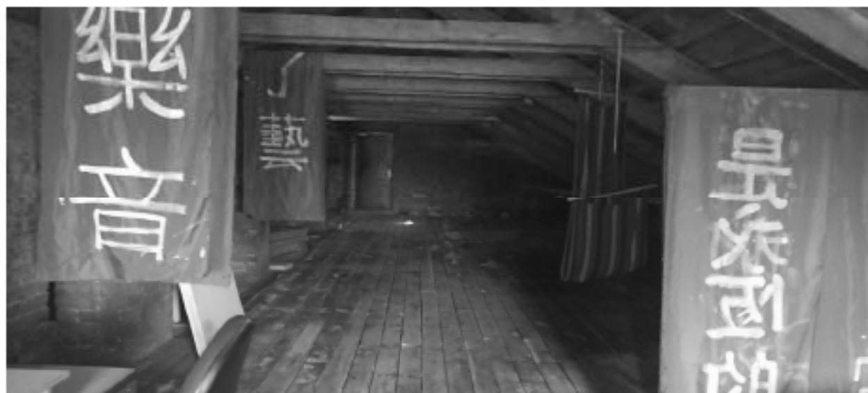
Фото 50. Интерьер чердака объекта культурного наследия регионального значения «Здание приюта для детей-сирот и эпилептиков Братства во имя Царицы Небесной с примыкающей часовней при домово́й церкви Божьей Матери Скорбящих Радости»
