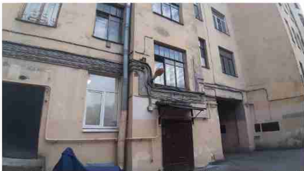
56. Ансамбль жилых домов площади Стачек (3 здания) (Перекопская ул., д. 1, лит. А). Дворовые фасады. Фото мест установки оборудования и кабельных трасс. Штиглиц М.С. 07.05.2024.
