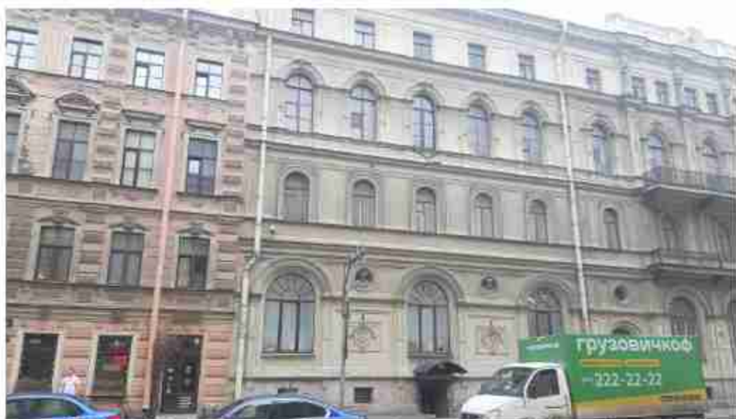
22. Дом А.Б.Фиттингофа. (ул. Глилки, д. 1, лит. А). Лицевой фасад (фрагмент). Фото мест установки оборудования и кабельных трасс. Штиглиц М.С. 07.05.2024.
