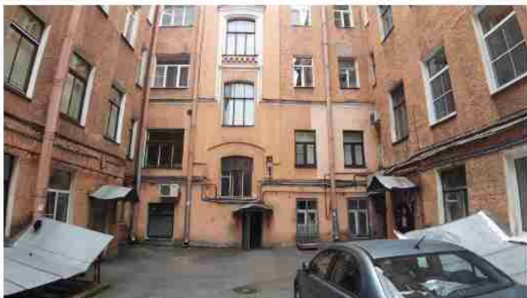
10. Дом Паулуччи А.Ф. Здесь в декабре 1905 - январе 1906 гг. проходили заседания ЦК и ПК РСДРП (Большая Морская ул., д. 36, лит. А). Дворовые фасады. Фото мест установки оборудования и кабельных трасс. Штиглиц М.С. 07.05.2024.
