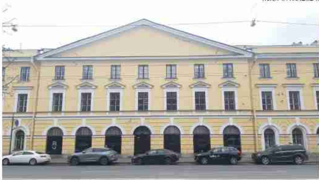
36. Казармы (Трехэскадронный корпус) (в составе «Манеж и казармы Конногвардейского полка») (Конногвардейский бульвар, д. 4, лит. А). Лицевой фасад (фрагмент). Фото мест установки оборудования и кабельных трасс. Штиглиц М.С. 07.05.2024.
