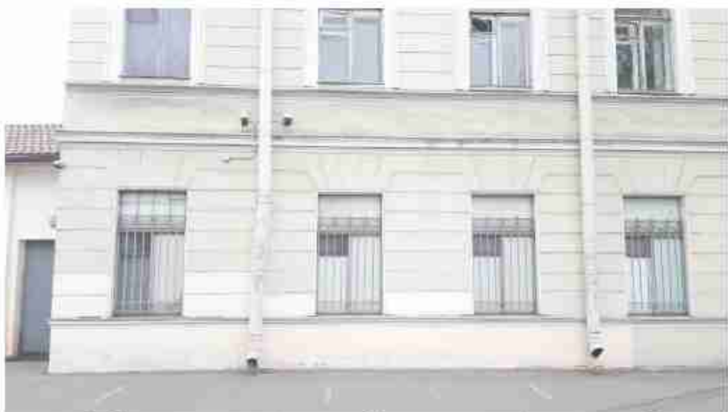
48. Офицерская казарма (в составе «Комплекса казарм Семеновского и Егерского полков»). (Загородный пр., д. 54, лит. А). Лицевой фасад (фрагмент). Фото мест установки оборудования и кабельных трасс. Штиглиц М.С. 07.05.2024.
