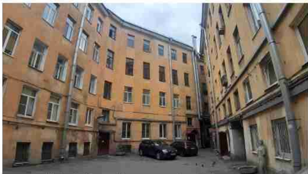
18. Дом Ф. Моровица. (Никольская пл., д. 6, лит. А). Дворовые фасады. Фото мест установки оборудования и кабельных трасс. Штиглиц М.С. 07.05.2024.
