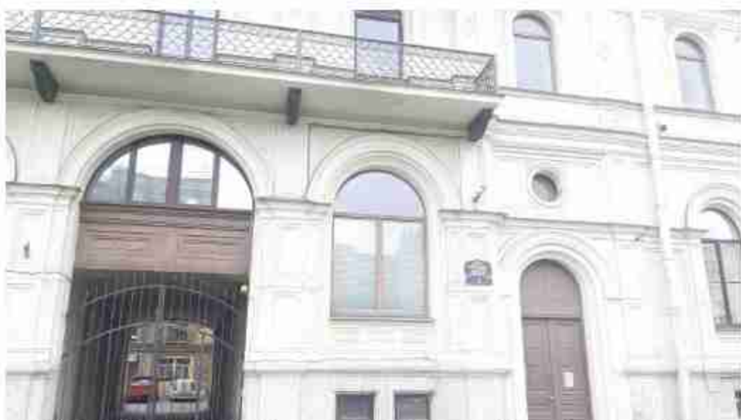
24. Дом А.Б.Фитингофа. (ул. Глинки, д. 1, лит. А). Лицевой фасад (фрагмент). Фото мест установки оборудования и кабельных трасс. Штиглиц М.С. 07.05.2024.
