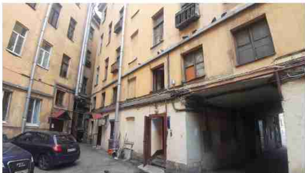
17. Дом Ф. Моровица. (Никольская пл., д. 6, лит. А). Дворовые фасады. Фото мест установки оборудования и кабельных трасс. Штиглиц М.С. 07.05.2024.
