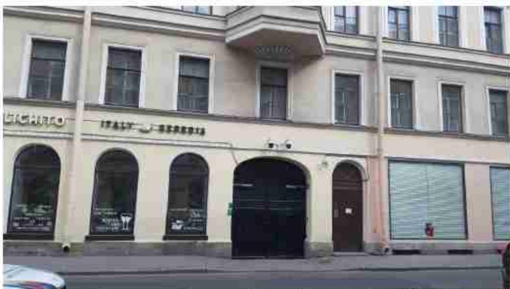
60. Дом Разевича (Вознесенский пр., д. 28, лит. А). Лицевой фасад. Фото мест установки оборудования и кабельных трасс. Штиглиц М.С. 07.05.2024.
