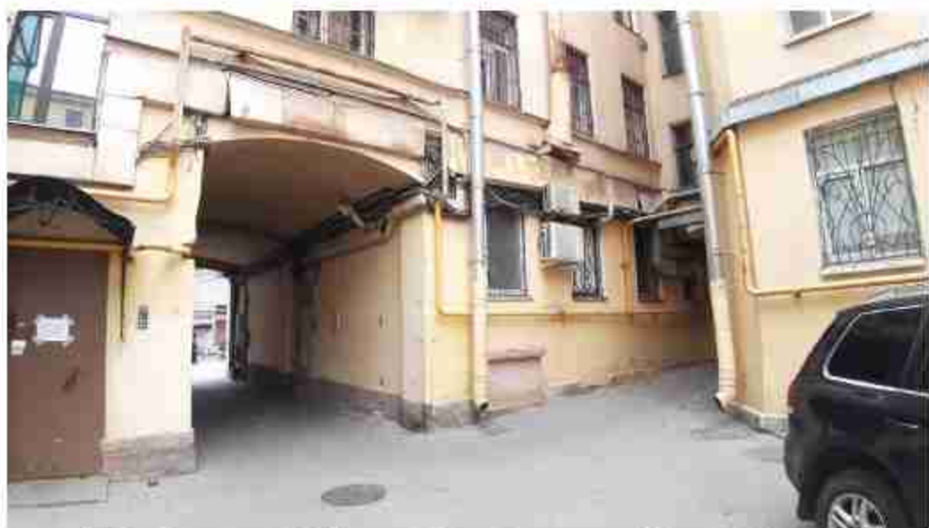
17. Дом Демидовых (А.М. Ушакова) (Малая Садовая ул., д. 3/54, лит. А). Дворовый фасад. Фото мест установки оборудования и кабельных трасс. Штиглиц М.С. 07.05.2024.
