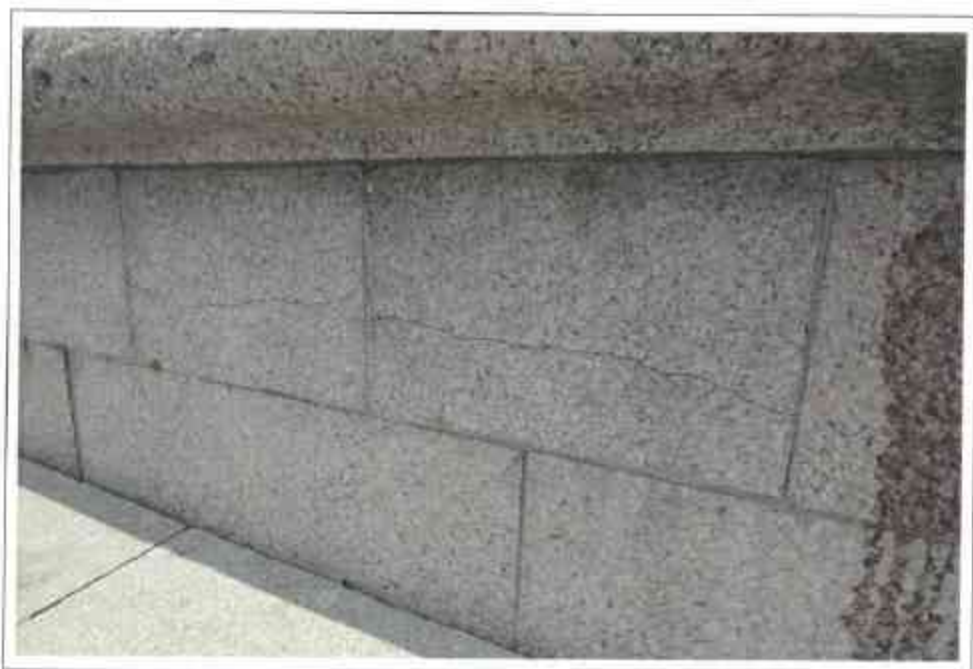
Рис.21. Трещины в плитах облицовки низовой фасадной стенки спуска
