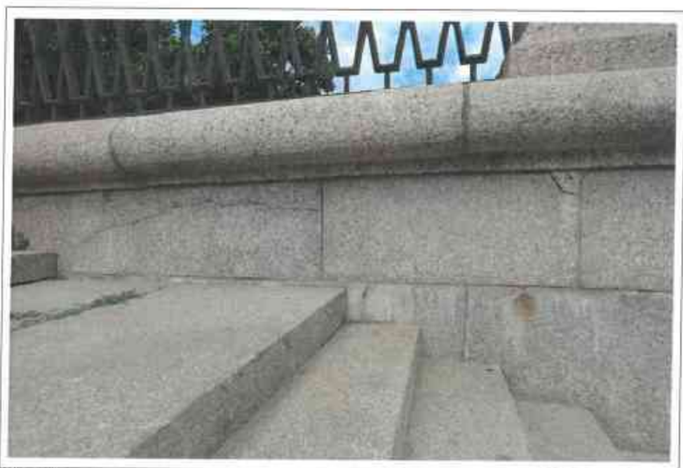
Рис.20. Трещина в плите и скол угла плиты облицовки низовой боковой стенки лестницы
