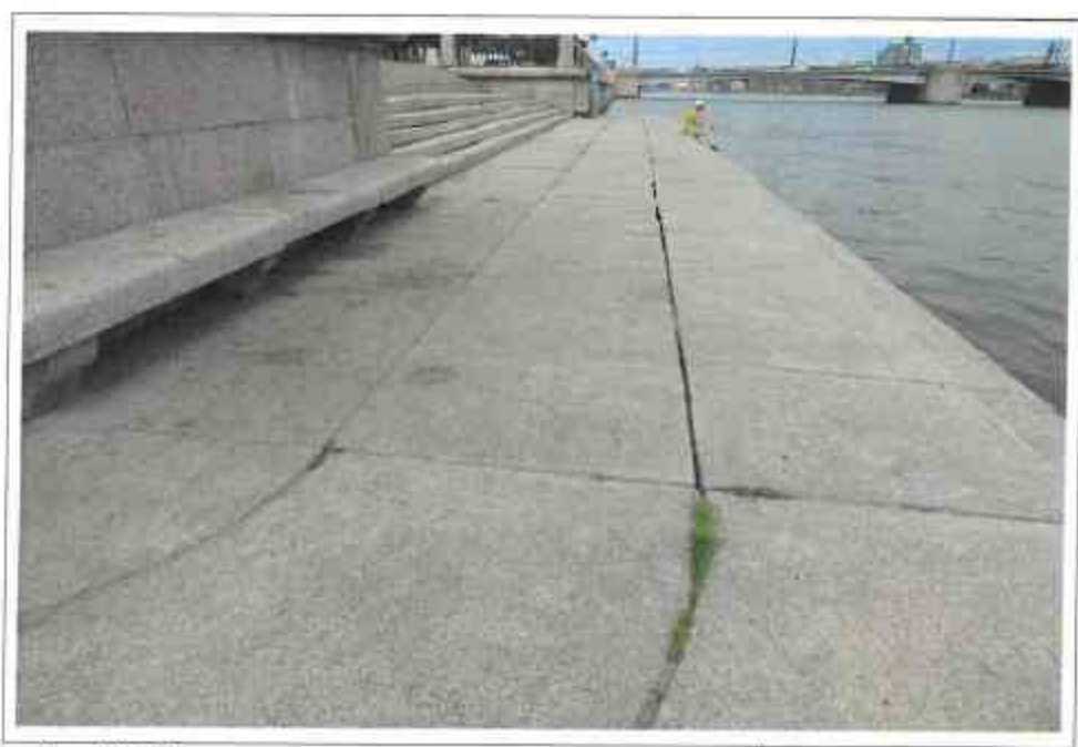
Рис.22. Разрушение расшивки швов плит нижней площадки спуска
