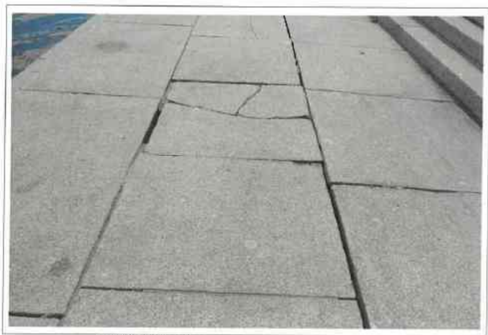
Рис.25. Трещины в плите центрального ряда
