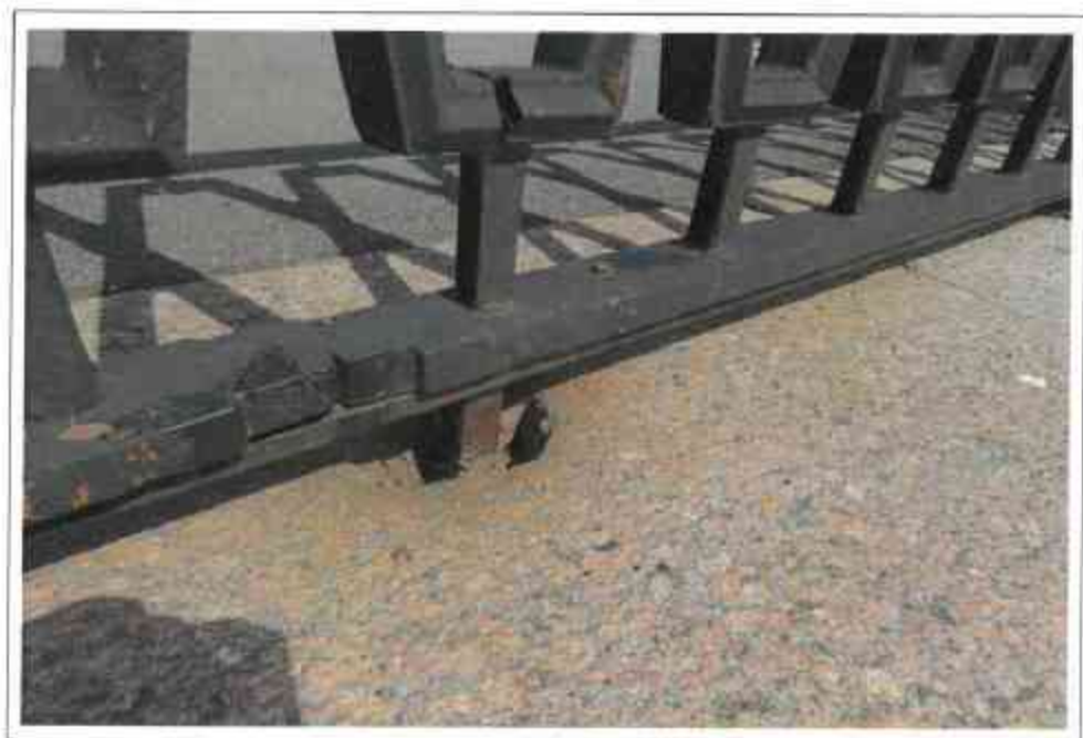
Рис.8. Низовая секция перил. Отсутствие опорных элементов
