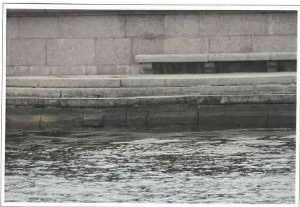
Рис.34. Две плиты облицовки на верхней стороне спуска рассечены вертикальными трещинами
