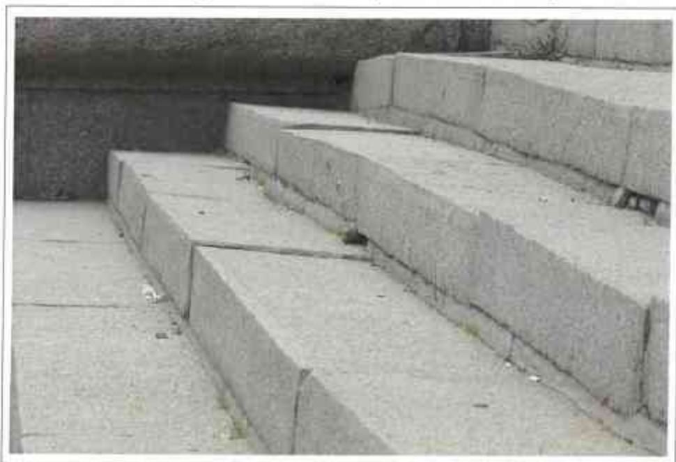
Рис.13. Неравномерная просадка ступеней с верховой стороны лестницы верхнего марша.
