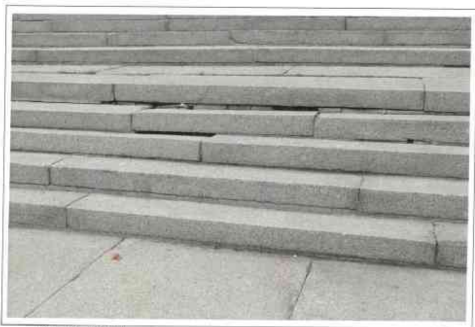
Рис.15. Разрушение расшивки швов, полости под ступенями
