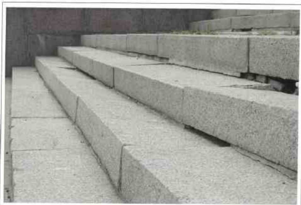
Рис.14. Разрушение расшивки швов, просадка ступеней нижнего марша
