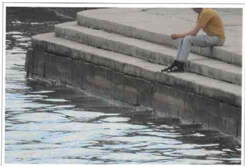
Рис.30. Разрушение расшивки швов, расстройство плит облицовки в уровне воды
