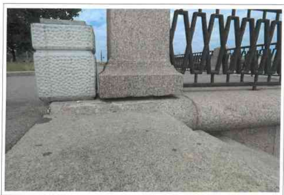
Рис.9. Разрушение цементной подливки под тумбой
