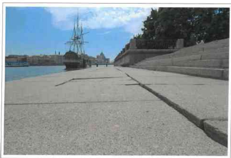
Рис.24. Образование ступени между рядами плит
