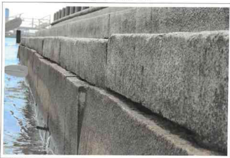
Рис.33. На верхней половине спуска плиты облицовки выпирают в русло
