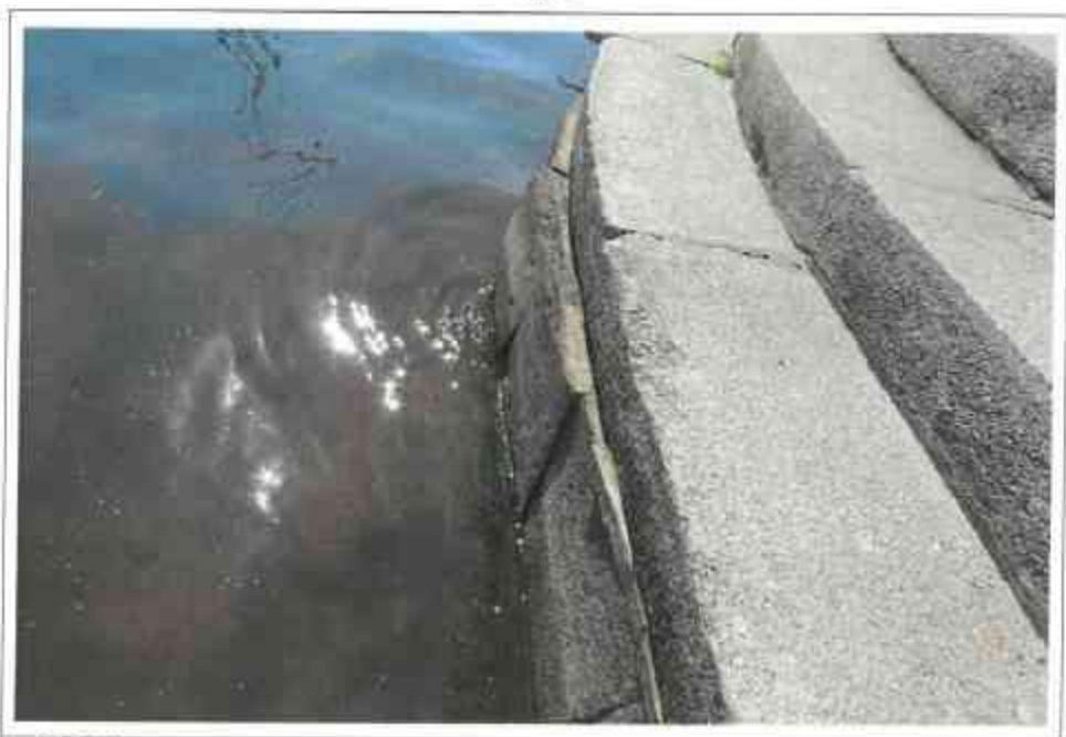
Рис.31. Расстройство плит облицовки на верхнем закруглении площадки
