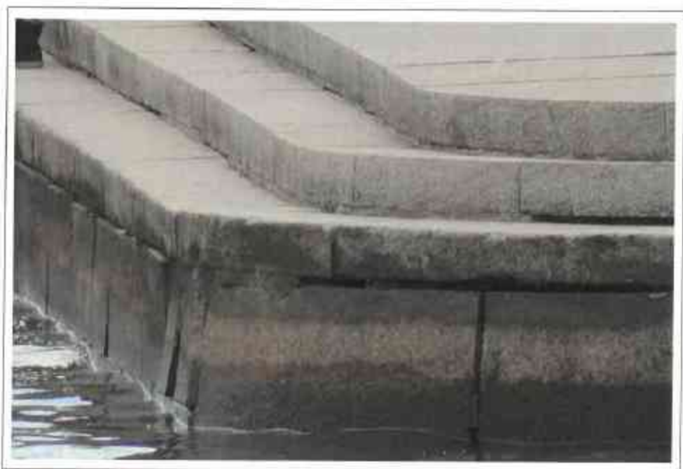
Рис.32. Разрушение расшивки швов, расстройство плит облицовки на низовом закруглении площадки
