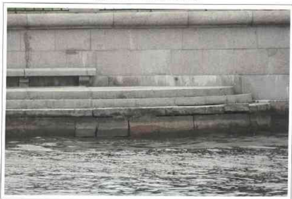
Рис.35. Плита облицовки на нижней стороне спуска рассечена вертикальной трещиной
