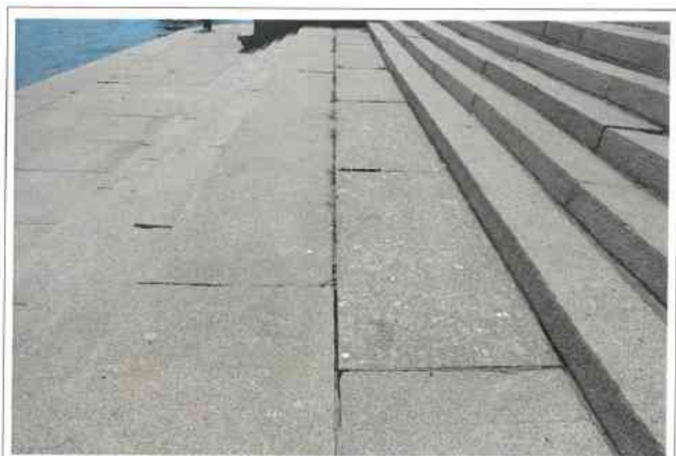
Рис.17. Разрушение расшивки швов плит промежуточной площадки спуска
