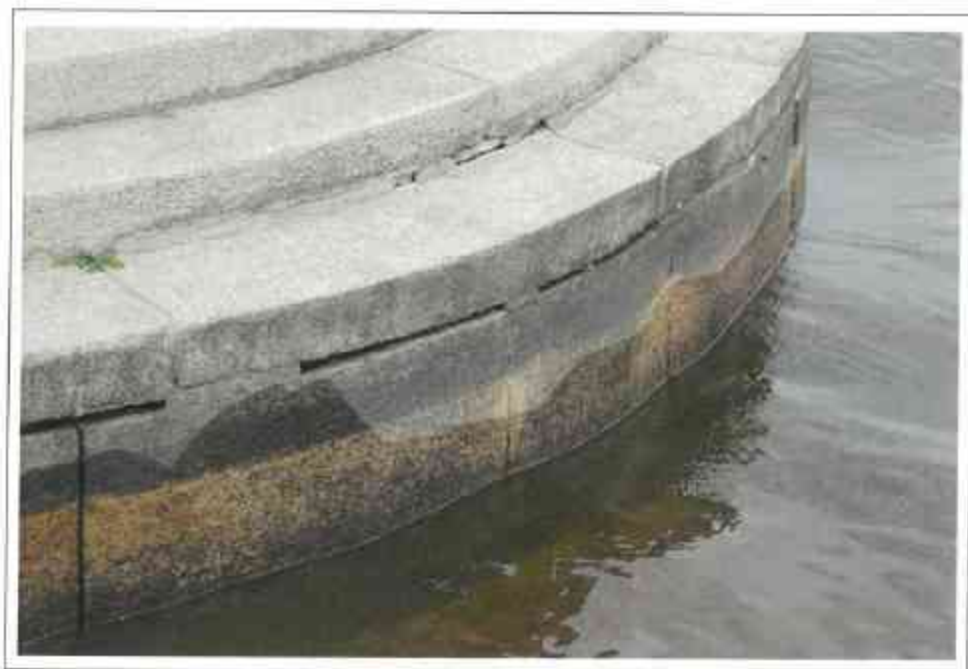
Рис.28. Разрушение расшивки швов нижних ступеней спуска
