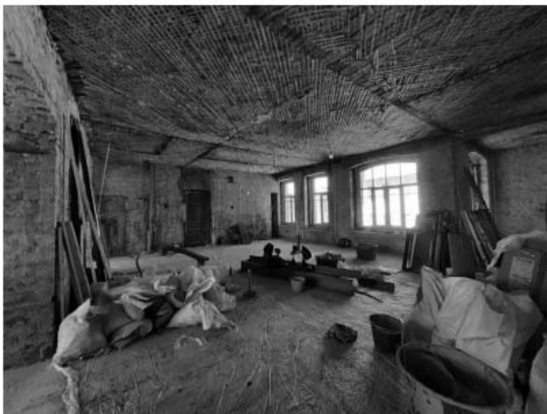
Фото 19 Интерьер квартиры №39 выявленного объекта культурного наследия «Дом Ф.Ф. Шпринга» расположенного по адресу: Санкт-Петербург, пер. Тучков, дом 11/5, литера А (26.09.2022)
