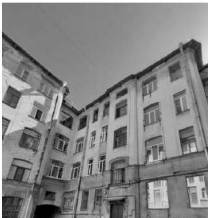
Фото 4 Фрагмент дворового фасада выявленного объекта культурного наследия «Дом Ф.Ф. Шпринга» расположенного по адресу: Санкт-Петербург, пер. Тучков, дом 11/5, литера А (Тучков пер., 11; Волховский пер., 5) (30.05.2022)
