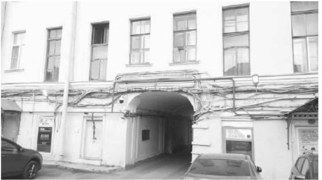
69. Дом Яковлева С.Я. (Гороховая ул., д. 45, лит. А). Дворовый фасад. Фото мест установки оборудования и кабельных трасс. Штиглиц М.С. 07.05.2024.
