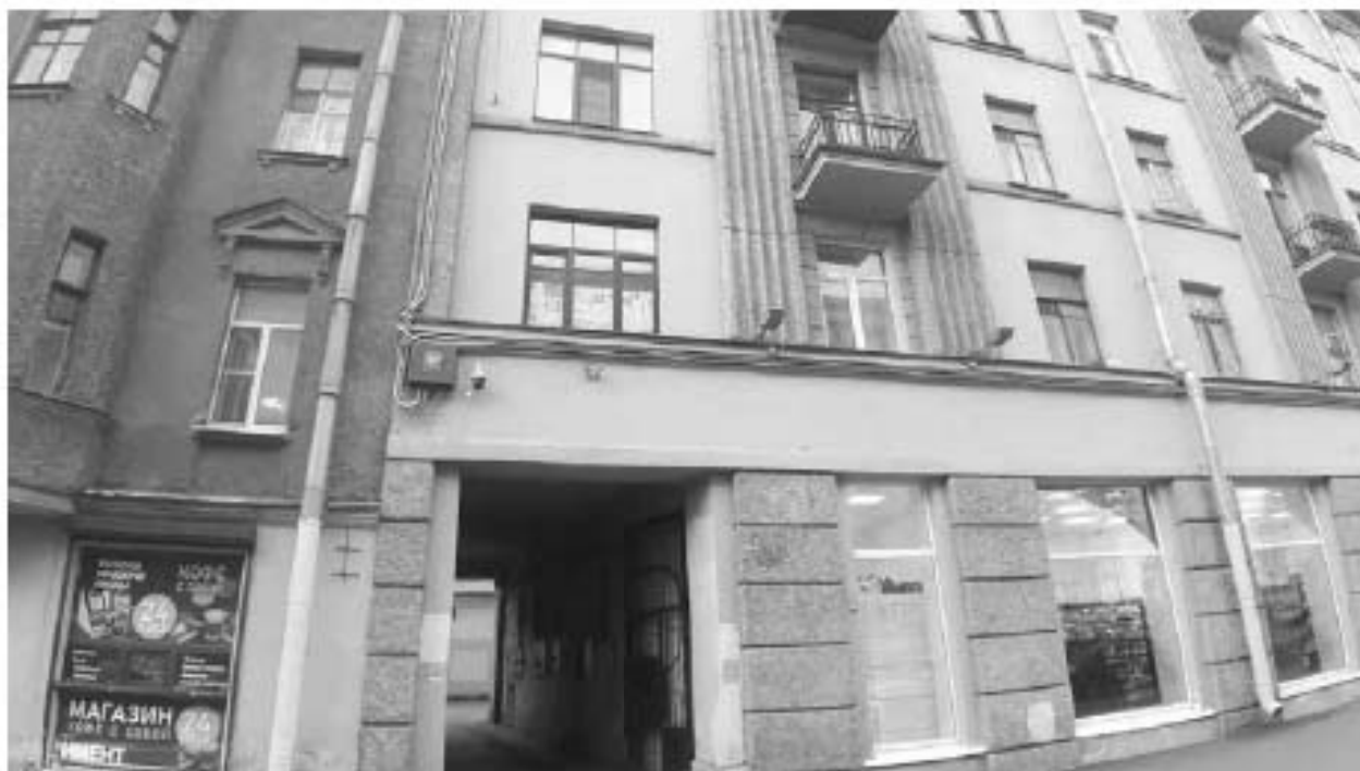
53. Ансамбль жилых домов площади Стачек (3 здания) (Перекопская ул., д. 1, лит. А). Лицевой фасад (фрагмент). Фото мест установки оборудования и кабельных трасс. Штиглиц М.С. 07.05.2024.
