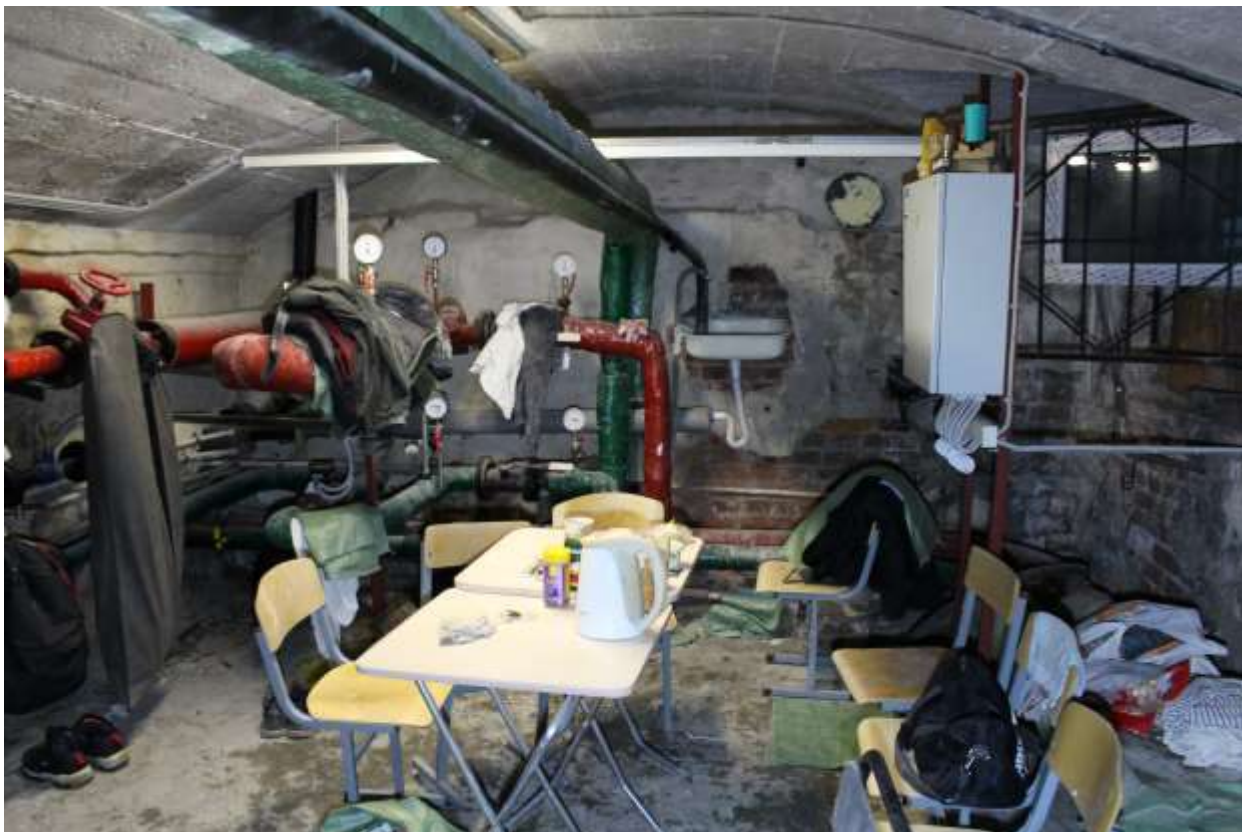
54. Выявленный объект культурного наследия «Городской дом 1-го Василеостровского начального народного училища». Вид на теплоцентр в подвальном помещении.
