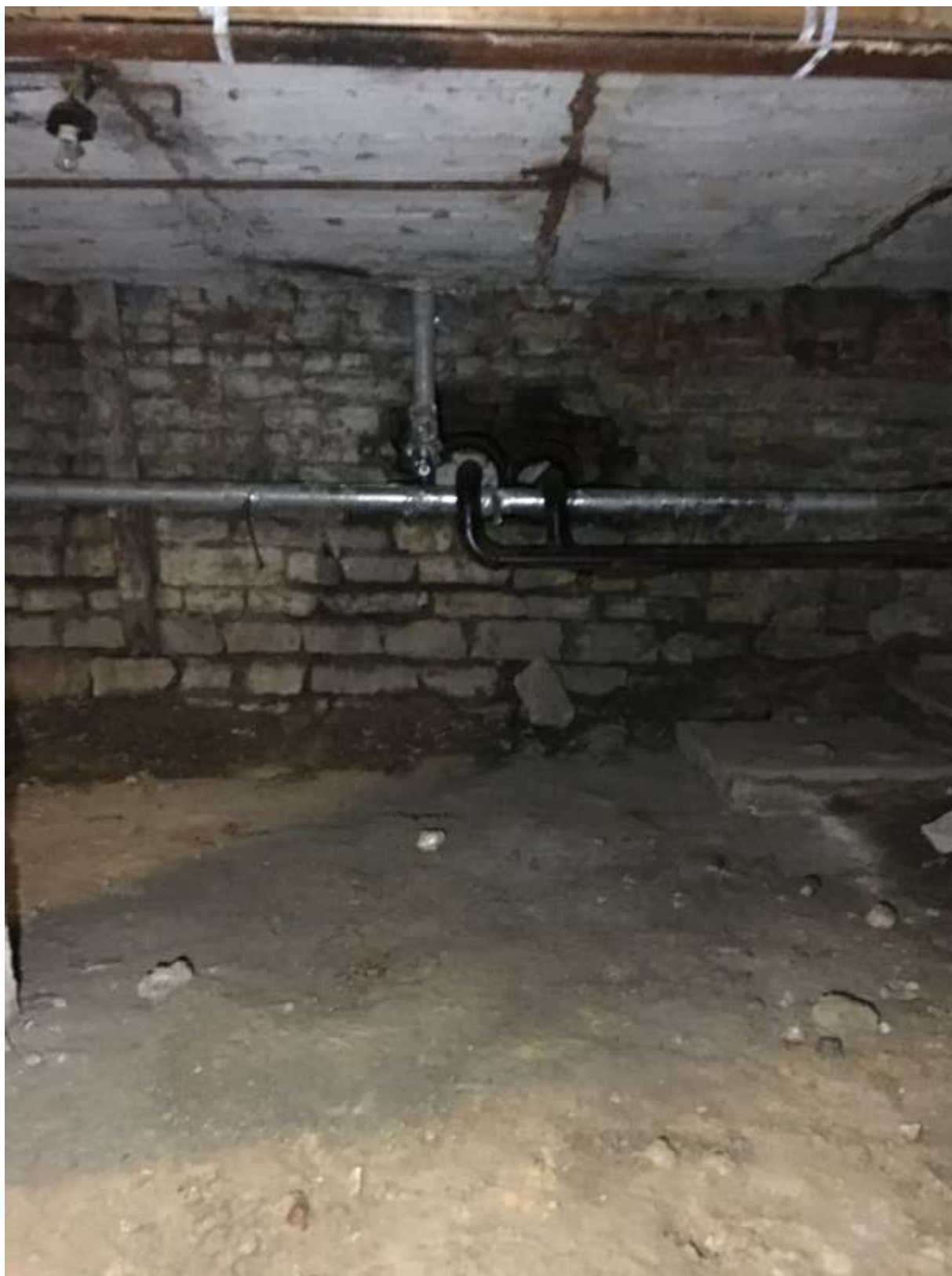
77. Выявленный объект культурного наследия «Богдельня для женщин». Вид на ввод теплосети в подвальном помещении.
