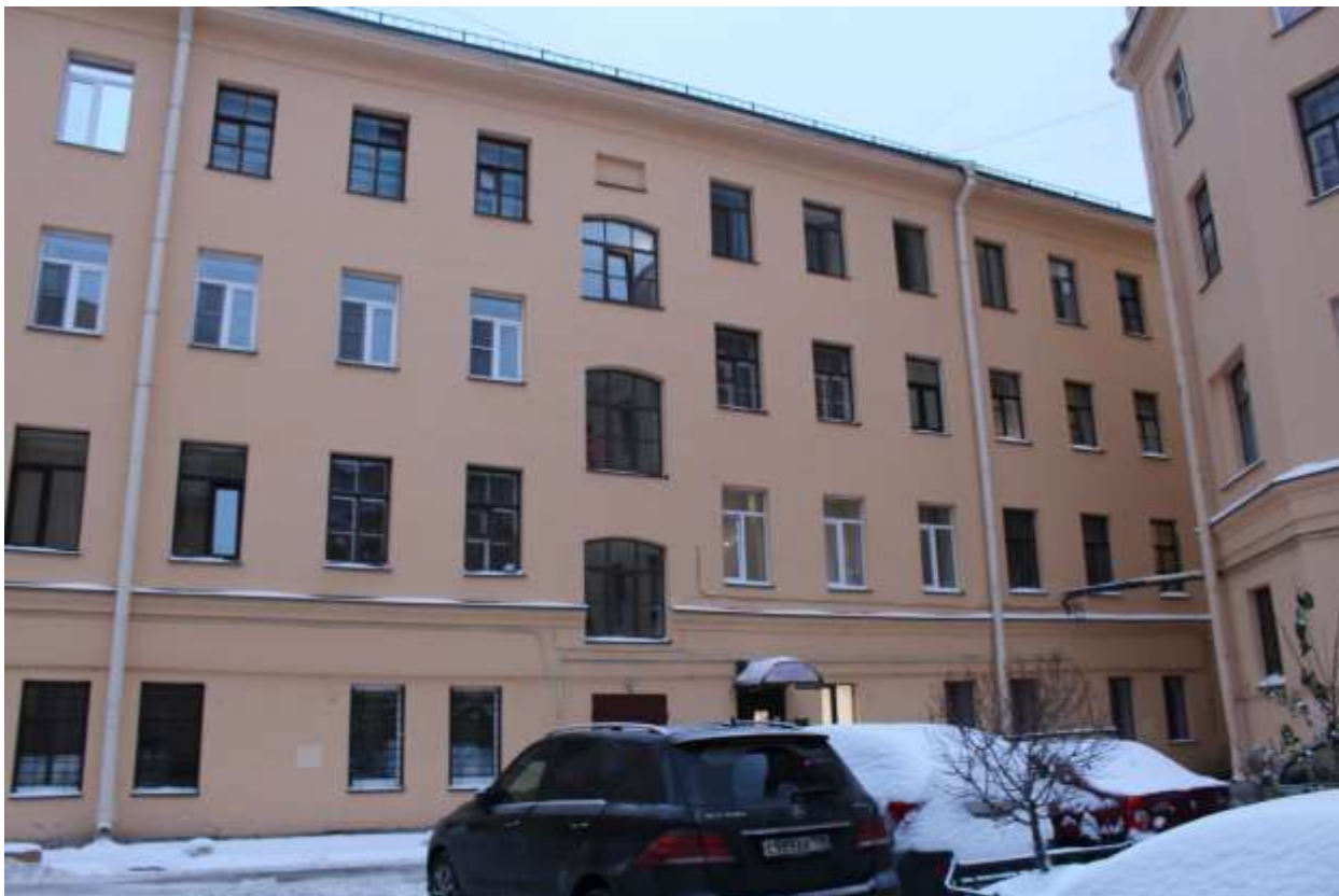
35. Выявленный объект культурного наследия «Дом В.А. Квасникова». Вид на фасад отдельно стоящего дворового корпуса.
