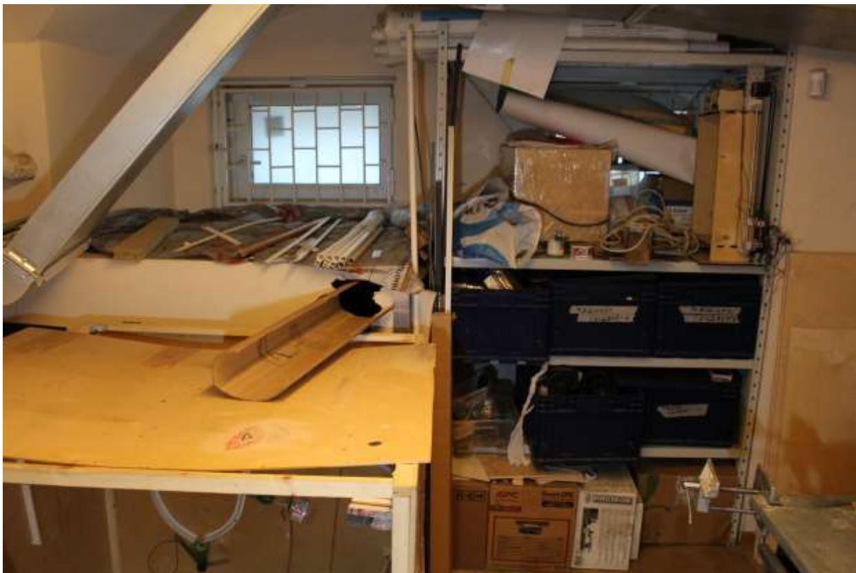
50. Выявленный объект культурного наследия «Городской дом 1-го Василеостровского начального народного училища». Подвальное помещение, вид на ввод теплосети.
