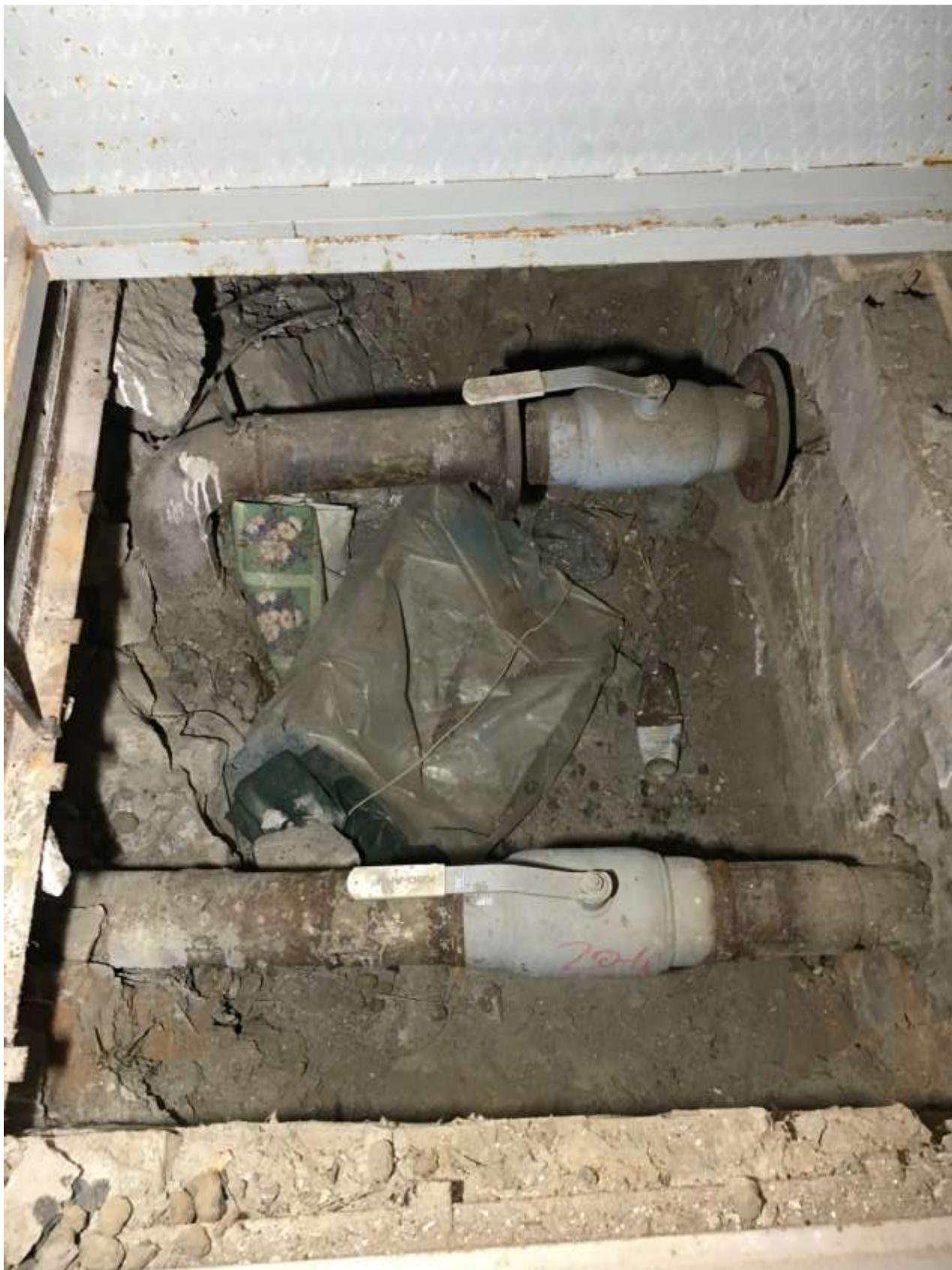
39. Выявленный объект культурного наследия «Дом В.А. Квасникова». Вид на трубы теплосети в подпольном канале отдельно стоящего дворового корпуса.
