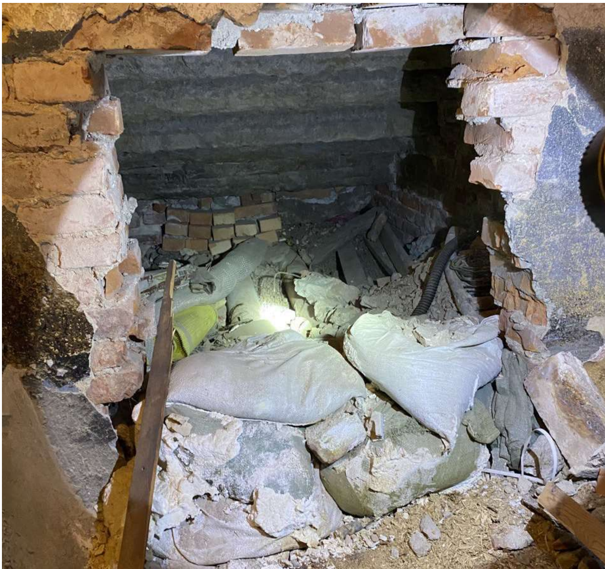
40. Выявленный объект культурного наследия «Дом В.А. Квасникова». Вид на трубы теплосети в подпольном канале лицевого корпуса.
