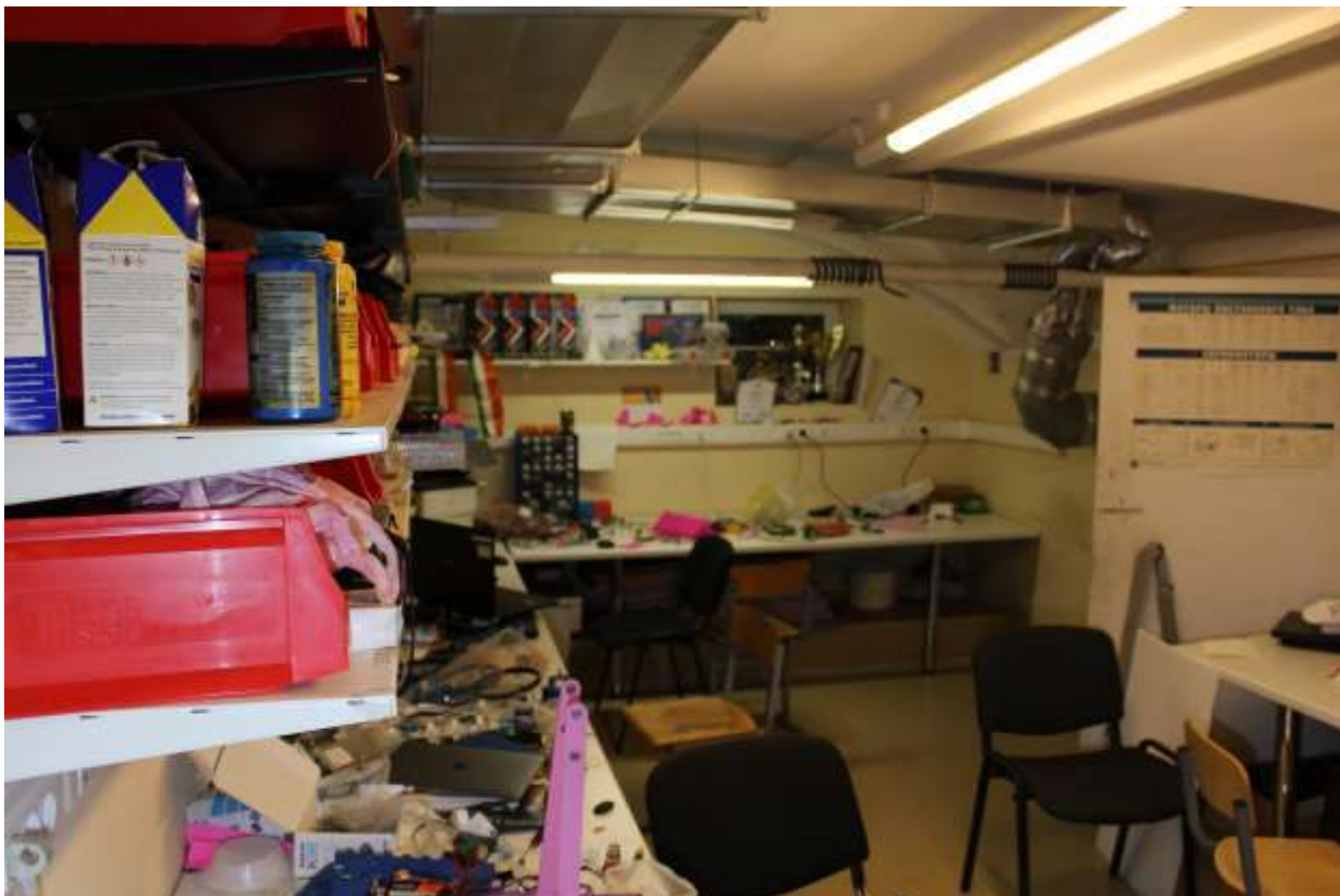
52. Выявленный объект культурного наследия «Городской дом 1-го Василеостровского начального народного училища». Вид на зашитые трубы теплосети в подвальном помещении.
