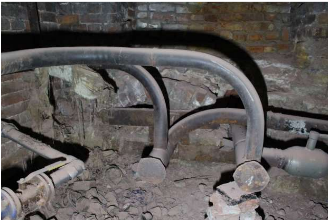
69. Выявленный объект культурного наследия «Дом Г.А. Хаймовича (при фабрике жестяных изделий)». Вид на ввод теплосети в подвале четырехэтажного с мансардой корпуса.
