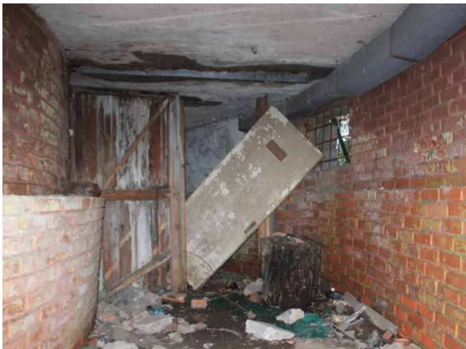
40. Объект культурного наследия регионального значения «Жилой дом», входящий в состав объекта культурного наследия регионального значения «Дача Сиверса (Кировский городок)», расположенный по адресу: Санкт-Петербург, Кировский район, пр. Стачек, д. 172, литера А. Помещение подвала. Фрагмент интерьера.
