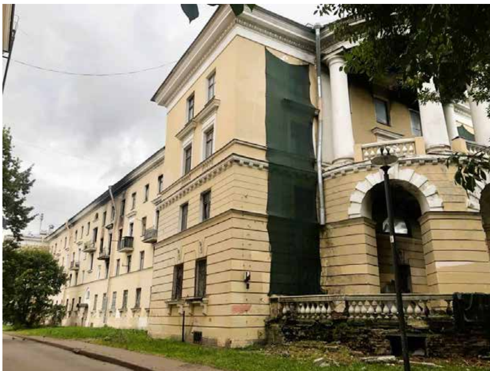
16. Объект культурного наследия регионального значения «Жилой дом», входящий в состав объекта культурного наследия регионального значения «Дача Сиверса (Кировский городок)», расположенный по адресу: Санкт-Петербург, Кировский район, пр. Стачек, д. 172, литера А. Общий вид в направлении Ленинского проспекта. Дворовый и северо-западный фасады.
