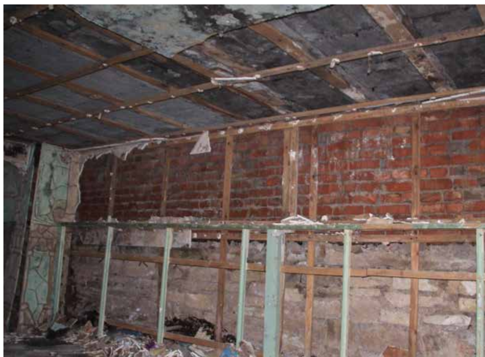
42. Объект культурного наследия регионального значения «Жилой дом», входящий в состав объекта культурного наследия регионального значения «Дача Сиверса (Кировский городок)», расположенный по адресу: Санкт-Петербург, Кировский район, пр. Стачек, д. 172, литера А. Помещение подвала. Фрагмент интерьера.
