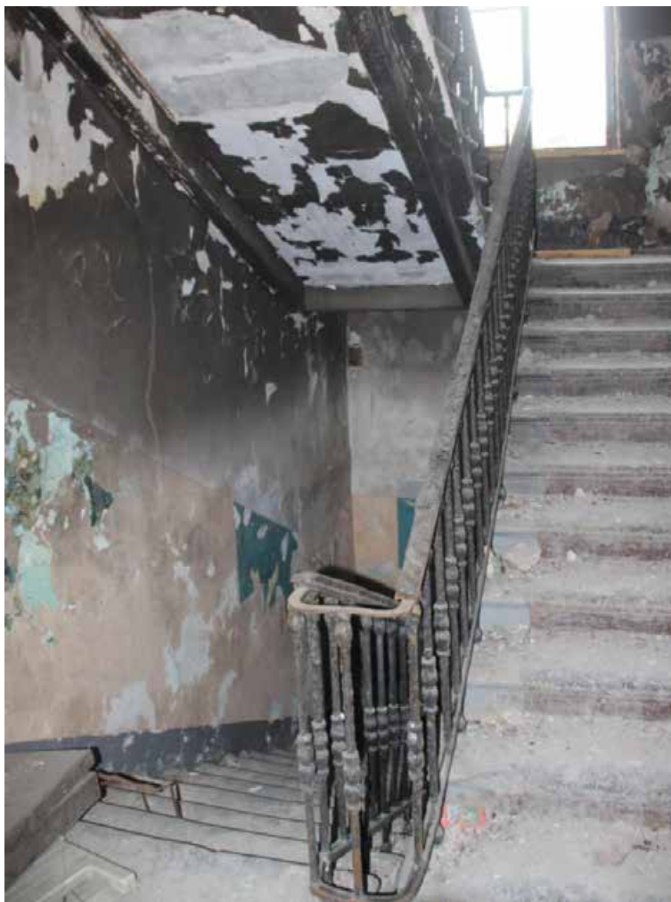
24. Объект культурного наследия регионального значения «Жилой дом», входящий в состав объекта культурного наследия регионального значения «Дача Сиверса (Кировский городок)», расположенный по адресу: Санкт-Петербург, Кировский район, пр. Стачек, д. 172, литера А. Вид лестничной клетки в уровне второго этажа.
