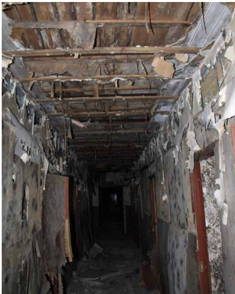
46. Объект культурного наследия регионального значения «Жилой дом», входящий в состав объекта культурного наследия регионального значения «Дача Сиверса (Кировский городок)», расположенный по адресу: Санкт-Петербург, Кировский район, пр. Стачек, д. 172, литера А. Помещение первого этажа. Коридор. Фрагмент интерьера.
