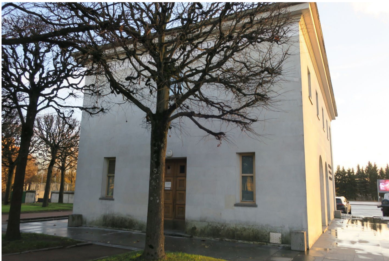
7. Северо-восточный фасад восточного павильона объекта культурного наследия федерального значения «Кладбище Пискаревское», расположенного по адресу: г. Санкт-Петербург, пр. Непокоренных, д. 72 литера А. 15.10.2021
