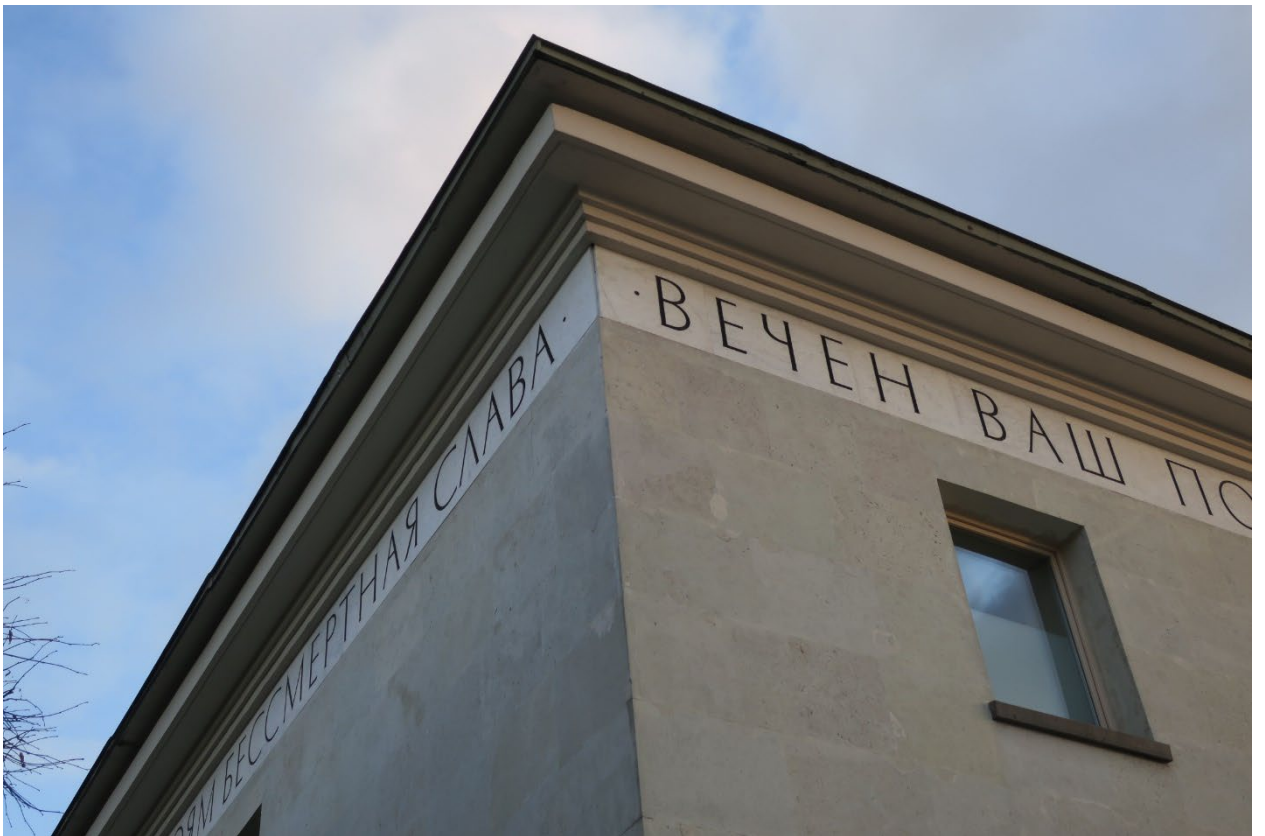
8. Карнизный свес восточного павильона объекта культурного наследия федерального значения «Кладбище Пискаревское», расположенного по адресу: г. Санкт-Петербург, пр. Непокоренных, д. 72 литера А. 15.10.2021
