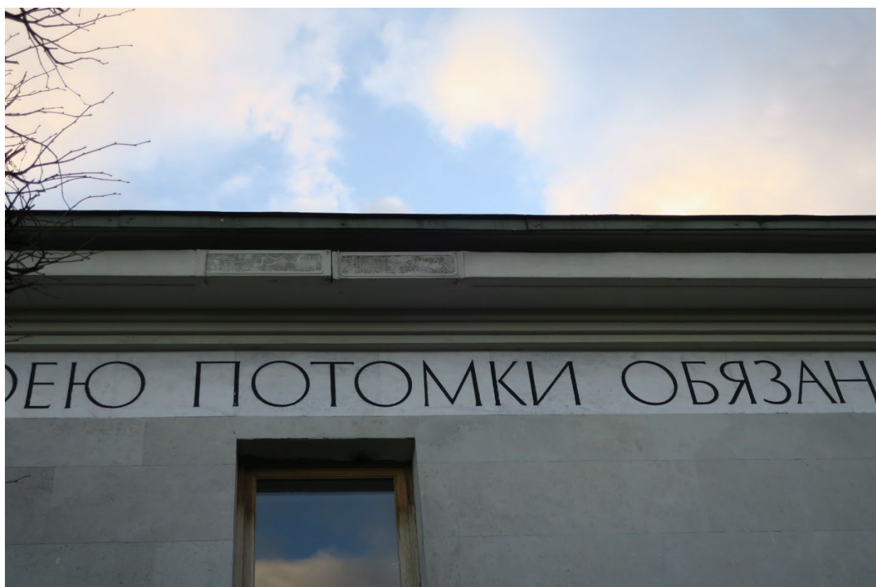
16. Карнизный свес северо-восточного фасада западного павильона объекта культурного наследия федерального значения «Кладбище Пискаревское», расположенного по адресу: г. Санкт-Петербург, пр. Непокоренных, д. 72 литера А. 15.10.2021
