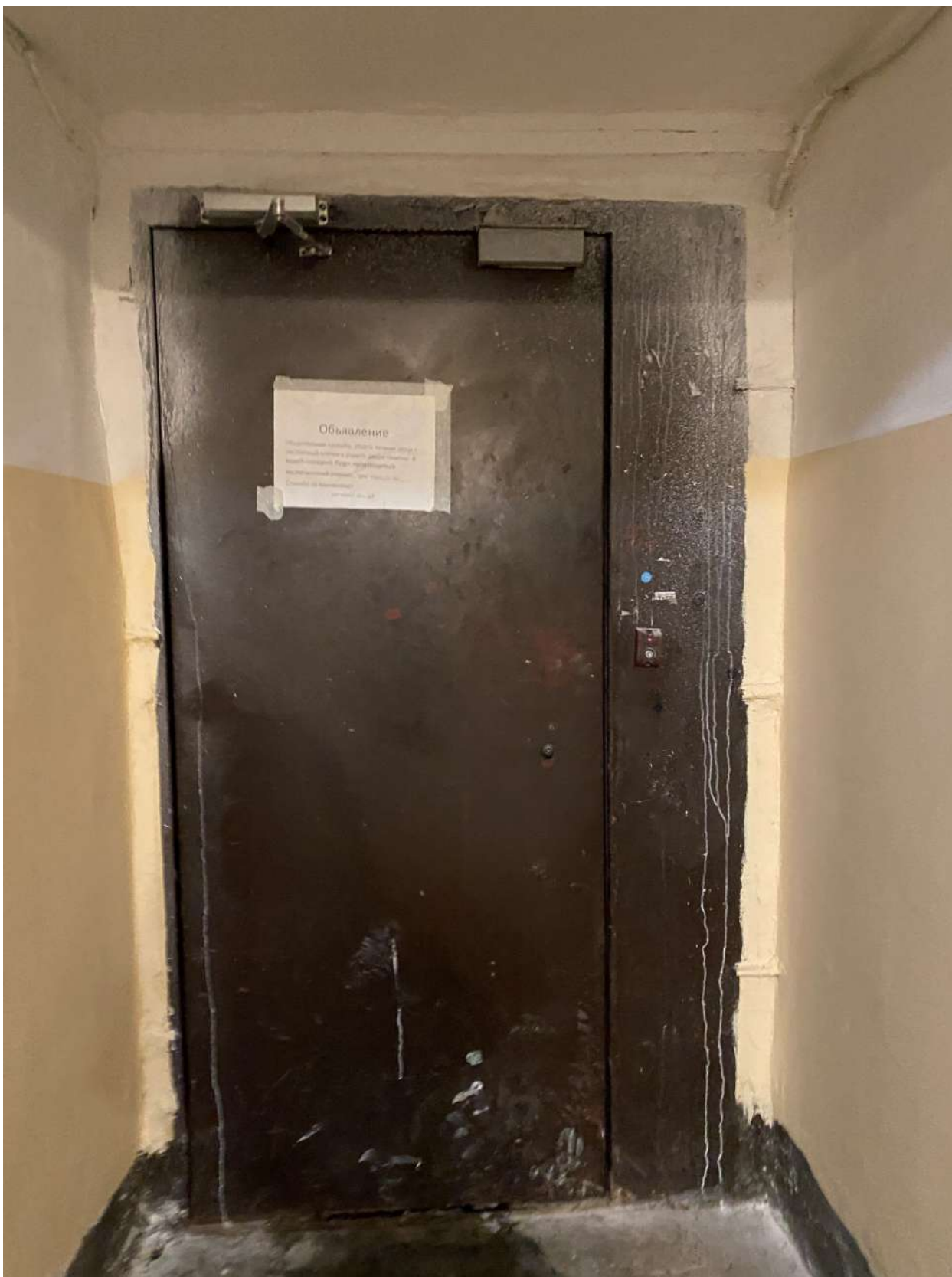
Фото 20. Вид на дверное заполнение из парадной, ведущей в квартиру № 21, расположенную в части объекта культурного наследия
