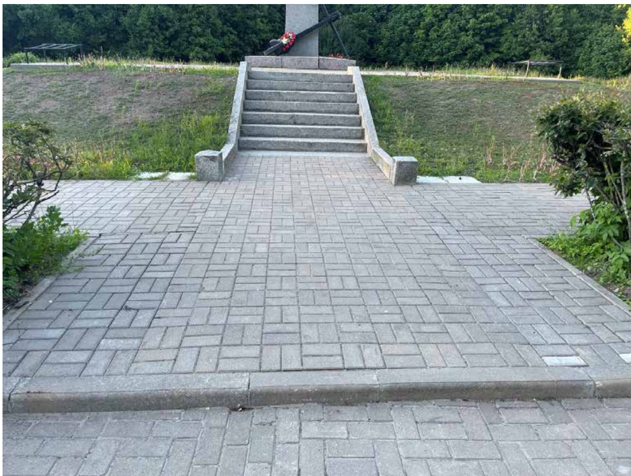
3. Гранитная лестница объекта культурного наследия регионального значения «Братская могила жителей г. Кронштадта, погибших в годы Великой Отечественной войны 1941-1945 гг.», расположенного по адресу: Санкт-Петербург, г. Кронштадт, около Русского кладбища. 01.06.2024
