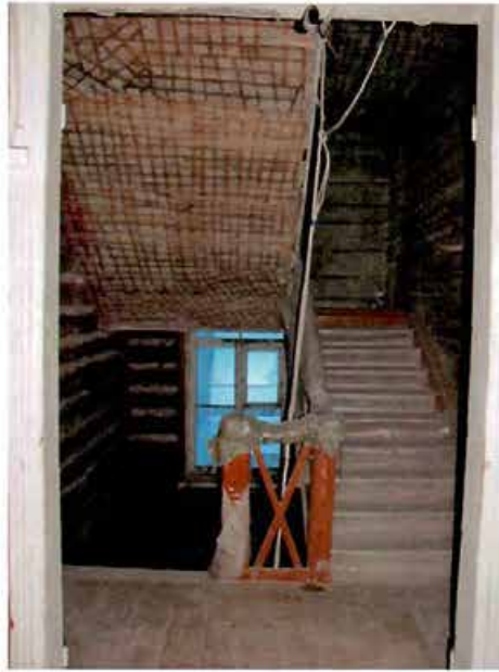
9.«Здание церковно-приходской школы и приюта церкви Апостола Петра». Второй этаж. Историческая лестница.
