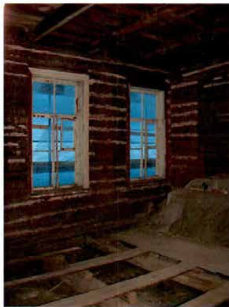
8.«Здание церковно-приходской школы и приюта церкви Апостола Петра». Первый этаж. Помещение. Фрагмент.
