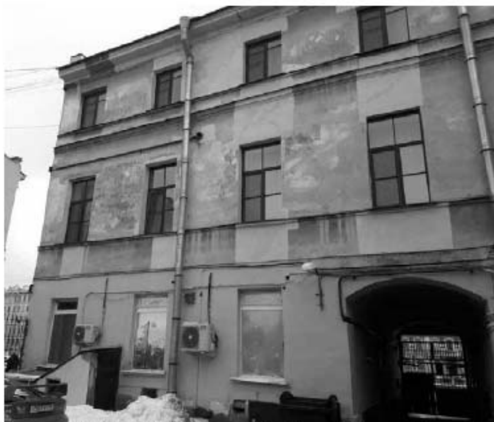
23. Дома Полторацкой С.М. (три). Фонтанки реки наб., д. 97, лит. А. Дворовый фасад. Фото мест установки оборудования и кабельных трасс. Штиглиц М.С. 06.03.2022.
