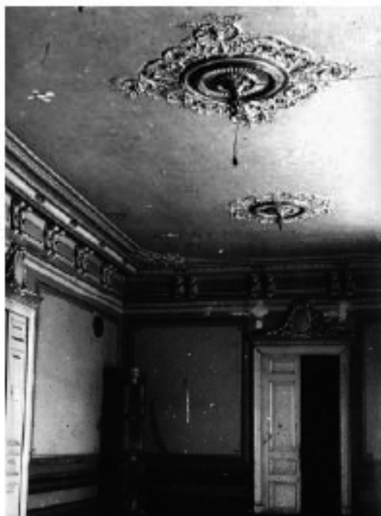
67. Главный корпус. Фрагмент интерьера большого зала приемной на 2 этаже. Фото 1946 г. Архив КГИОП.
