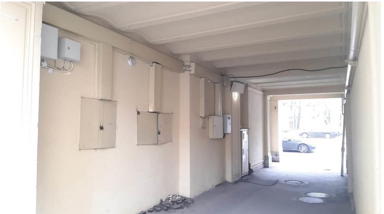
32. Дом В.Н. Зеленина. Фото мест установки оборудования и кабельных трасс. (Лесной пр., д. 3, лит. А). Штиглиц М.С. 18.04.2024.
