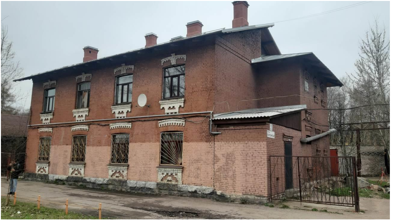
35. Комплекс построек железнодорожной станции «Кушелевка» (4 здания)» (Политехническая ул., д. 1, корп. 3, лит. Б). Южный фасад. Штиглиц М.С. 18.04.2024.
