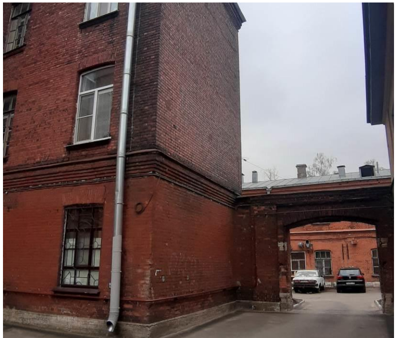
6. Казармы со службой (Академика Лебедева ул., д. 20, лит. А). Дворовые фасады. Фото мест установки оборудования и кабельных трасс. Штиглиц М.С. 18.04.2024.
