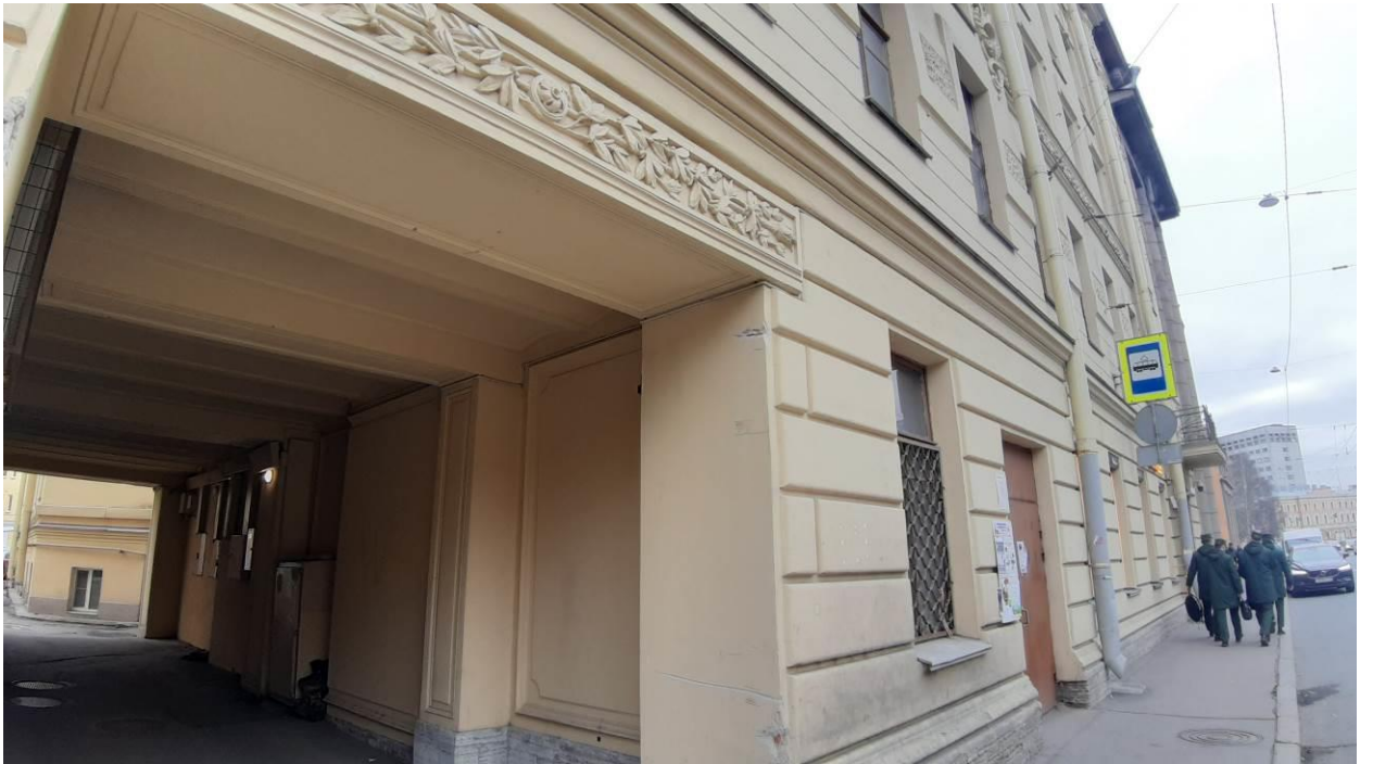
33. Дом В.Н. Зеленина (Лесной пр., д. 3, лит. А). Фрагмент лицевого фасада. Фото мест установки оборудования и кабельных трасс. Штиглиц М.С. 18.04.2024.
