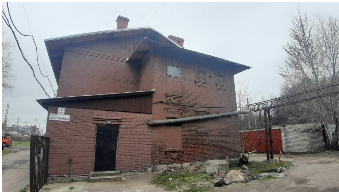
37. Комплекс построек железнодорожной станции «Кушелевка» (4 здания)» (Политехническая ул., д. 1, корп. 3, лит. Б). Торцевой фасад. Фрагмент лицевого фасада. Фото мест установки оборудования и кабельных трасс. Штиглиц М.С. 18.04.2024.
