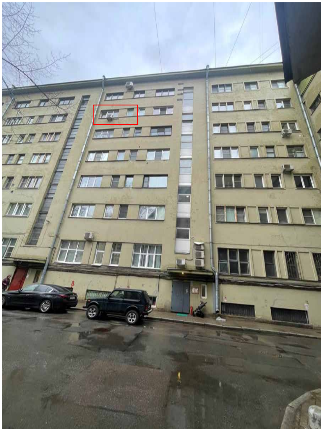
29. Вид на дворовой фасад объекта культурного наследия регионального значения «Дом-коммуна Общества бывших политкаторжан и ссыльнопоселенцев», расположенного по адресу: Санкт-Петербург, Троицкая площадь Петроградской стороны, дом 1, литера А (Санкт-Петербург, Троицкая пл., дом 1, литера А) и окна квартиры 20;
